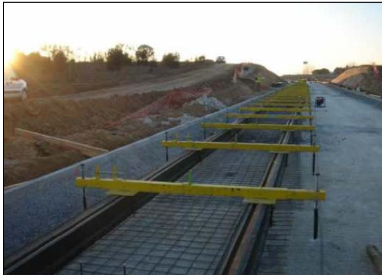
Figura 2.19. Fijación de los carriles junto con sus enchaquetados para el posterior vertido del hormigón de recubrimiento. Fuente: [24]
