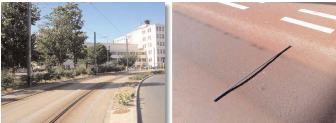
Figura 2.42. Roderas en una plataforma reservada con pavimento de asfalto.
