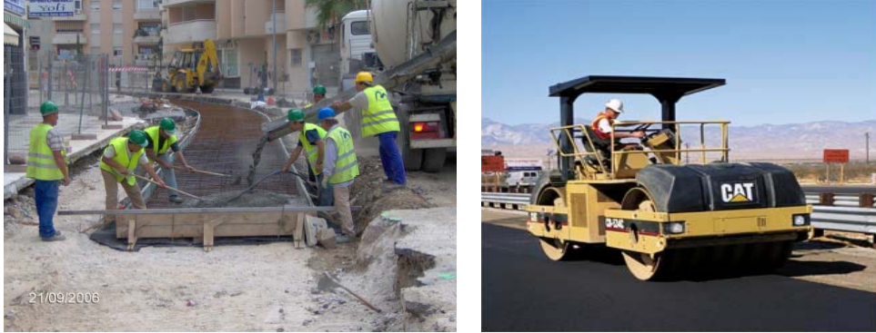
Figura 1.6. Ejecución de la losa armada de base frente a compactación de una capa bituminosa en carretera. Fuente: Elaboración propia a partir de diversas fuentes anónimas
