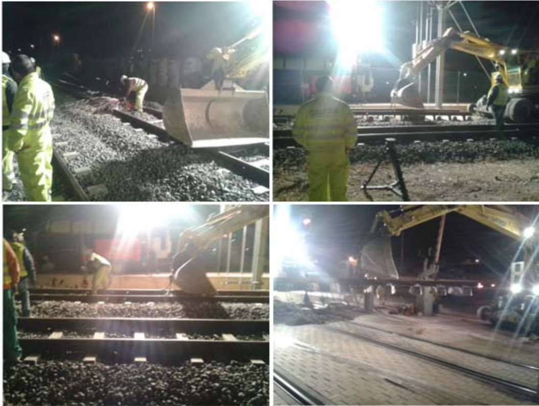
Figura I.7. Cortes previos en los emparrillados y retirada de la zona de actuación.
