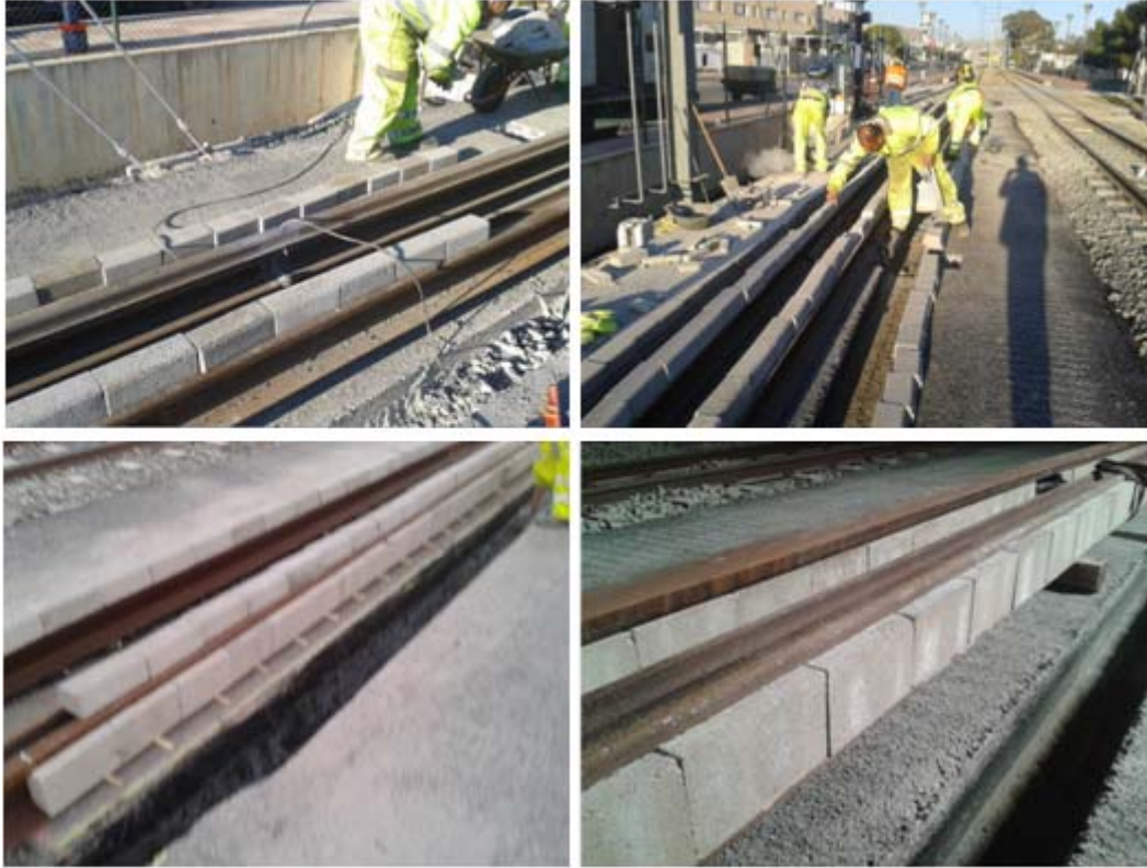
Figura I.18. Colocación de los adoquines sobre el alma del carril previo a su fijación y embebido. Fuente: Elaboración propia
