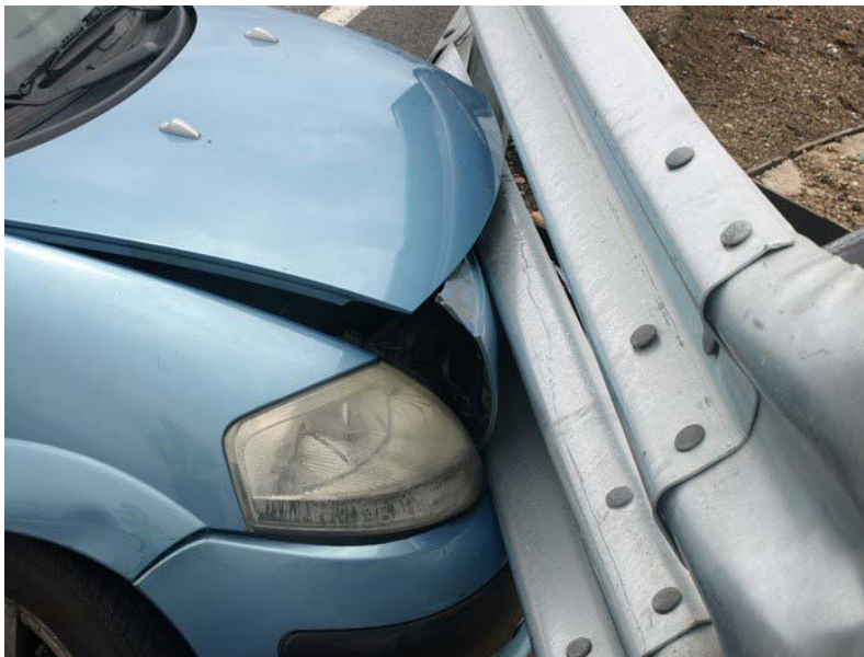
Figura 3. Imagen de barrera de seguridad en carretera tras sufrir un impacto. Fuente: www.circulaseguro.com
