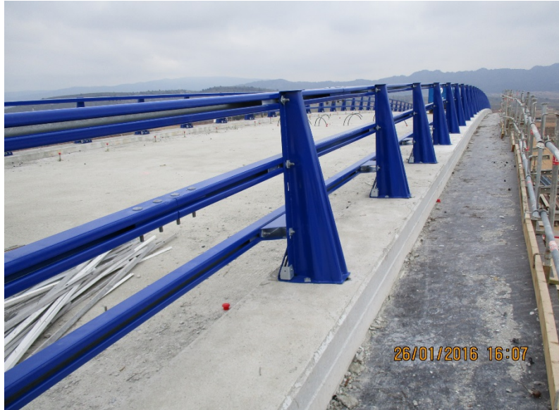
Figura 2. Imagen de un pretil en puente en el tramo de la Autovía A-33 a su paso por Yecla (Murcia). Fuente: Elaboración propia.
