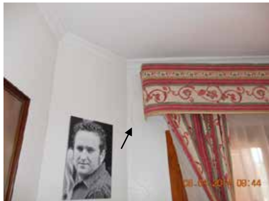
Fotografía 235. Fisura tomada en abril. No se aprecian diferencias.
