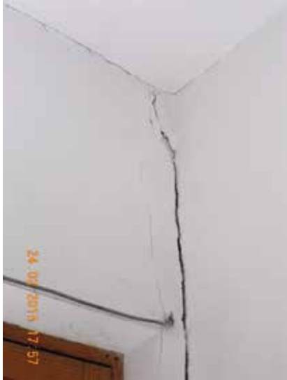
Fotografía 62. Misma grieta que la fachada que ha atravesado el muro.
