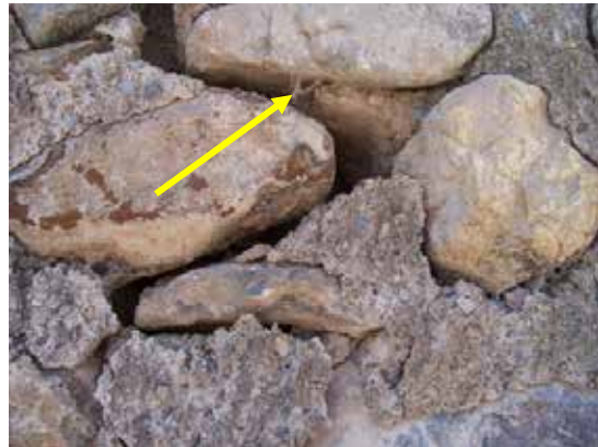
Fotografía 452. Cavidades con presencia de telarañas, lo que manifiesta su antigüedad.
