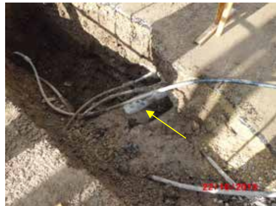
Fotografía 462. Había una red de riego en la zona afectada.
