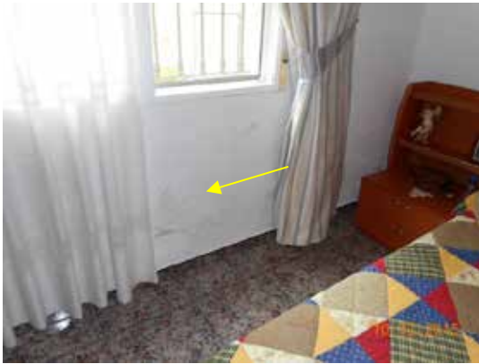
Fotografía 614. Humedades por capilaridad en las partes bajas de los paramentos verticales del dormitorio 3.
