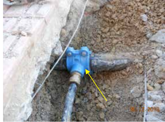
Fotografía 514. Collarín nuevo adecuado para ese tipo de instalación.
