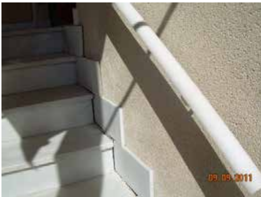
Fotografía 427. Se aprecia que las juntas entre piezas de mármol fueron enmasilladas anteriormente.
