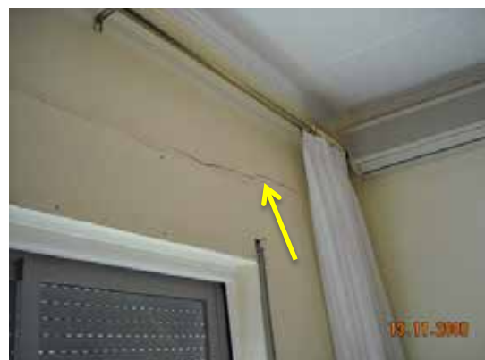
Fotografía 371. Grieta horizontal sobre el dintel de la ventana.
