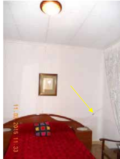
Fotografía 146. Grietas en la medianera de la vivienda.
