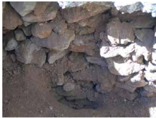
Fotografía 434. Se observan los daños producidos en la cimentación.
