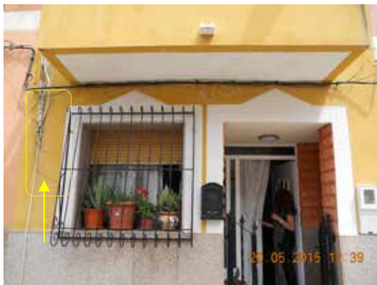
Fotografía 574. Fisuras en la fachada.
