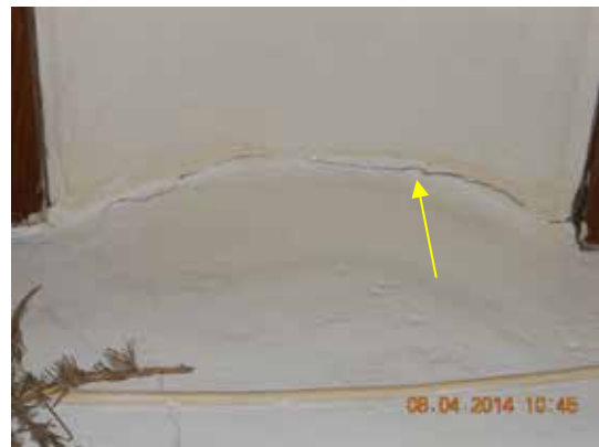
Fotografía 564. Detalle de la grieta previamente reparada.
