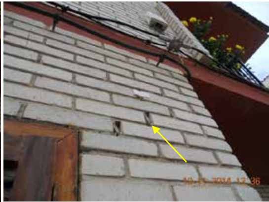
Fotografía 217. Misma grieta tomada el 13 de octubre donde se aprecia que ha aumentado considerablemente.
