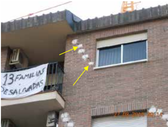
Fotografía 170. Grieta última planta con testigo del día 21/8/2014 sin fracturar.
