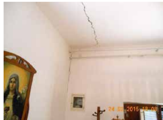
Fotografía 73. Grieta en una de las habitaciones.
