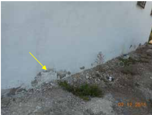
Fotografía 308. Las eflorescencias indican que todavía a restos de humedad en el terreno bajo la vivienda.
