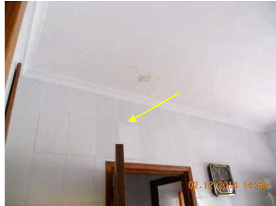
Fotografía 268. Azulejos desprendidos por la fuerza de compresión que ha sufrido el tabique de la cocina.
