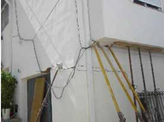
Fotografía 381. Aspecto de las grietas del ángulo del edificio el 27 de julio de 2005.
