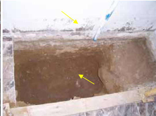
Fotografía 41. El terreno se aprecia seco y no hay lavado de finos ni descalce de zapata.
