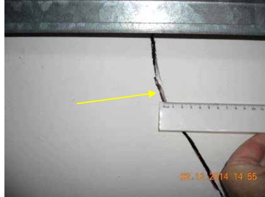
Fotografía 258. En la parte baja del tabique alcanza la fisura valores de 5 a 6 mm.
