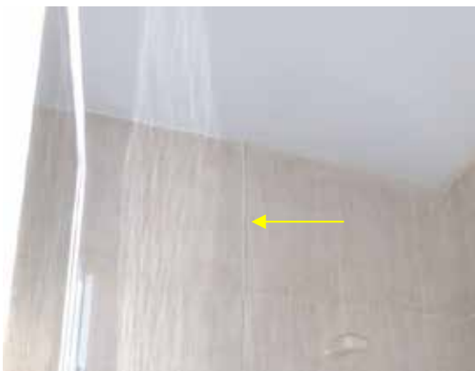
Fotografía 530. Junta abierta entre azulejos en el aseo planta baja, tomada 11/02/2016.
