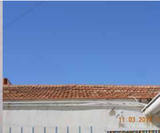
Fotografía 91. La cubierta es muy irregular.
