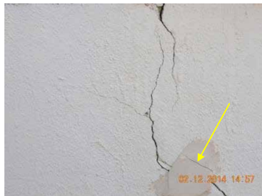
Fotografía 262. El testigo en esta fisura se ha fracturado.
