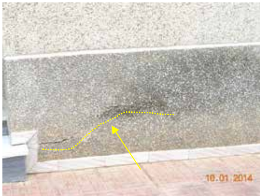
Fotografía 466. Detalle grieta oblicua parte derecha
