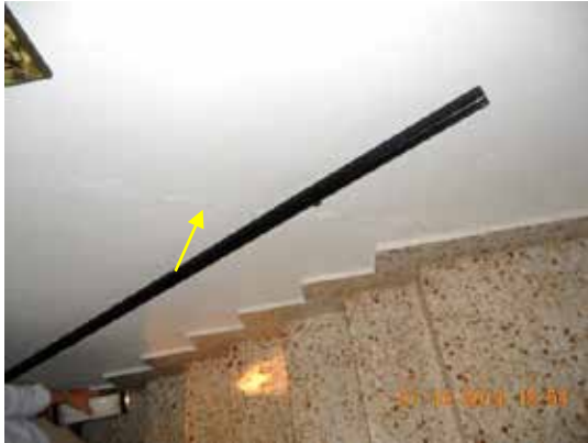
Fotografía 240. Fisura horizontal en el hueco de las escaleras.
