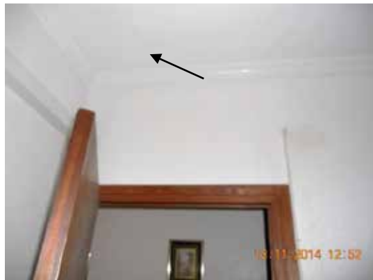
Fotografía 285. Leve fisura sobre el forjado de la cubierta
