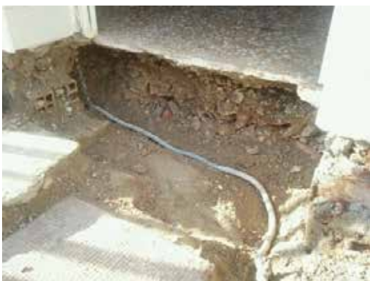
Fotografía 327. Se aprecia la acometida de plomo y la deficiente cimentación.
