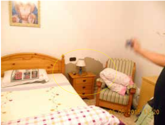
Fotografía 590. Desprendimiento de la pintura motivado por el exceso de humedad.
