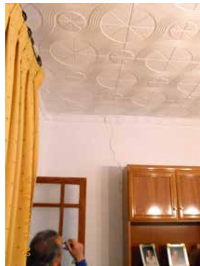
Fotografía 125. Esta grieta indica dirección opuesta a las otras con dirección hacia el interior de la vivienda.
