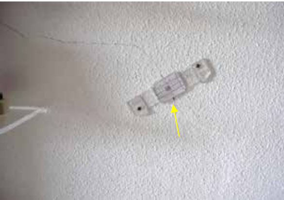
Fotografía 211. Fisura leve con fisurómetro.
