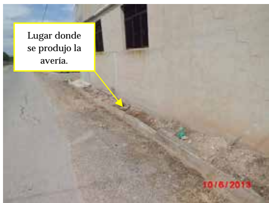
Fotografía 388. Vista lateral de la nave, donde se aprecia la zona de la avería.
