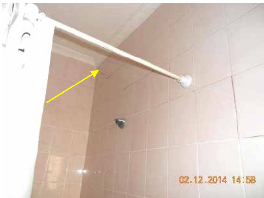
Fotografía 265. Fisuras en el aseo de la planta baja que han generado la rotura de algunos azulejos.
