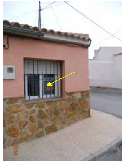
Fotografía 458. Humedades en la fachada suroeste.
