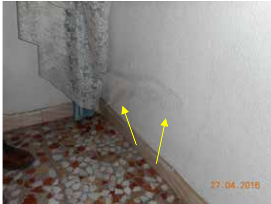
Fotografía 484. Humedades en la parte baja del muro de carga.
