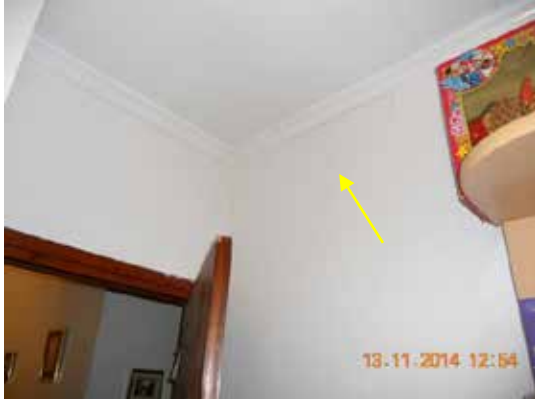
Fotografía 288. La fisura oblicua en otra habitación de la 1º planta.
