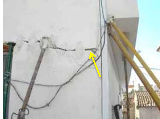
Fotografía 382. Aspecto de las mismas grietas el 16 de septiembre de 2005.
