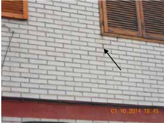
Fotografía 220. Fisura en ventana de la primera planta.
