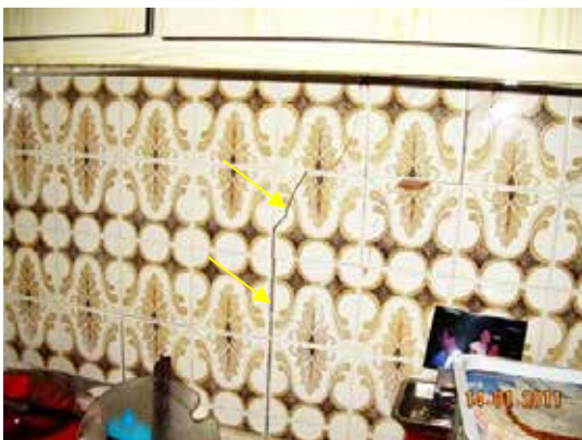
Fotografía 34. Se aprecian grietas en el paramento de plaquetas cerámicas de la cocina.
