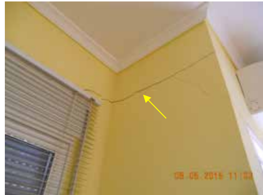
Fotografía 502. Fisura paralela al dintel de la puerta y la ventana.
