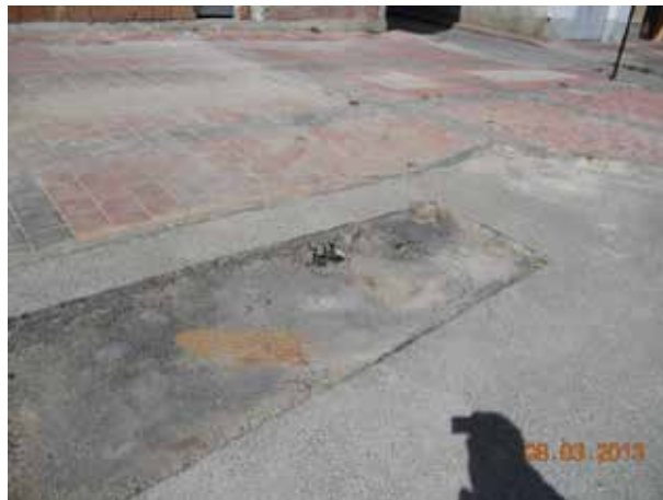
Fotografía 11. Hundimiento de una zanja una vez asfaltada. Desnivel de unos 15 cm.
