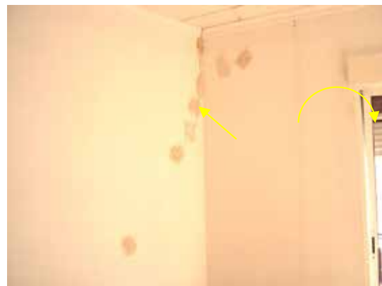
Fotografía 539. Testigo fisurado y puerta descajada, tomada 25/04/2016.
