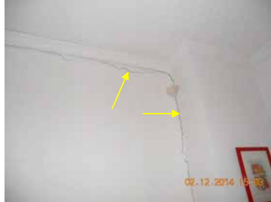
Fotografía 276. Las fisuras recorren todo el paño.
