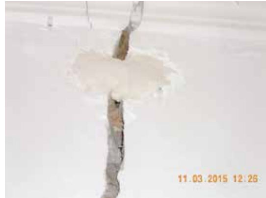
Fotografía 87. Testigos de la grieta más importante.
