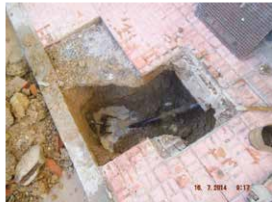
Fotografía 342. Avería en acometida localizada en la acometida domiciliar del inmueble en la esquina del edificio.
