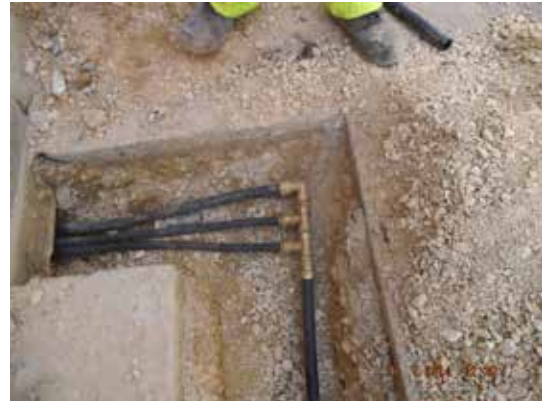
Fotografía 340. Acometidas respuestas del edificio contiguo.
