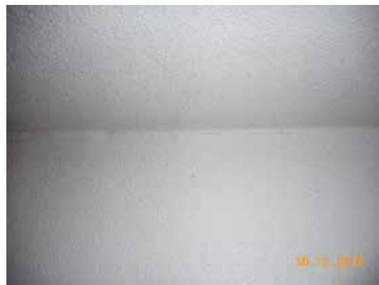
Fotografía 613. Fisura en el encuentro de dos paramentos.
