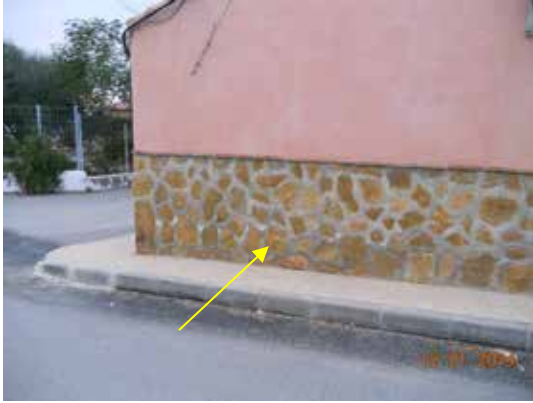
Fotografía 459. Humedades en fachada sureste.
