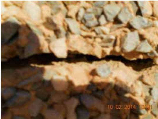
Fotografía 474. No se observa en las fisuras indicios de que sean muy antiguas.
