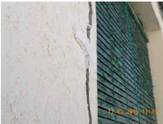
Fotografía 84. El testigo de la Fotografía 73 se ha despegado en un extremo.
