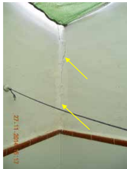
Fotografía 298. La fisura casi vertical indica separación de la unión entre los dos paramentos.
