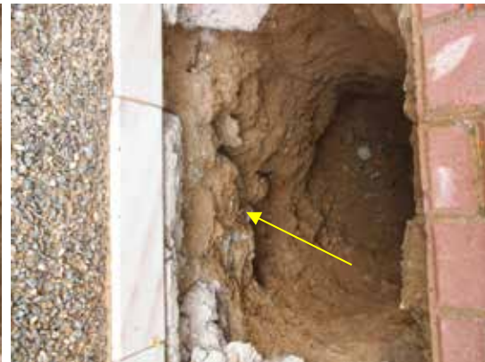
Fotografía 477. Ausencia de hormigón y mortero.
