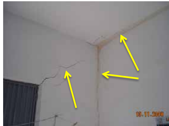
Fotografía 362. Grietas oblicuas en el marco de la puerta, y horizontales y verticales en los encuentros de los muros.
