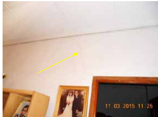
Fotografía 136. Grieta oblicua que parte del hueco de la puerta.
