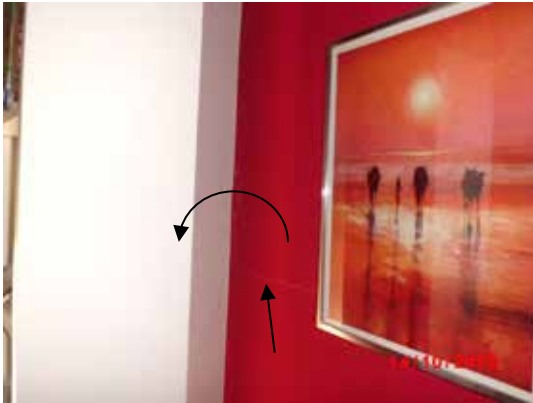
Fotografía 546. Leve fisura inclinada en la planta baja.
