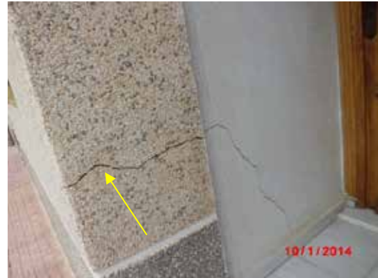
Fotografía 465. Parte inferior pilar izquierdo y mocheta
