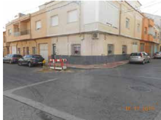
Fotografía 360. Situación de la 4ª avería.
