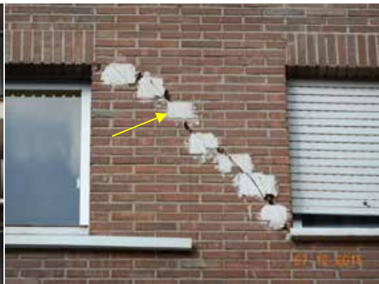
Fotografía 177. Misma fotografía de la grieta anterior tomada 07/12/2015 con el testigo de 21/8/2014 sin fracturar.
