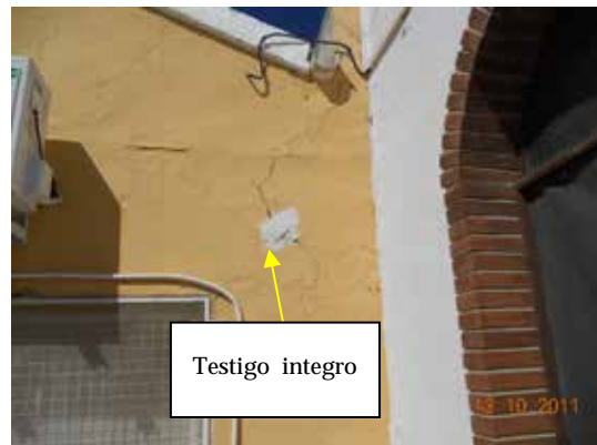
Fotografía 622. Testigos instalado el 4/10/2011.
