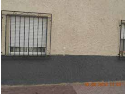
Fotografía 333. Detalle grietas calle Panay
