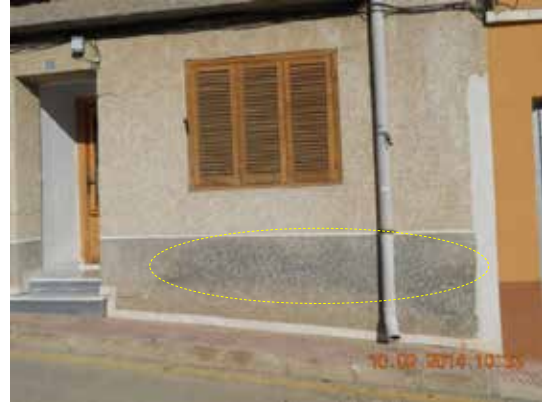
Fotografía 471. La bajante de las aguas pluviales de la cubierta desemboca junto a la fachada.
