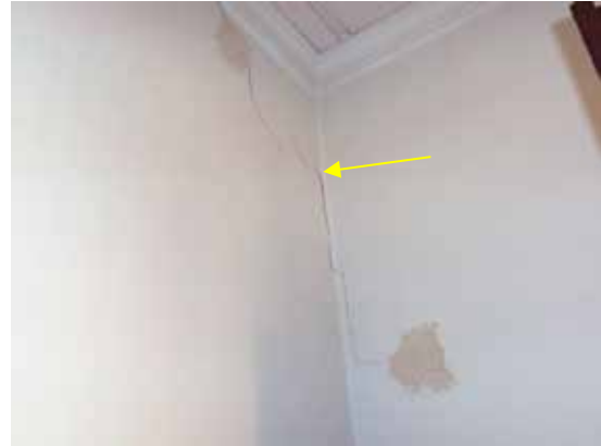
Fotografía 545. Fisura vertical con testigos sin fisurar, tomada 25/04/2016.
