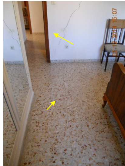
Fotografía 278. Las fisuras en el suelo y en la pared.
