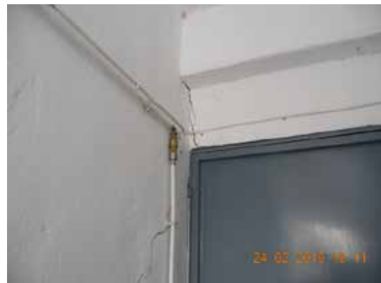
Fotografía 77. Grieta en la puerta auxiliar que da a la calle Parricas.
