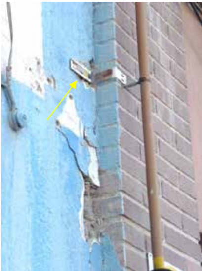
Fotografía 204. Fisurómetro instalado en la junta entre edificios.
