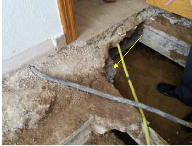
Fotografía 516. Detalle de la cimentación del pilar con geometría irregular.
