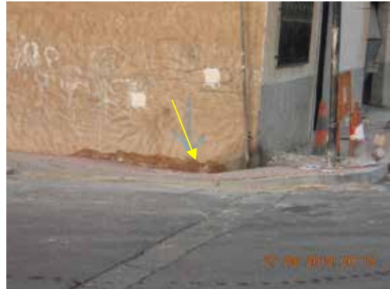
Fotografía 155. Socavón en la acera de la esquina del edificio.
