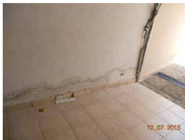
Fotografía 6. Manchas de humedad y desprendimiento de piezas de rodapiés por una fuga de abastecimiento.
