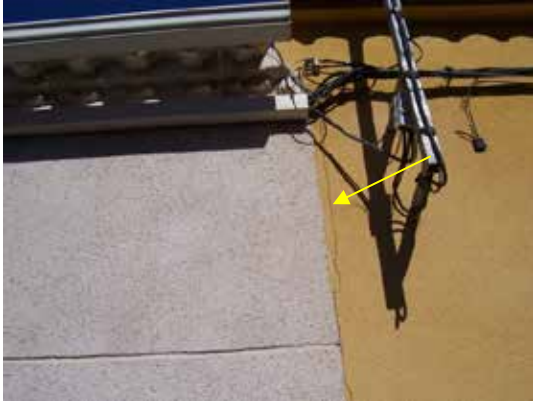
Fotografía 95. Fisuras en la unión entre las edificaciones que comparten medianera.
