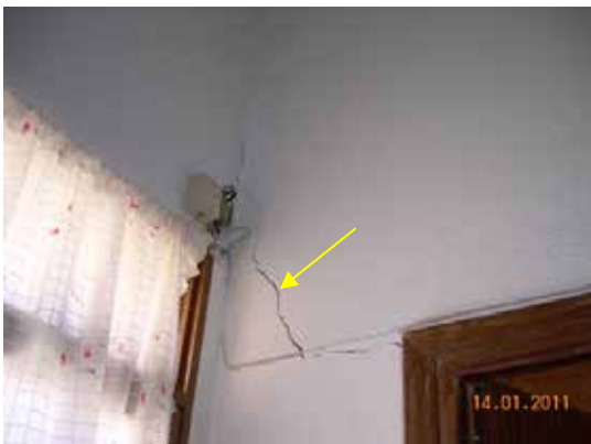
Fotografía 26. Detalle de una grieta inclinada.
