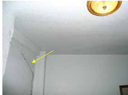
Fotografía 201. Paramento vertical agrietado en su parte superior.
