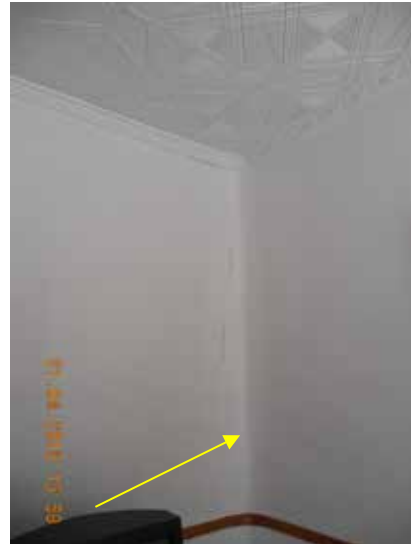
Fotografía 119. Fisura en la pared medianera con la vivienda nº 63.
