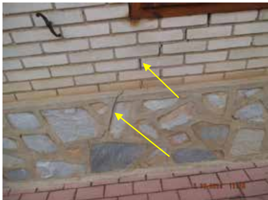
Fotografía 218. Fisura en el zócalo inferior de la fachada por debajo de la misma ventana que la Fotografía 216.
