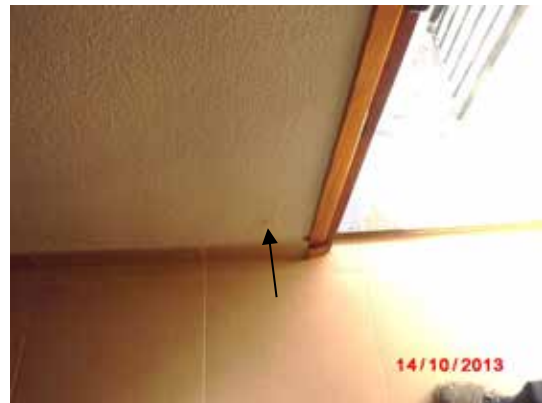
Fotografía 549. Humedad por capilaridad junto a la puerta.
