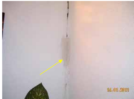
Fotografía 31. Detalle de un testigo de yeso de reciente colocación.
