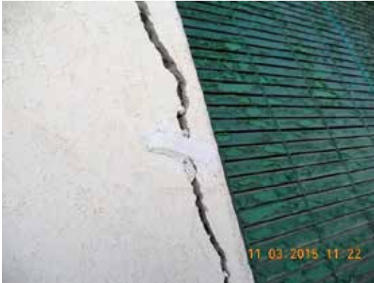
Fotografía 82. Testigo en la grieta de la fachada de la puerta principal.
