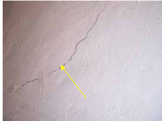
Fotografía 100. Fisura al otro extremo de la puerta de entrada.
