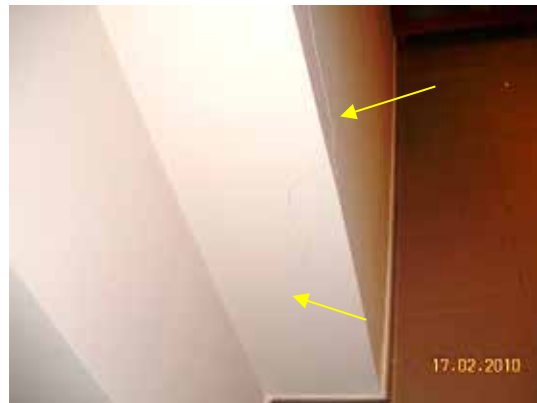
Fotografía 488. Otro aspecto de la misma grieta en la pared, desde otro ángulo.
