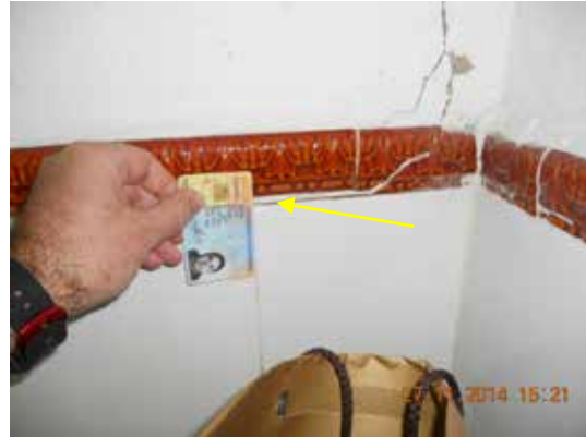
Fotografía 304. Se puede apreciar la amplitud de la fisura.
