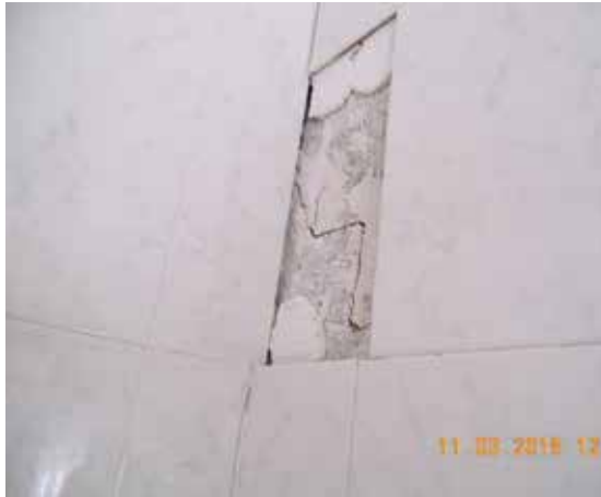
Fotografía 90. Pieza caída en la pared que muestra grieta.
