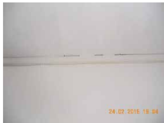
Fotografía 69. Grieta en el falso techo junto a la moldura.
