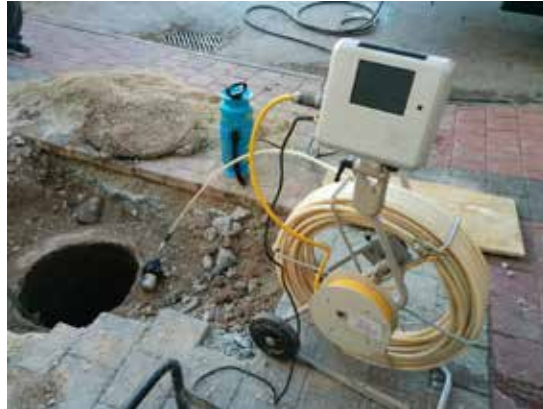
Fotografía 21. Cámara de inspección manual de saneamiento con grabación de video.
