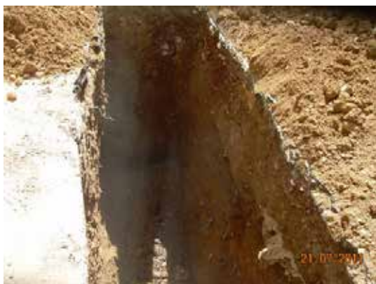
Fotografía 418. Se aprecia en el corte lateral de la zanja el material de relleno con escombros.
