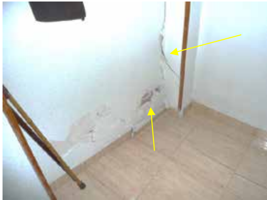
Fotografía 200. Pilar agrietado y paramento vertical colapsado.
