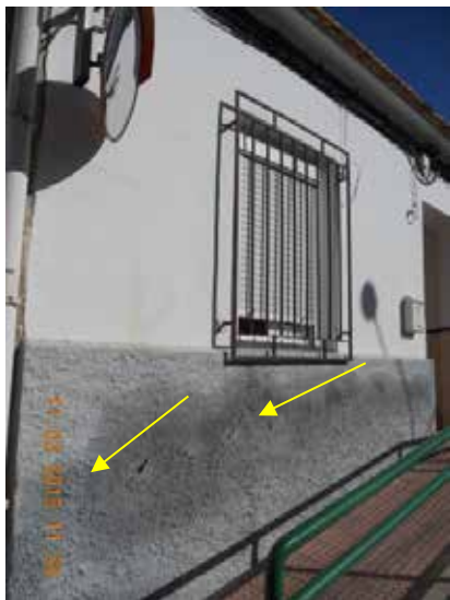
Fotografía 131. Humedad por capilaridad en la fachada.
