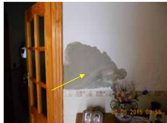
Fotografía 581. Humedades y azocalo alicatado.
