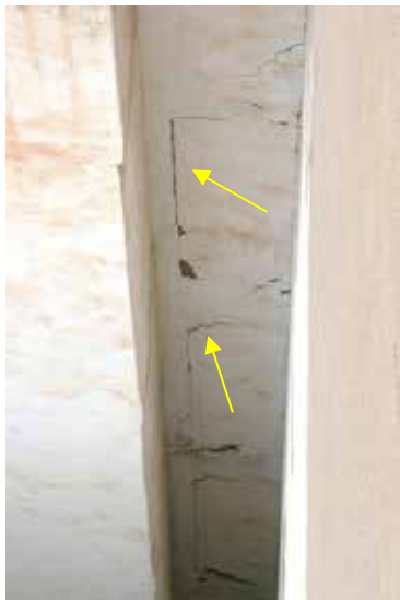
Fotografía 196. Grietas que coinciden con las uniones de los pilares y forjados con los muros de fábrica.
