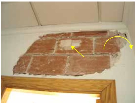
Fotografía 536. Recubrimiento de yeso desprendido, tomada 25/04/2016.
