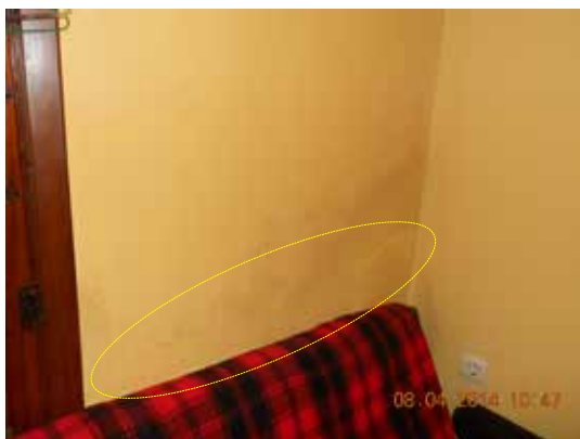
Fotografía 565. Paramentos verticales afectados por humedad por capilaridad.
