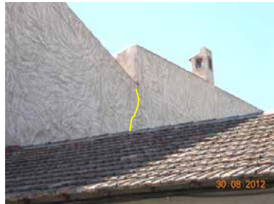
Fotografía 320. Se observa dónde comienza el movimiento del edificio.
