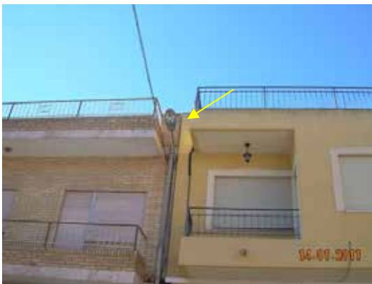
Fotografía 38. La grieta en la coronación de la fachada del inmueble.
