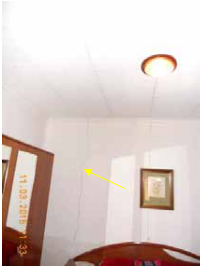
Fotografía 145. La grieta vertical en el paramento vertical.
