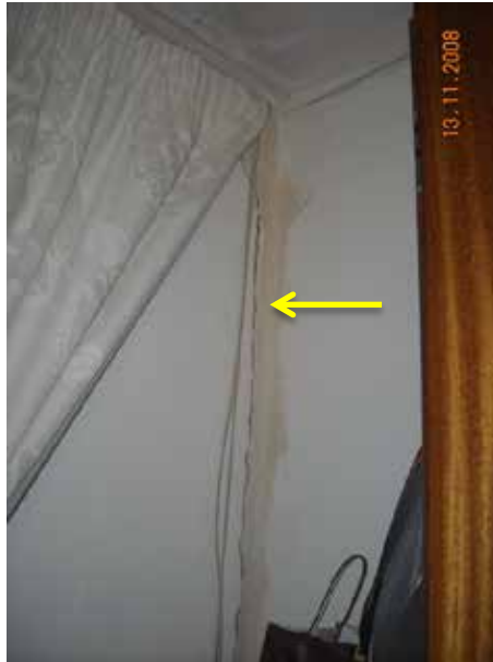
Fotografía 372. Grieta vertical en el encuentro de dos muros de carga.
