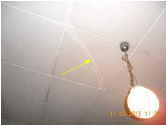
Fotografía 139. Fisura en el techo que ha sido reparada anteriormente.
