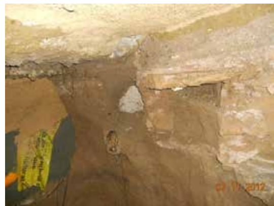
Fotografía 444. La red de saneamiento también se descolgó.
