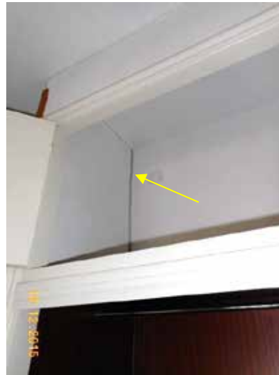
Fotografía 615. El armario empotrado del dormitorio 3 tiene sus tabiques desplazados considerablemente.
