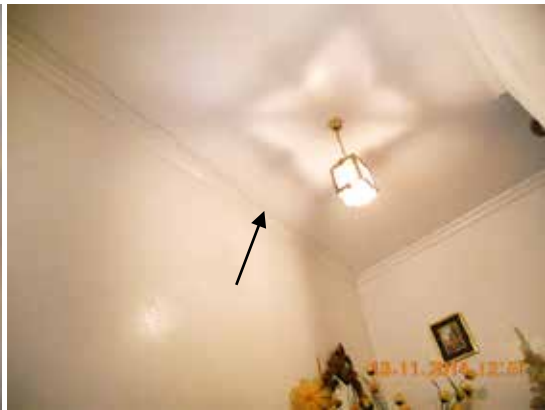
Fotografía 281. Misma fisura que en la anterior en el otro extremo.
