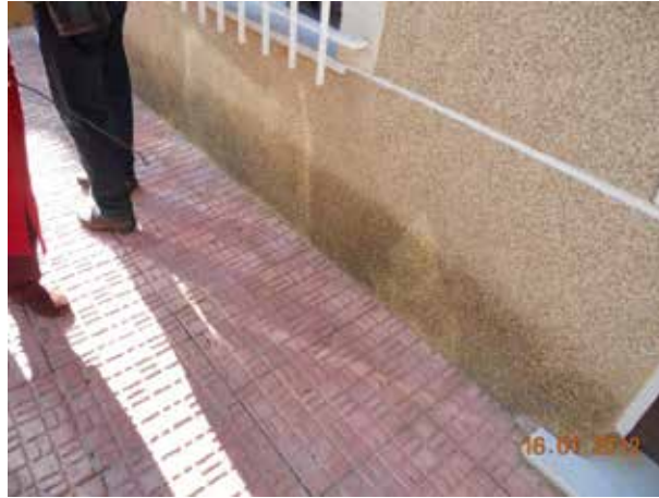
Fotografía 7. Manchas provocadas por humedad del terreno que ha ascendido por capilaridad, al no tener la vivienda forjado sanitario ni cámara de ventilación.
