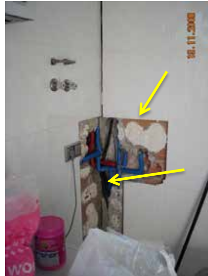
Fotografía 369. Detalle de la zona donde se encontró la avería en la red de fontanería.
