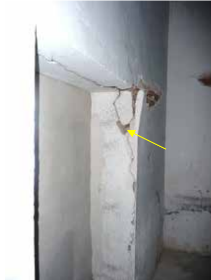
Fotografía 189. Daños en un muro de fábrica en uno de los bajos comerciales.
