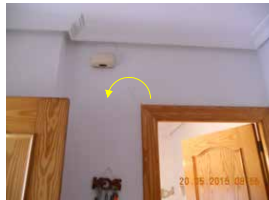
Fotografía 579. Fisura inclinada en el hueco de la puerta que indica asiento diferencial.
