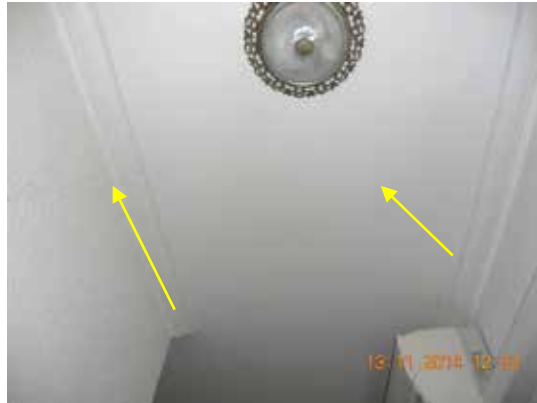
Fotografía 283. La fisura atraviesa el techo.
