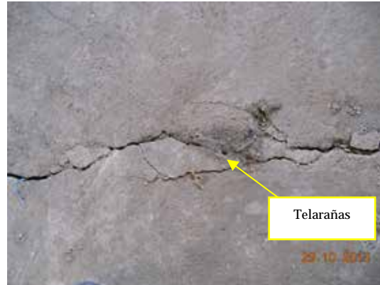
Fotografía 408.- Grietas ampliadas donde se observan telarañas.
