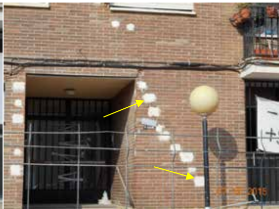
Fotografía 181. Misma fotografía de la grieta anterior tomada 07/12/2015 con el testigo superior sin fracturar.
