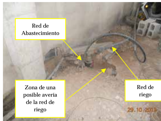
Fotografía 401.- Red de riego en el interior de la nave en la misma zona de la avería de la acometida.
