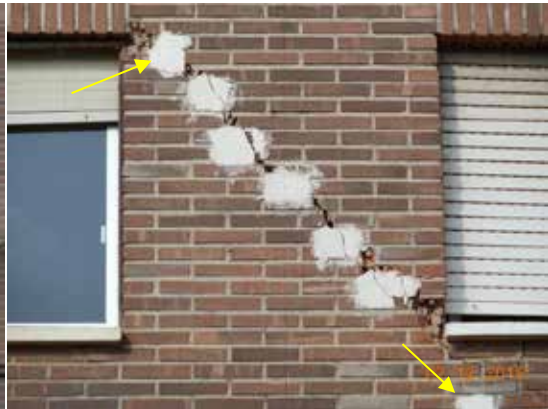
Fotografía 179. Misma fotografía de la grieta anterior tomada 07/12/2015 con el testigo de 21/8/2014 sin fracturar.
