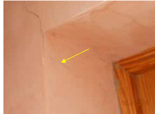
Fotografía 456. Grieta en la jamba de la puerta.
