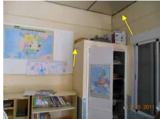
Fotografía 624. Grietas en la zona más cercana a la avería.
