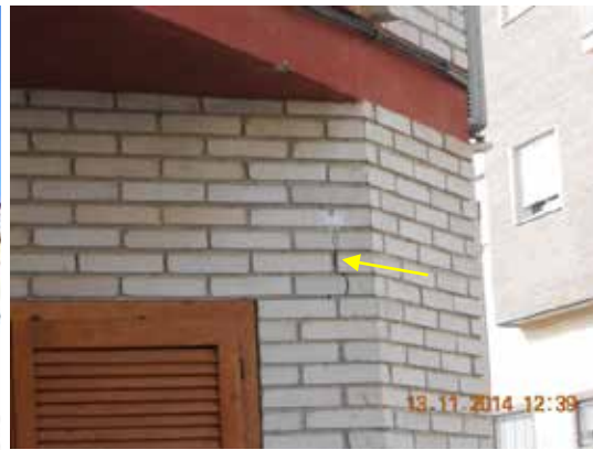
Fotografía 223. Misma fisura que la de la Fotografía 222 tomada en noviembre. Se aprecia que ha aumentado su tamaño y que han instalado un testigo de yeso que se encuentra sin fracturar.
