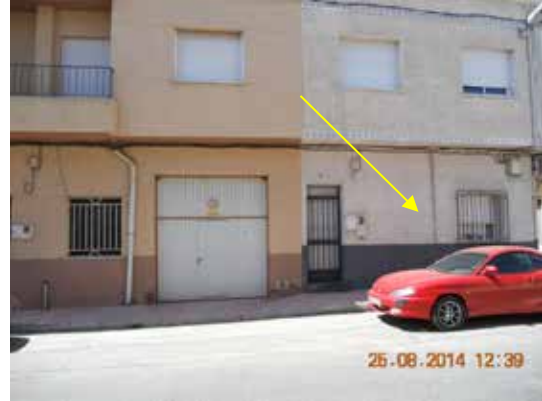
Fotografía 334. Vista general de la fachada de la calle Manila donde se aprecia la grieta oblicua.
