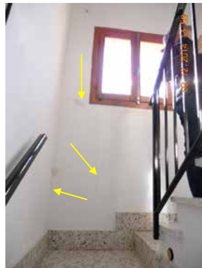
Fotografía 270. Fisuras en el hueco de las escaleras coincidiendo con las esquinas del ventanal.
