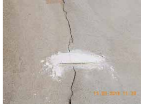
Fotografía 83. Testigo fisurado levemente en la fachada de la calle Parricas. .
