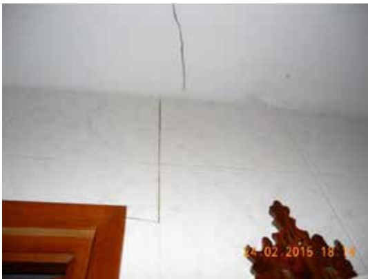
Fotografía 80. Grieta en el alicatado de la cocina.
