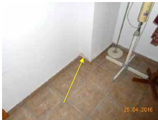
Fotografía 517. Base del pilar con humedades.
