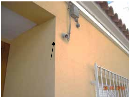
Fotografía 495. Pequeñas fisuras en la fachada y la mocheta de la puerta.
