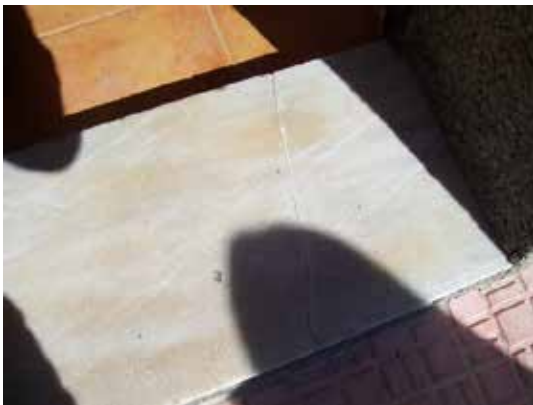
Fotografía 97. Piedra de mármol agrietada en un portal.
