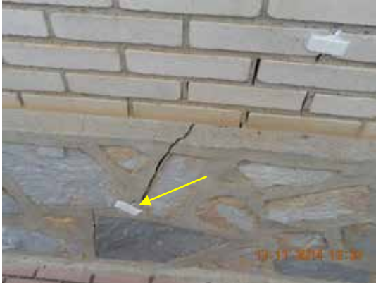
Fotografía 228. Testigo en grieta tomado el 13 de noviembre.
