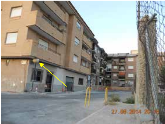
Fotografía 182. Farola sobre la que parece apoyarse el edificio.
