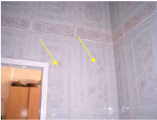
Fotografía 355. Fisuras aparecidas en los azulejos del cuarto de baño (tomada el 31/03/2015).
