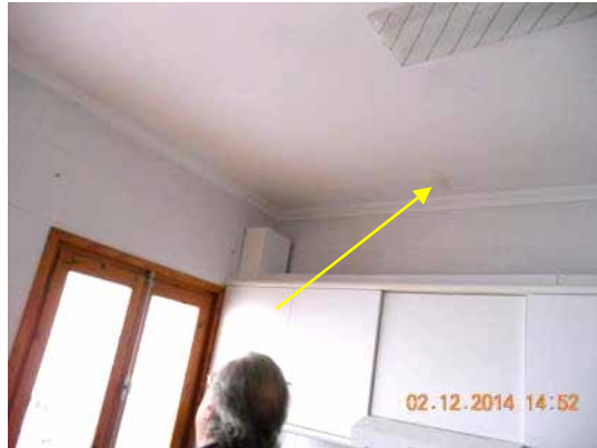
Fotografía 254. Fisura longitudinal que atraviesa la cocina.
