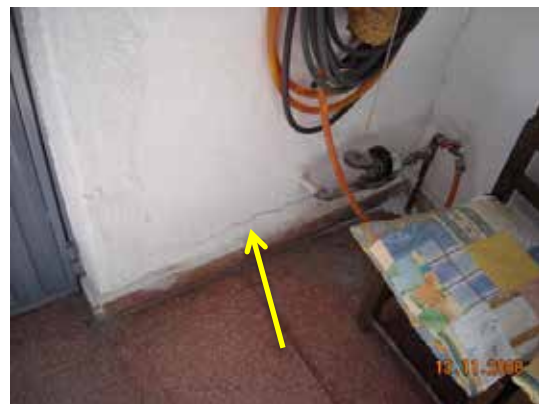
Fotografía 364. Grieta horizontal en el mismo muro de fachada.
