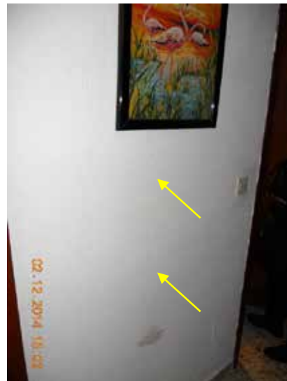
Fotografía 274. Fisuras en el pasillo.
