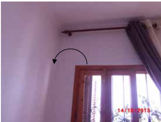
Fotografía 548. Leve fisura en la vivienda nº4.
