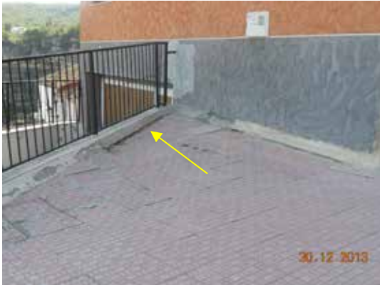
Fotografía 509. Aberturas en la acera.
