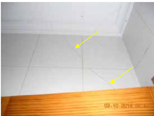
Fotografía 349. Elementos cerámicos partidos dentro de la cocina.
