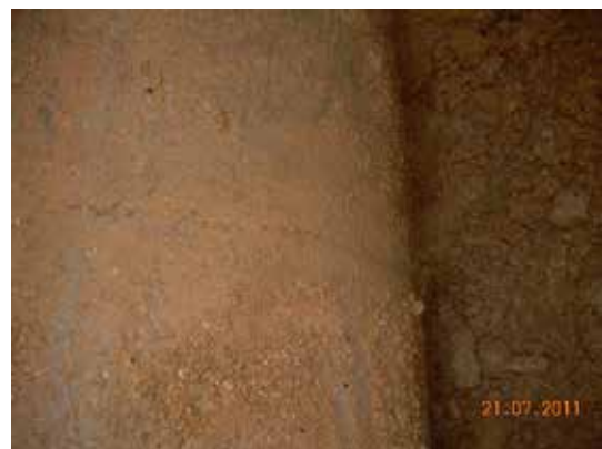
Fotografía 419. Indicios de fisura en la red de saneamiento de hormigón armado.
