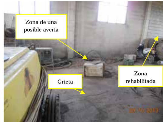
Fotografía 404.- Zona interior supuestamente afectada por la avería de la acometida.
