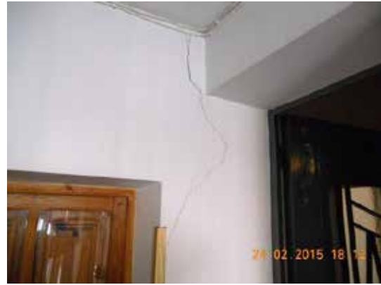
Fotografía 79. Fisura de poca importancia junto a una viga de hormigón. .
