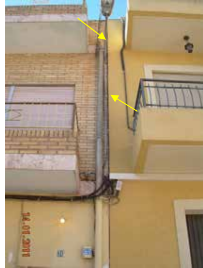
Fotografía 37. La grieta llega hasta la parte superior del edificio.
