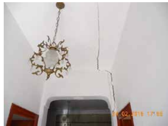
Fotografía 61. Prolongación de la grieta a través del recibidor hasta el falso arco de la primera crujía.
