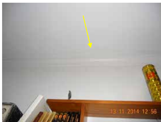
Fotografía 293. Leve fisura paralela a la moldura de escayola del techo.
