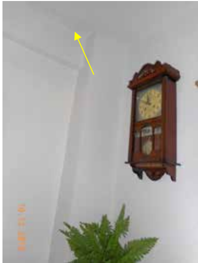
Fotografía 618. Se aprecian humedades en una de las esquinas del salón, proveniente de agua que viene del tejado.
