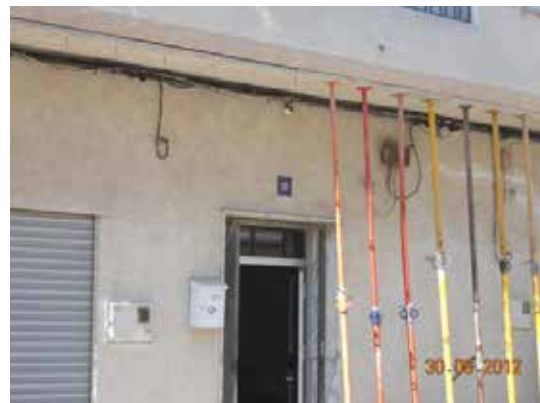
Fotografía 322. Fachada del número 17 apuntalada.
