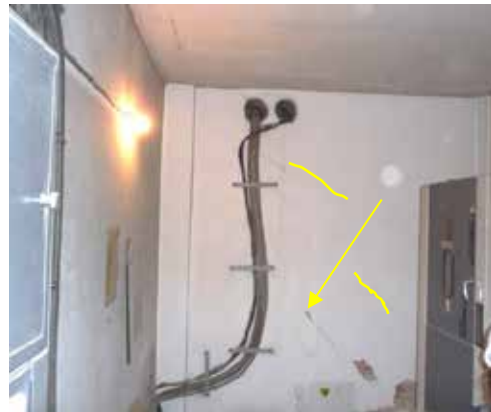
Fotografía 205. Grietas en el interior del cuarto del transformador CT.
