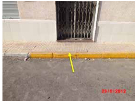
Fotografía 315. Se observa que las losas de la acera están levantadas.
