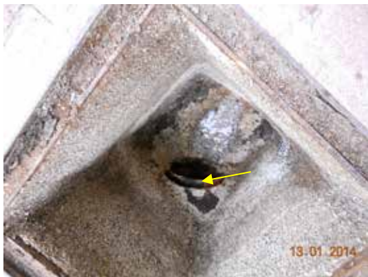
Fotografía 569. Tubería descolgada de la boca de la arqueta de saneamiento.
