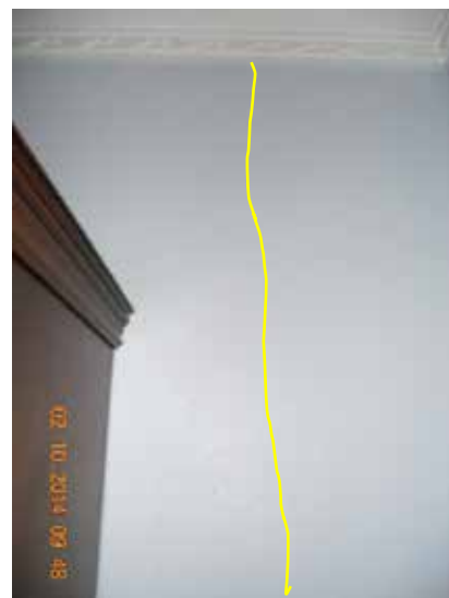
Fotografía 354. Fisura de poca importancia en primera planta. .
