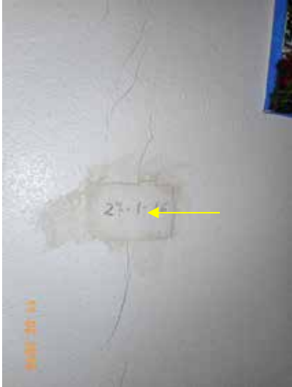
Fotografía 528. Testigo sin marcar en el pasillo junto pilar, tomada 11/02/2016.
