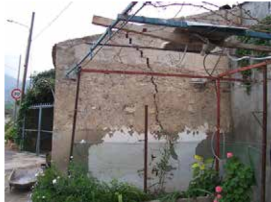
Fotografía 450. Estado de las importantes grietas aparecidas.
