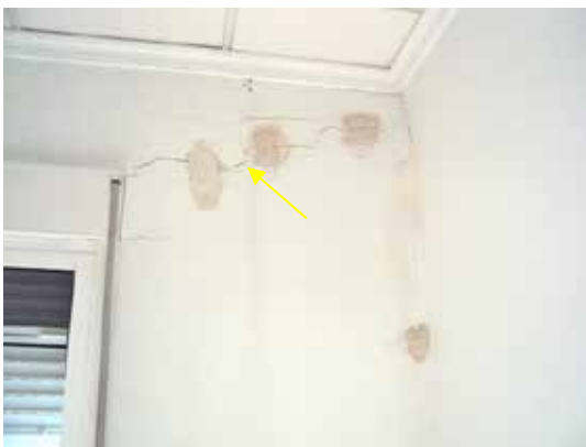
Fotografía 538. Grieta que termina en el hueco de la puerta, tomada 25/04/2016.
