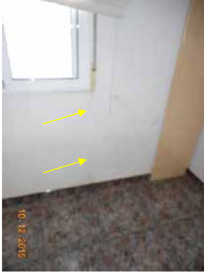
Fotografía 606. Fisuras en el dormitorio 2.
