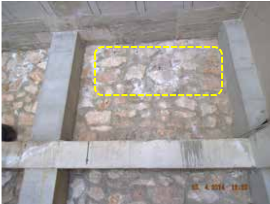
Fotografía 571. Humedades por capilaridad.
