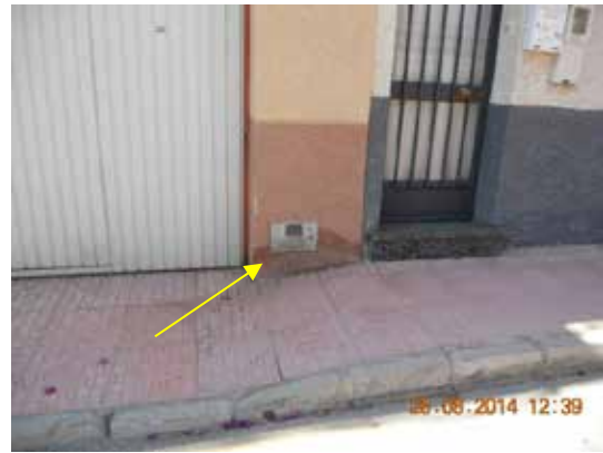
Fotografía 356. Zona con humedad, corresponde a la 3ª avería.
