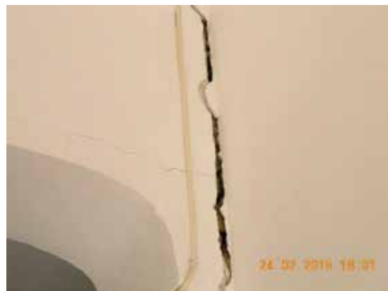
Fotografía 65. La grieta en el extremo del dintel no muestra suciedad ni telarañas.
