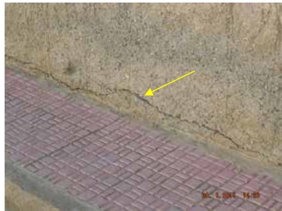
Fotografía 57. Grieta horizontal en zócalo inferior en la calle Parricas.
