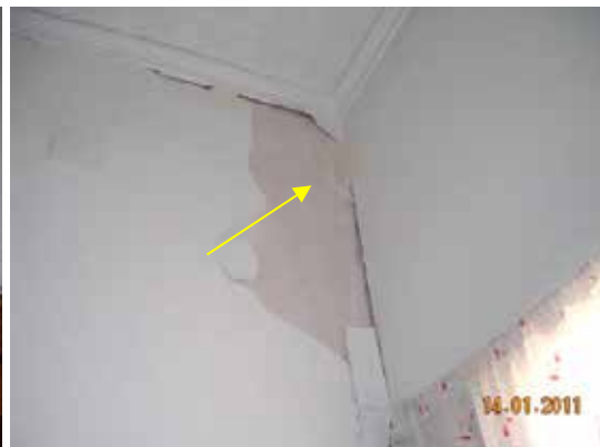
Fotografía 27. Se aprecia el descuelgue de la medianera de la vivienda.
