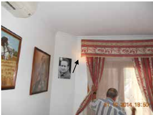
Fotografía 234. Fisura tomada en octubre.
