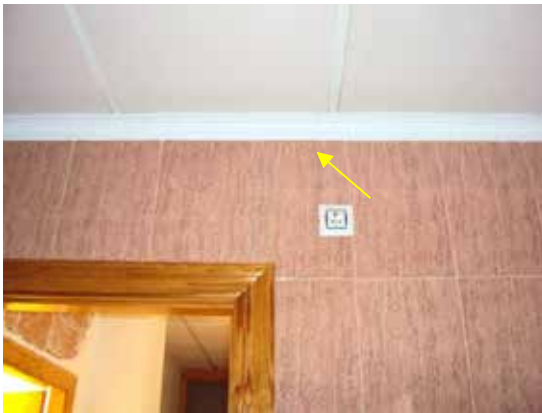
Fotografía 542. Pequeña fisura en una pieza de gres, tomada 25/04/2016.
