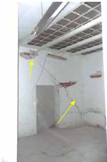
Fotografía 198. Grietas y desprendimientos de yeso de la pared en uno de los bajos.
