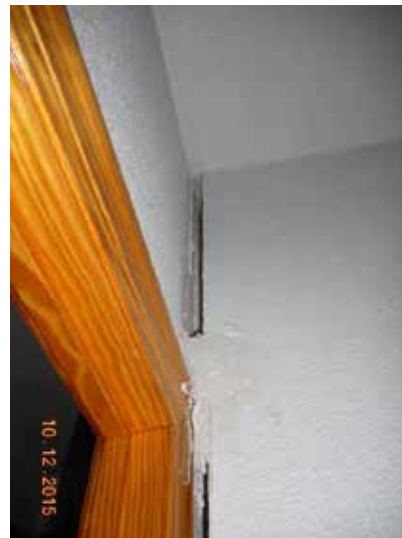
Fotografía 605. El tabique del armario empotrado se ha separado unos 12mm de la pared que da al pasillo en el dormitorio 1.
