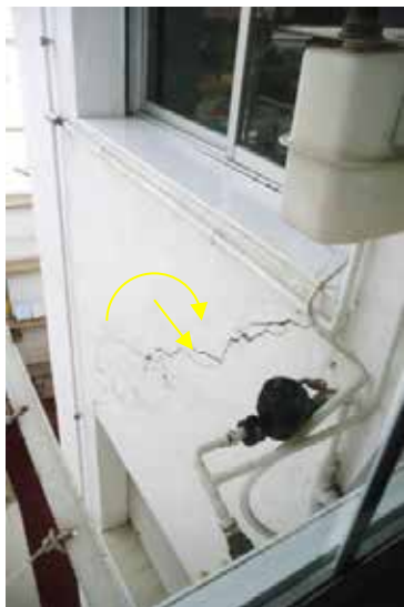
Fotografía 202. Grieta inclinada en el patio de luces.
