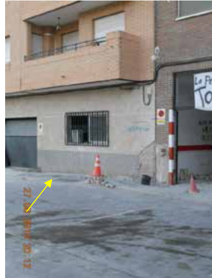
Fotografía 167. Lugar donde tuvo lugar la avería de la red de abastecimiento.
