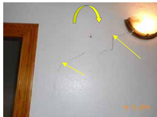
Fotografía 597. Continuación de la grieta de la Fotografía anterior que llega a la puerta del Dormitorio 2.
