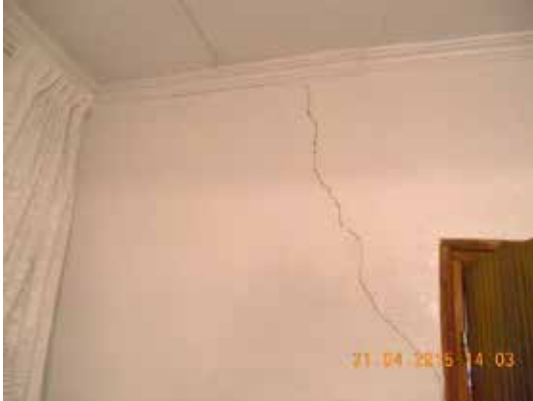
Fotografía 126. La grieta oblicua en una habitación interior.
