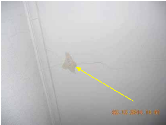
Fotografía 253. Fisura estabilizada en techo cocina.
