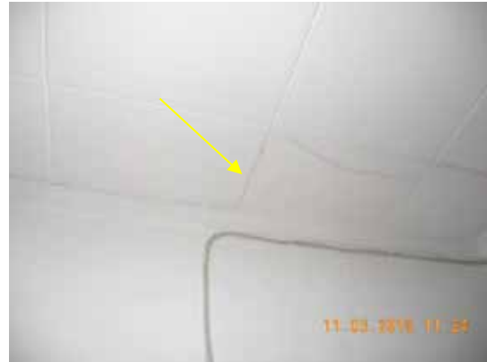
Fotografía 134. Fisuras en las uniones de la escayola.
