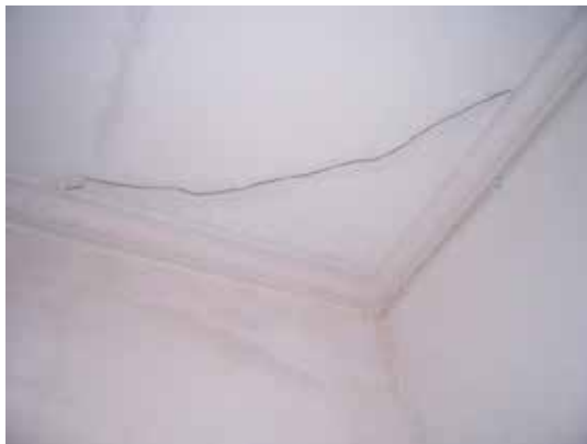
Fotografía 107. La grieta en una esquina del falso techo.
