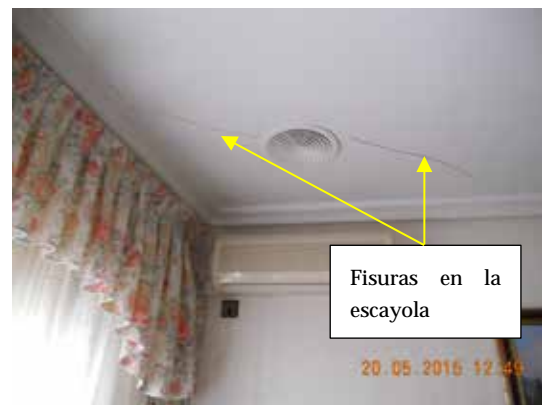
Fotografía 575. Daños en la habitación junto al muro de fachada.
