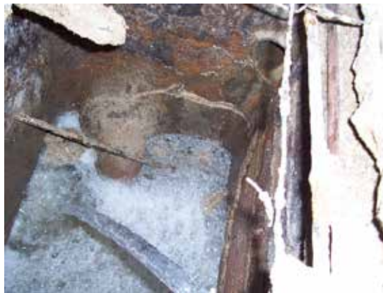
Fotografía 42. Detalle de la arqueta interior de saneamiento situada en el patio, donde se aprecian grietas y zonas que carecen de enlucido.
