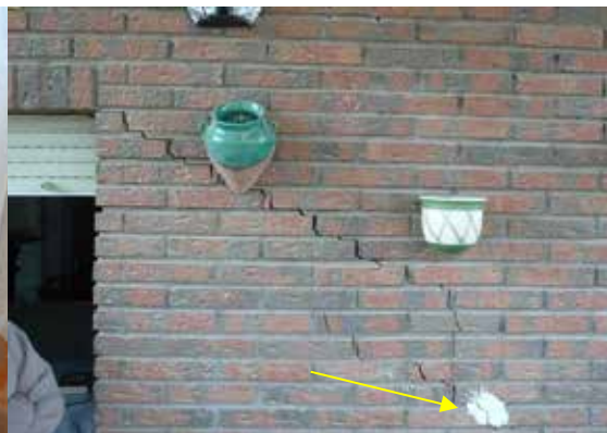
Fotografía 195. Se observa un testigo de yeso fracturado en un balcón.
