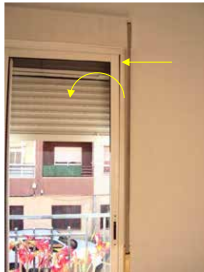
Fotografía 535. Marco de puerta girado, tomada 25/04/2016.
