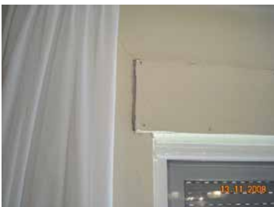
Fotografía 370. La tapa de la cajonera de la persiana se ha despegado.
