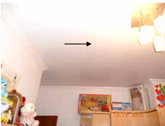
Fotografía 286. La misma fisura que en la Fotografía 285 en la habitación opuesta.
