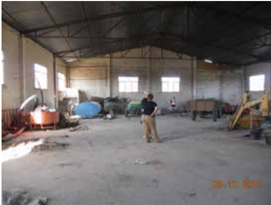
Fotografía 410.- Alzado interior de la zona afectada.
