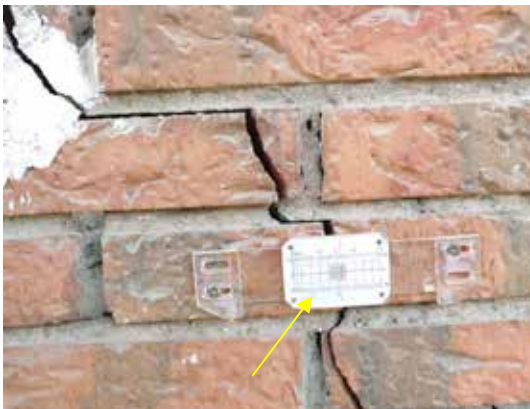
Fotografía 212. Fisurómetro instalado sobre grieta de la fachada junto testigo de yeso.
