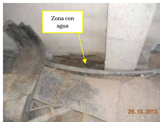
Fotografía 402.- Detalle ampliado de la zona donde se aprecia la existencia de agua.
