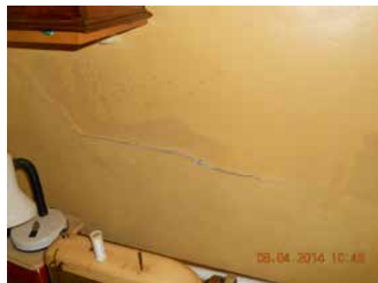
Fotografía 566. Zona repintada y reamaestrada con humedad con eflorescencias.
