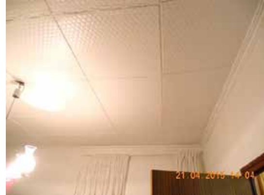
Fotografía 127. Grietas en el falso techo posiblemente generadas por goteras en la cubierta.
