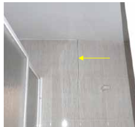
Fotografía 531. Misma junta que la separación se ha hecho mayor, tomada 25/04/2016.
