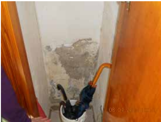
Fotografía 567. Rincón de la vivienda con desprendimientos de la capa de enlucido.
