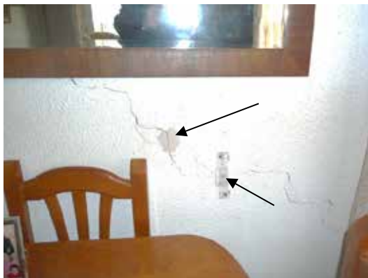
Fotografía 194. Fisurómetro instalado junto a testigo de yeso fracturado.
