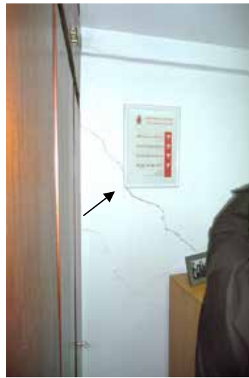
Fotografía 193. Grieta en paramento vertical interior.
