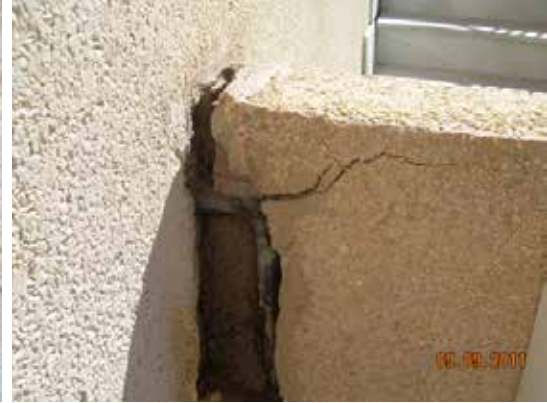
Fotografía 426. Detalle del desplazamiento del murete.
