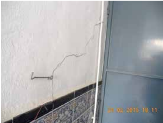
Fotografía 78. La misma grieta que la Fotografía 68.
