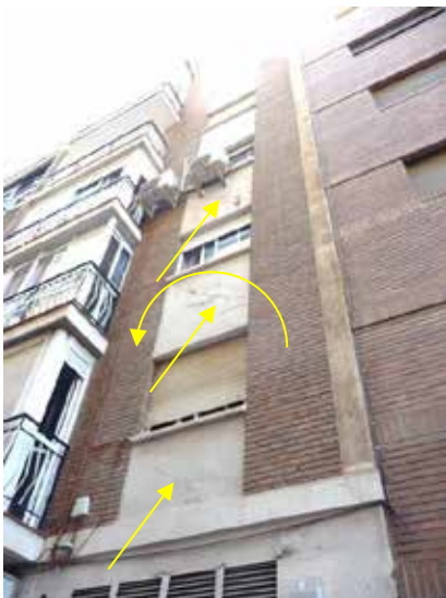
Fotografía 206. Grietas que indican hacia donde se ha movido el edificio.
