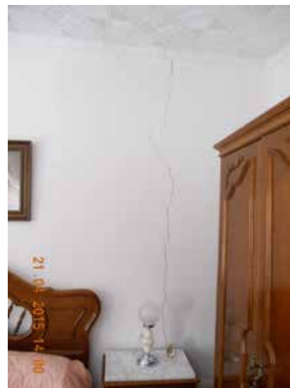
Fotografía 121. Grieta casi vertical en el mismo paramento que la anterior.
