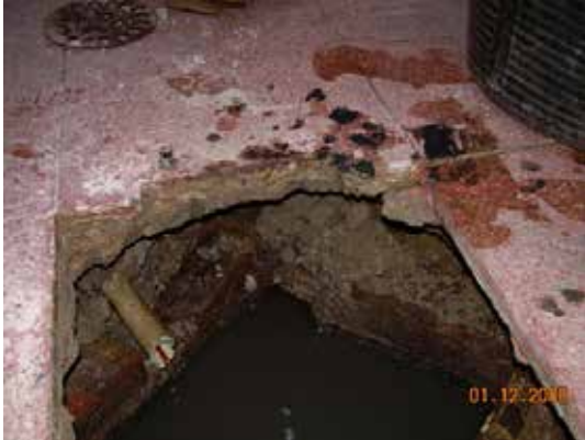
Fotografía 365. Arqueta interior donde se aprecia el agua estancada.
