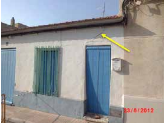
Fotografía 316. Grietas sobre el dintel de la puerta del nº 15.
