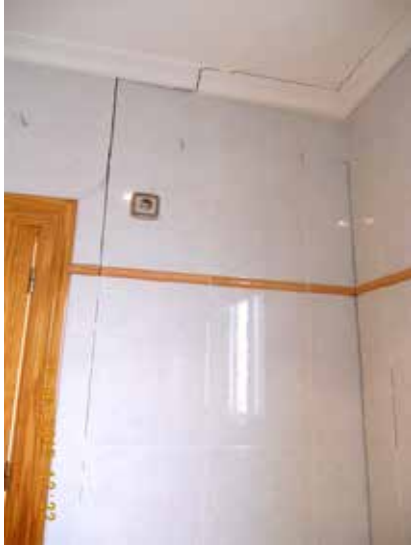
Fotografía 586. Grietas en el baño de la primera planta.
