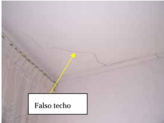
Fotografía 105. Las grietas en el falso techo indican que la estructura se ha movido.
