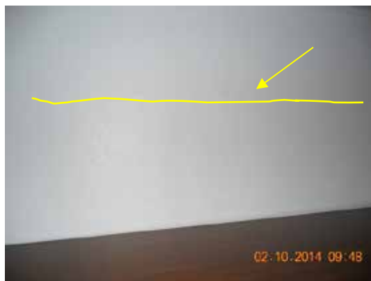
Fotografía 353. Pequeñas fisuras en la primera planta.
