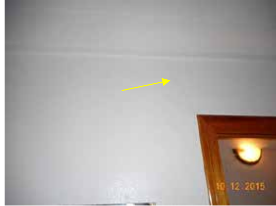
Fotografía 611. Fisura al otro extremo del marco de la Fotografía 610. Fisura encima del marco de la puerta del dormitorio 3 (matrimonio).
