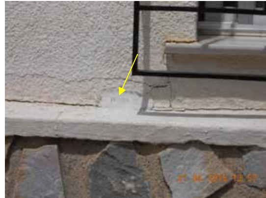
Fotografía 115. Testigo de yeso del 11 de marzo no fisurado.
