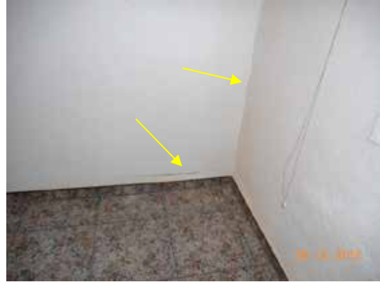
Fotografía 607. Fisuras en la pared izquierda del dormitorio 2.
