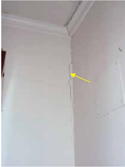
Fotografía 544. Fisura en el encuentro de los paramentos, tomada 25/04/2016.
