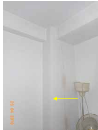
Fotografía 523. No se puede determinar el tipo de pilar.
