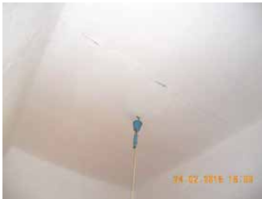
Fotografía 74. Grieta en el techo de la despensa
