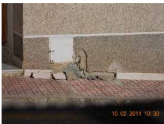
Fotografía 468. Parte de la fachada dañada por la reparación y sustitución de la acometida.
