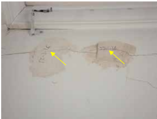
Fotografía 534. Testigos marcados, tomada 25/04/2016.
