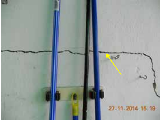
Fotografía 303. Fisura horizontal que cruza el paramento.
