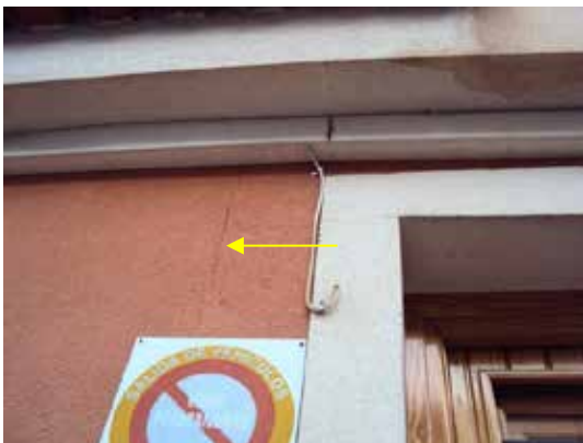
Fotografía 526. Fisura junto a la puerta del garaje tomada 11/02/2016.
