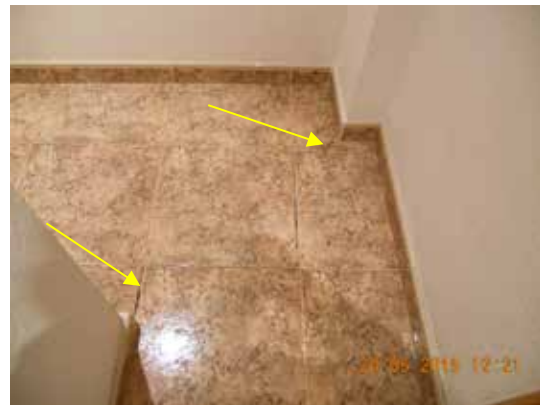
Fotografía 585. Grietas en el solado.
