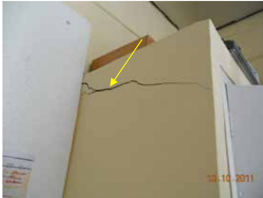
Fotografía 623. Grieta por fuera del armario de fábrica de ladrillo.
