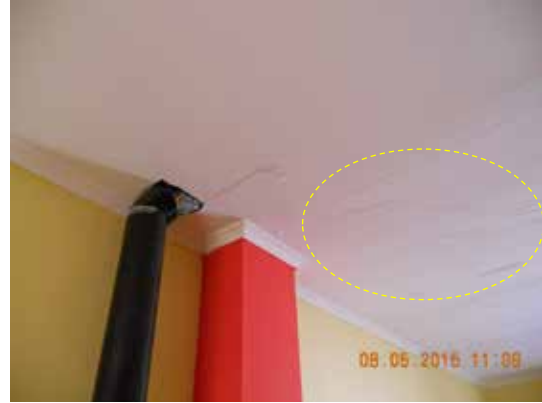
Fotografía 506. Deterioro del techo de escayola debido al tiro de la chimenea.
