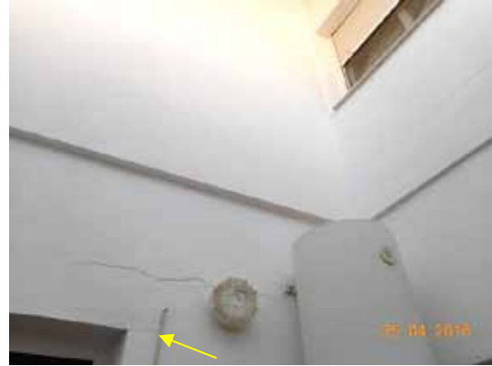
Fotografía 525. Fisuras marcando las vigas.
