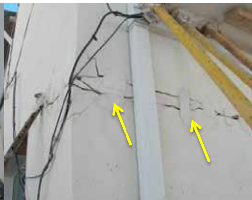
Fotografía 386. Situación de los testigos de yeso el 3 de enero de 2006.
