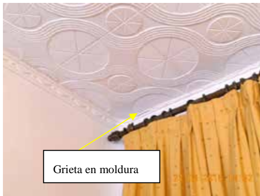
Fotografía 124. Las grietas en el falso techo indican que la estructura se ha movido.
