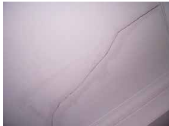
Fotografía 102. Grieta antigua en el falso techo que se ha vuelto a abrir.
