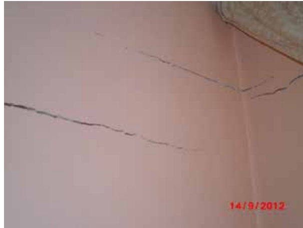
Fotografía 437. Grietas producidas en los paramentos verticales interiores.
