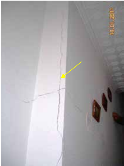
Fotografía 28. La caja de escaleras con grietas.
