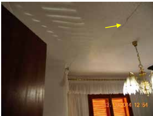
Fotografía 290. La fisura de más entidad en el techo.
