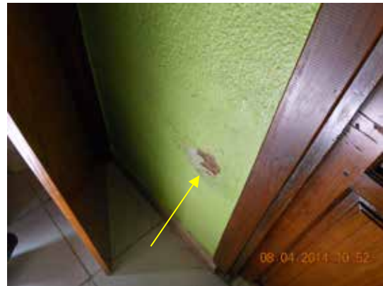
Fotografía 568. Desconchado provocado por humedad por capilaridad.
