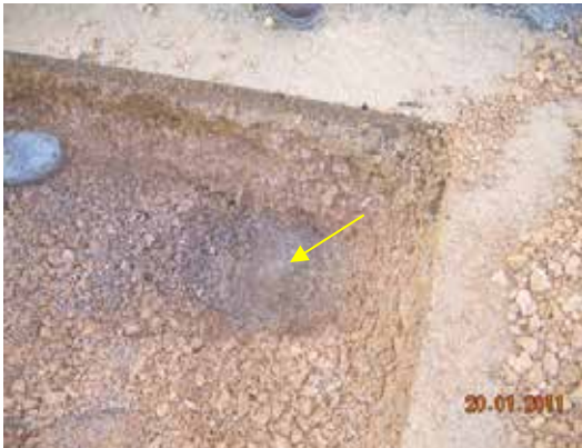
Fotografía 43. Se observa la primera avería en la acometida de abastecimiento.
