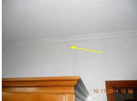
Fotografía 289. Misma fisura que la Fotografía 216 tomada en noviembre. No se aprecian apenas diferencias.
