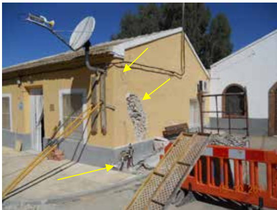
Fotografía 621. Zona más afectada.
