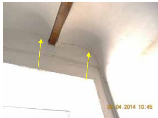
Fotografía 562. Grietas antiguas junto a las vigas de madera.
