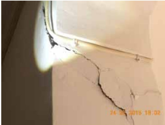
Fotografía 66. El dintel ha sufrido daños de importancia.
