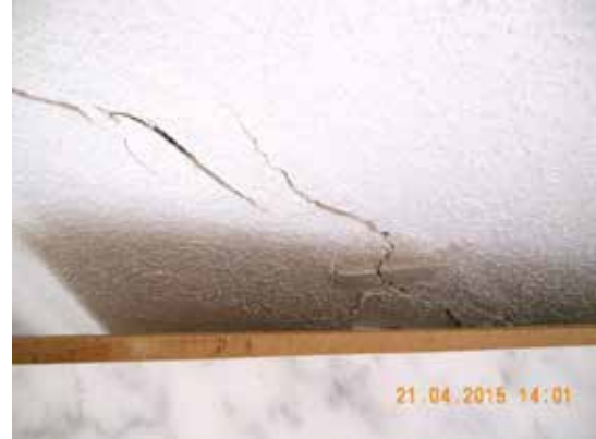
Fotografía 123. Se aprecia que las grietas son nuevas.
