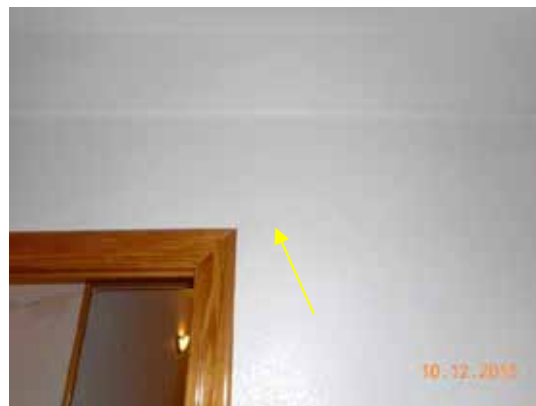
Fotografía 617. Leve fisura en el Salón.
