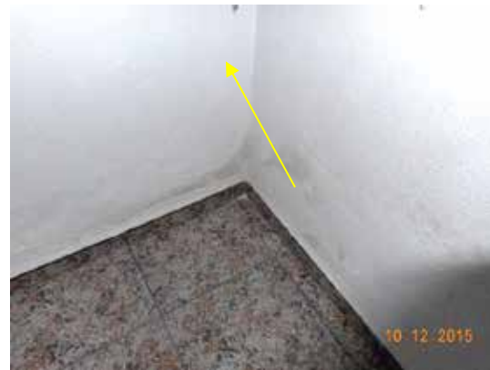
Fotografía 603. Fisura reciente que nace en el encuentro de los dos paramentos.
