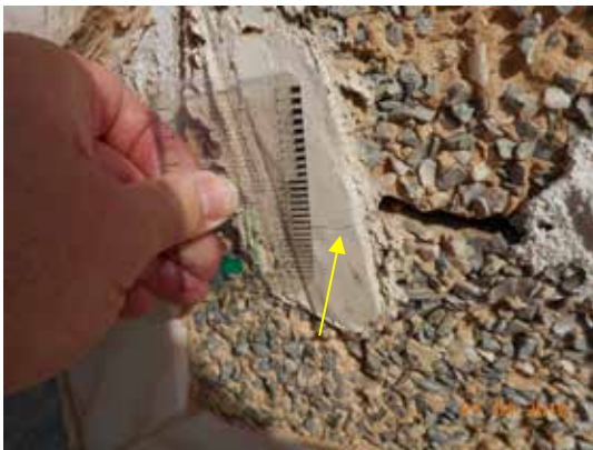
Fotografía 482. Testigos fisurados junto al primer escalón de la escalera de entrada, de fecha 21/09/15.
