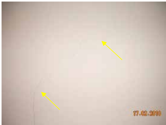
Fotografía 487. Pequeñas fisuras en una pared del interior de la vivienda.
