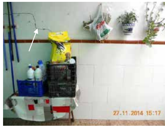
Fotografía 296. Las fisuras son oblicuas, mostrando un asiento diferencial.
