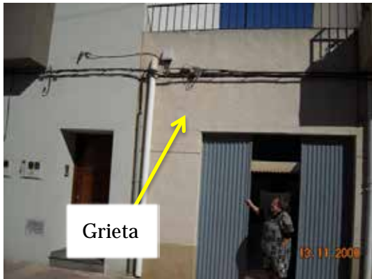
Fotografía 361. Fachada del número 10 donde se aprecia una grieta en dirección al n°12.
