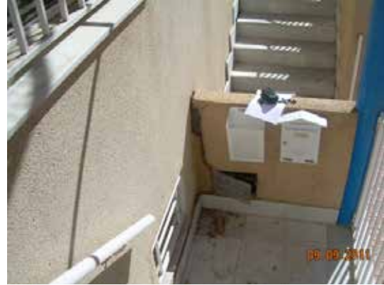
Fotografía 430. Se aprecia que el murete ha basculado hacia la derecha.
