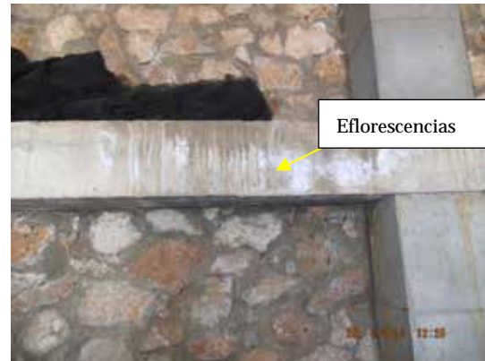
Fotografía 572. Viga de hormigón con eflorescencias.
