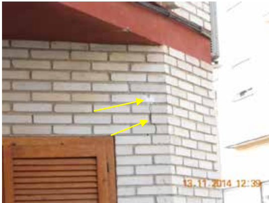
Fotografía 230. Grieta con testigo sin fracturar.
