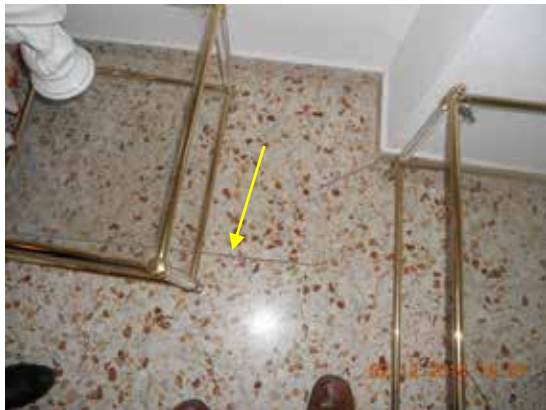
Fotografía 277. Fisuras en las juntas del terrazo.
