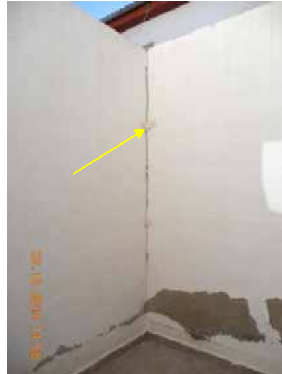
Fotografía 264. El testigo superior se ha despegado en su extremo izquierdo.
