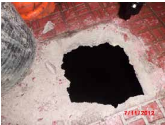
Fotografía 441. Ventana abierta donde se descubrió el socavón.
