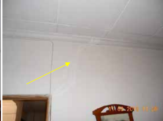
Fotografía 138. Fisura que ha sido reparada anteriormente.
