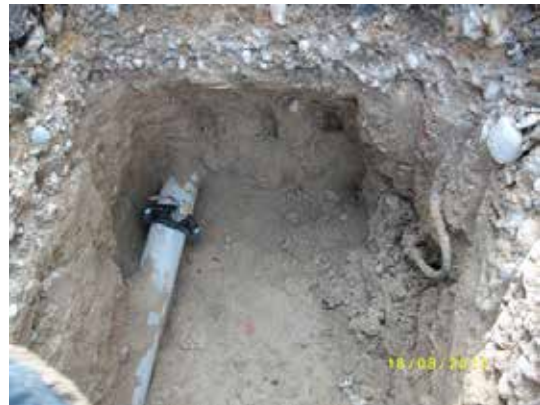
Fotografía 312. Acometida sin servicio.
