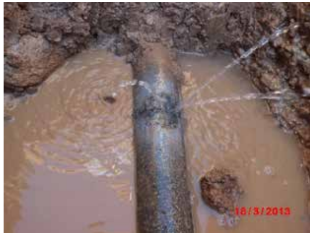
Fotografía 1. Rotura por agotamiento de una red de fibrocemento DN60.
