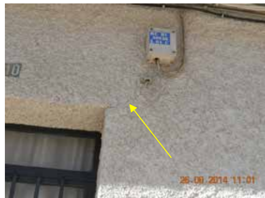
Fotografía 338. Grieta oblicua que parte de la mocheta de la puerta principal.
