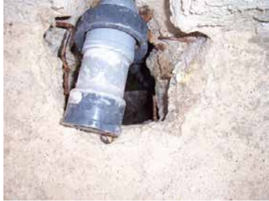
Fotografía 454. Detalle del pozo ciego lleno y junto a la cimentación del muro de fachada.
