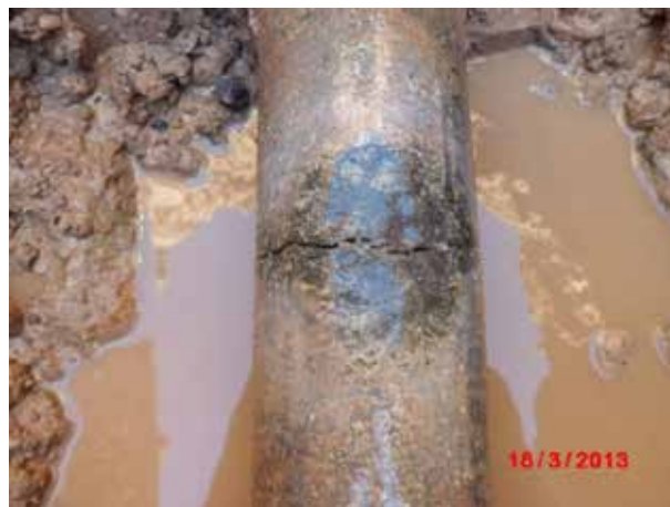
Fotografía 2. Detalle de la fractura producida.
