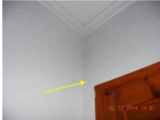
Fotografía 250. Fisura inclinada desde esquina superior izquierda a intersección entre muro y forjado.
