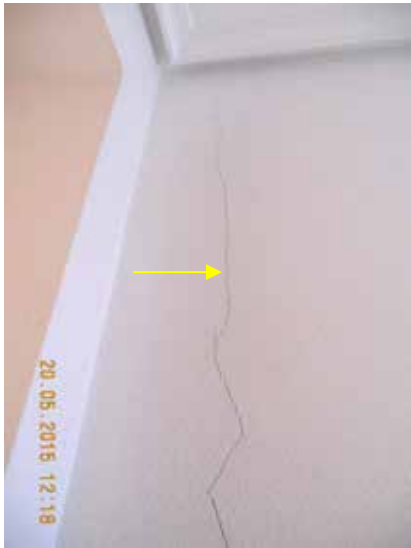
Fotografía 582. Fisuras en las escaleras de subida a la planta superior.
