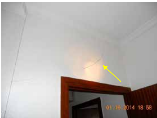
Fotografía 242. Fisura sobre la puerta de una de las habitaciones de la primera planta.
