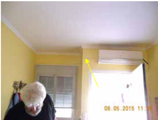
Fotografía 503. Grieta reciente en el paramento junto al muro de la fachada.
