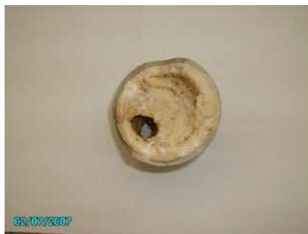
Fotografía 3: Conducción de fibrocemento afectada por la acumulación de carbonato cálcico.
