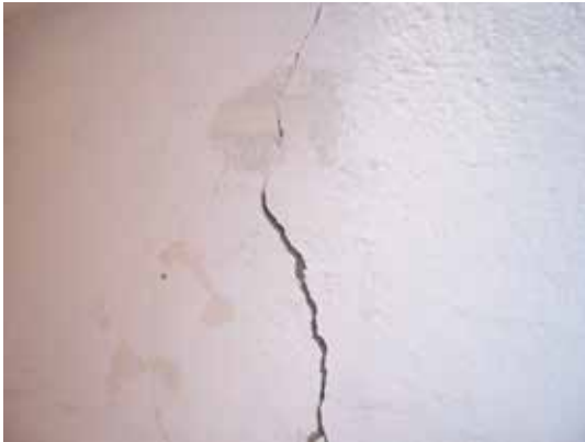
Fotografía 99. Misma grieta que la fachada que ha atravesado el muro.
