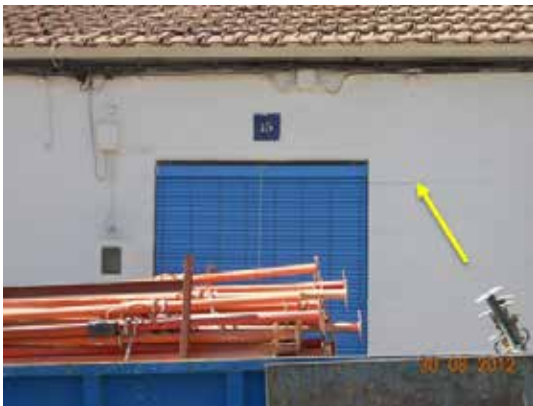
Fotografía 323. Grieta en el marco de la puerta del número 15.
