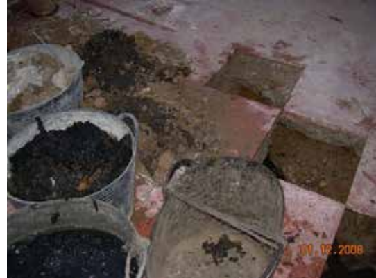
Fotografía 366. Fango extraído de la arqueta y alrededores.
