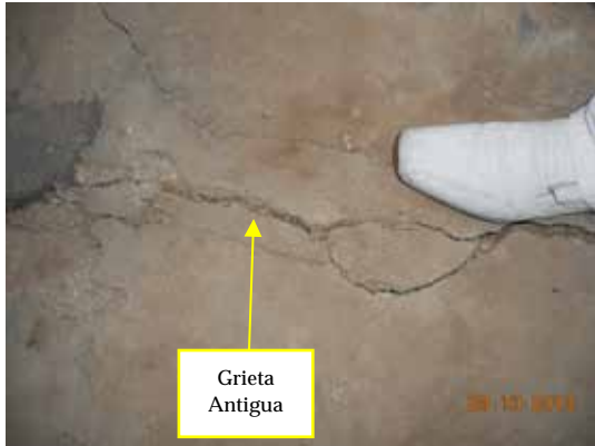
Fotografía 407.- Grietas antiguas de la solera de la nave.
