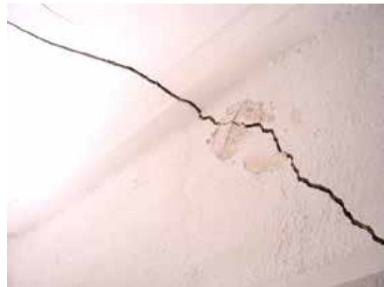
Fotografía 98. Grieta oblicua ascendente desde el paramento vertical al falso techo.
