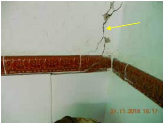
Fotografía 299. Fisura que atraviesa los azulejos y la parte enlucida.
