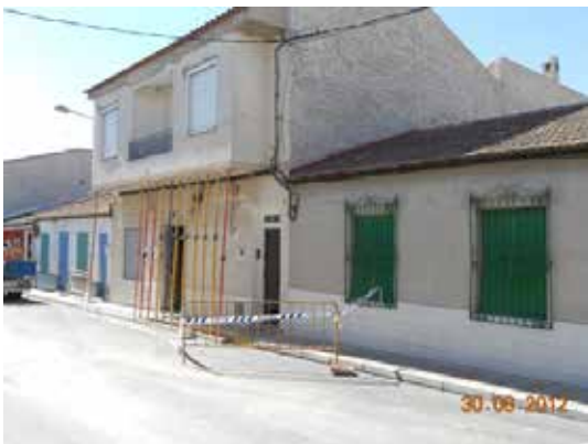
Fotografía 321. Visión global de las tres viviendas afectadas.
