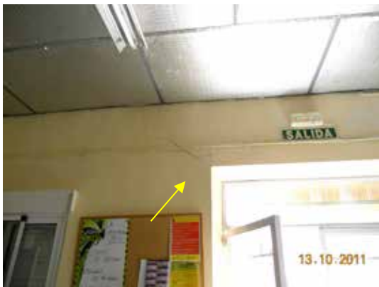
Fotografía 625. Fisuras en el hueco de la puerta de entrada.
