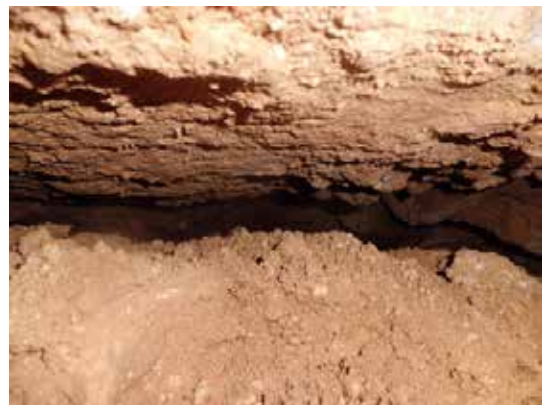
Fotografía 432. Detalle del descalce de la cimentación.
