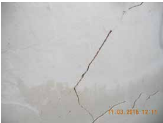
Fotografía 147. Grieta en la parte baja del muro de carga interior de la fachada.
