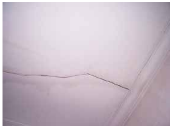
Fotografía 104. Grieta en la unión o junta del falso techo.
