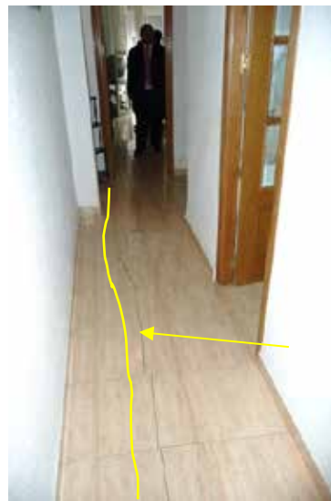
Fotografía 199. Fisura longitudinal en el suelo cerámico síntoma de movimiento del forjado.
