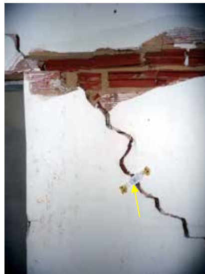
Fotografía 207. Grieta en paramento vertical con Fisurómetro instalado.
