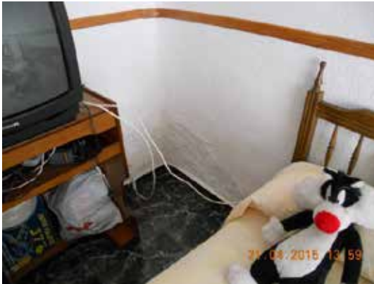
Fotografía 118. Humedades antiguas por capilaridad.
