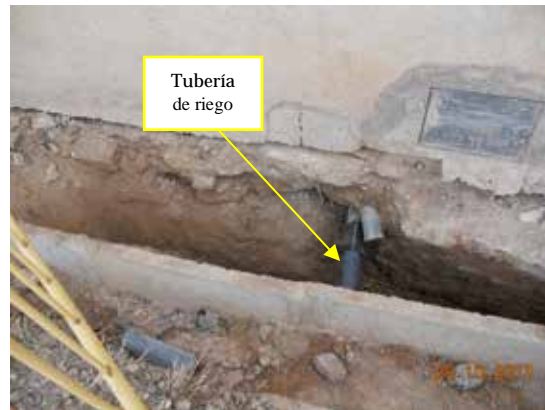
Fotografía 392. Se localizó una tubería de riego que entraba dentro de la nave justo al lado de la acometida de agua.
