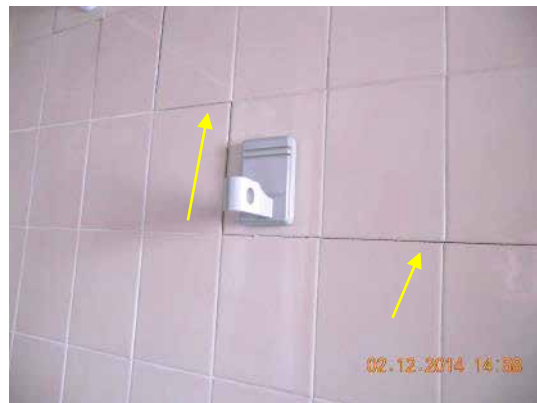
Fotografía 266. En este tramo las fisuras se han producido en las juntas de los azulejos.
