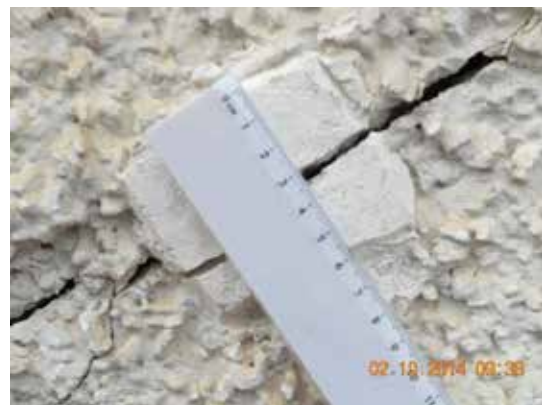
Fotografía 346. En Octubre se midió de nuevo la misma grieta que en la Fotografía 345.
