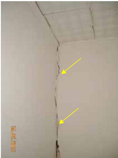
Fotografía 30. Grieta en el encuentro con la pared medianera.
