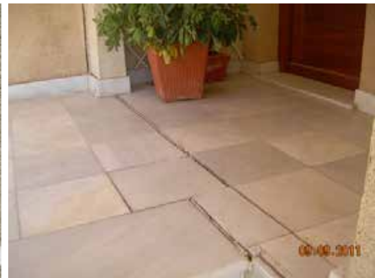
Fotografía 428. Las grietas están ennegrecidas, síntoma de que son antiguas.
