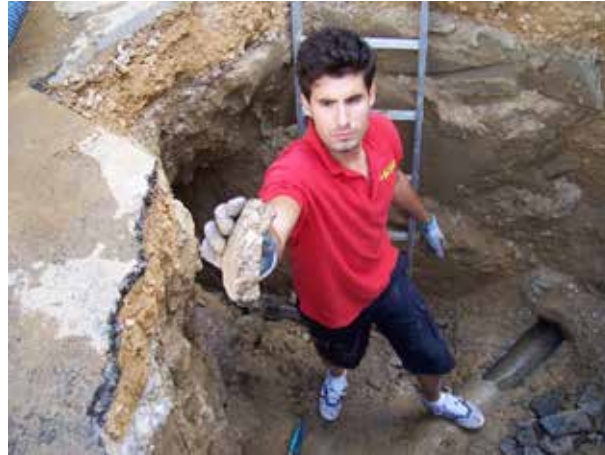
Fotografía 53 Muestra de uno de los trozos de la inyección cementosa encontrados en el interior de la tubería de saneamiento de 200mm.
