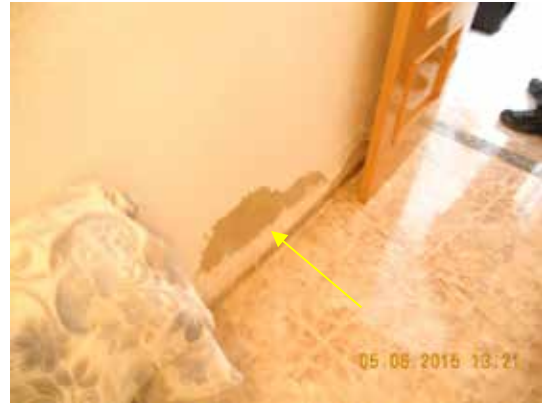
Fotografía 591. Humedad por capilaridad.
