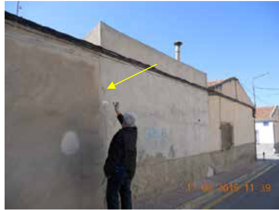
Fotografía 59. Vista general de la fachada de la calle Parricas donde se aprecia la fisura oblicua.
