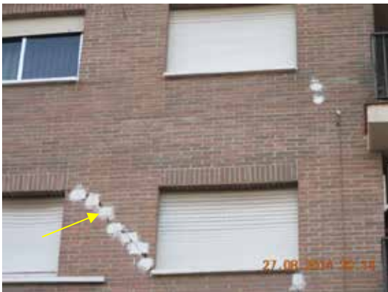
Fotografía 176. Grieta segunda planta con testigo del día 21/8/2014 sin fracturar.
