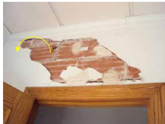
Fotografía 537. Recubrimiento de yeso desprendido por dentro de la habitación, tomada 25/04/2016.
