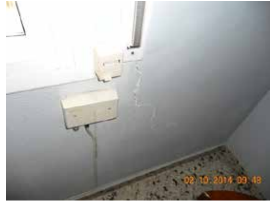
Fotografía 352. Grieta de consideración en el dormitorio de la planta superior.
