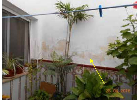
Fotografía 521. Humedades muy antiguas que provienen de la calle posterior.
