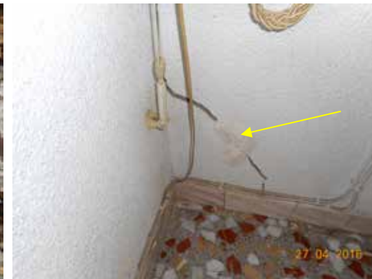
Fotografía 483. Testigo fisurado en la habitación interior de fecha 21/09/15.
