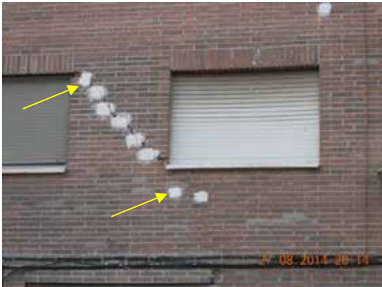
Fotografía 178. Grieta primera planta con testigo del día 21/8/2014 sin fracturar.
