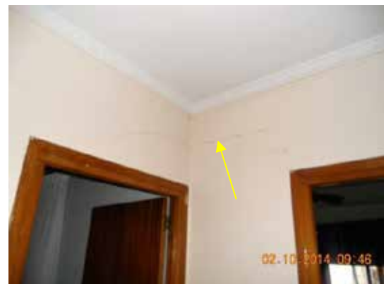
Fotografía 350. Grietas entre dos puertas en la planta baja.
