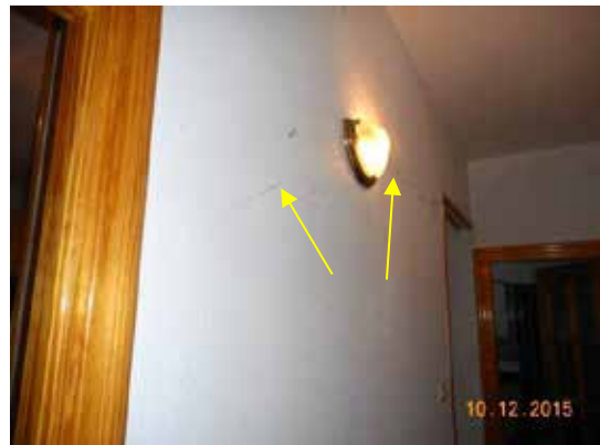
Fotografía 609. Fisura en el pasillo entre la puerta del dormitorio 2 y el pasillo que va al baño.
