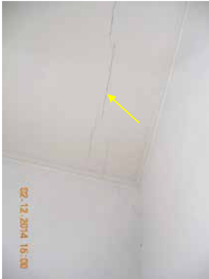
Fotografía 271. Fisuras longitudinales en el techo de la primera planta
