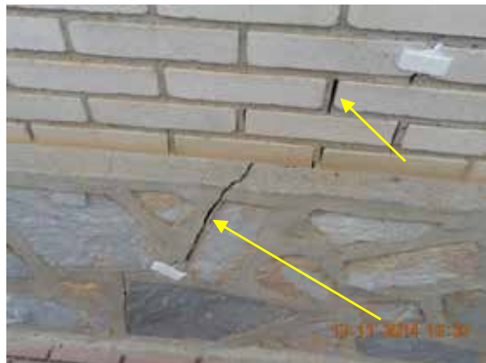
Fotografía 219. Misma fisura el 13 de noviembre de 2014. Se aprecia que su tamaño es mayor.
