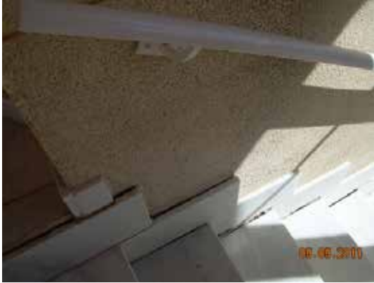
Fotografía 429. Detalle de los rodapiés de la escalera despegados.
