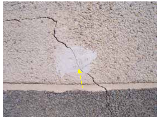
Fotografía 94. Testigo del día 4 de diciembre fisurado.
