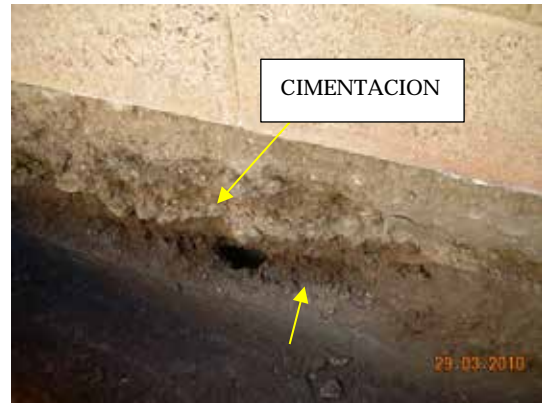
Fotografía 490. Colocaron la cimentación sobre este soporte de bloques huecos y restos de antrópicos (escombros).
