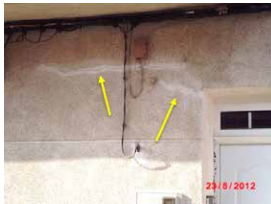
Fotografía 318. Existencia de grietas antiguas ya reparadas.
