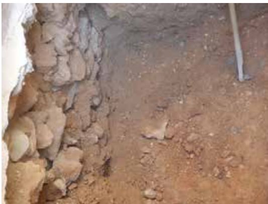
Fotografía 431. Se observa el estado de la cimentación, hecha de mampostería.
