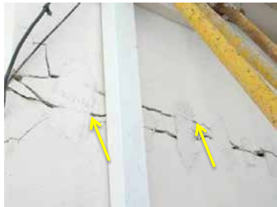
Fotografía 384. Se aprecian algunos testigos de yeso fisurados colocados anteriormente.
