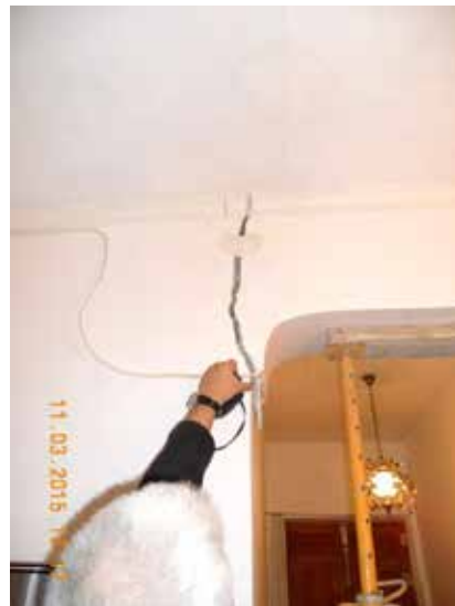
Fotografía 85. Medición de la grieta.
