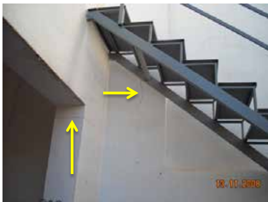
Fotografía 363. Grietas horizontales y verticales en el patio.
