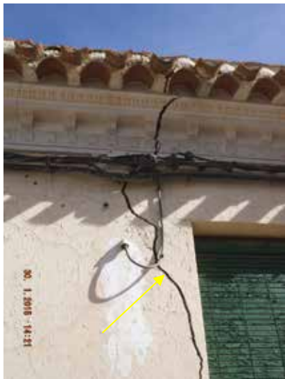
Fotografía 56. Grieta oblicua en la fachada calle Arapiles
