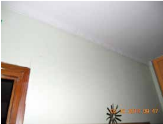
Fotografía 351. Fisura que parte del marco de la puerta de una de las habitaciones.
