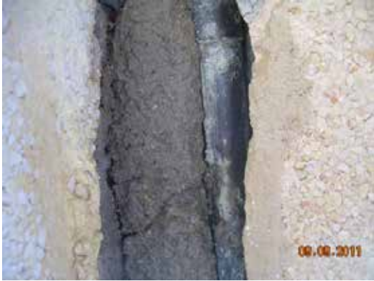
Fotografía 425. Detalle de avería en conducción interior de cobre.
