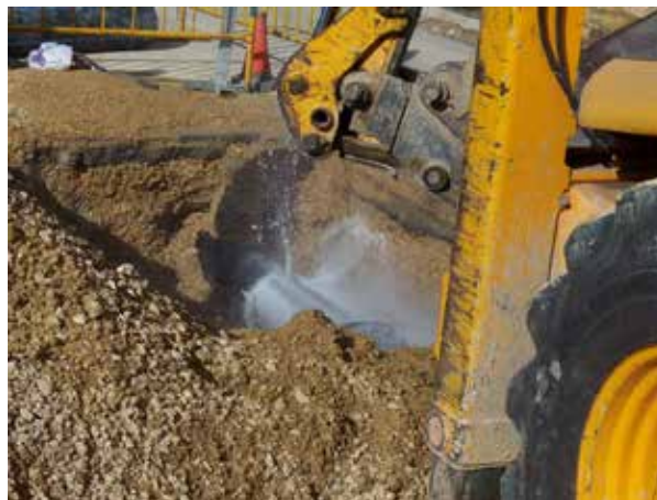
Fotografía 12. Rotura de una red a presión de agua potable
