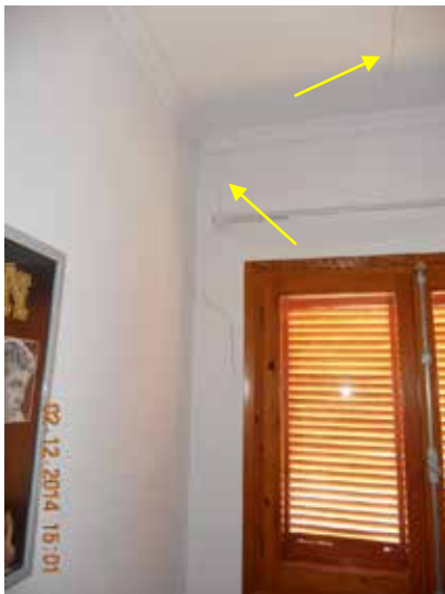
Fotografía 273. Fisuras en una de las habitaciones.
