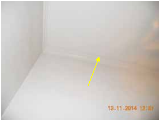
Fotografía 280. Leve fisura en el hueco de la escalera.
