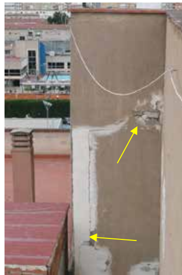
Fotografía 197. Testigo de yeso desprendido y fisurado.
