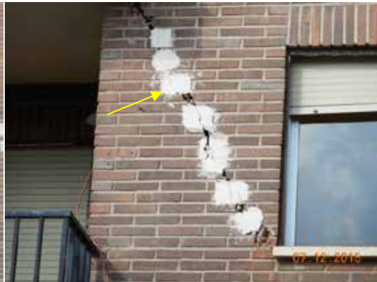
Fotografía 175. Misma fotografía de la grieta anterior tomada 07/12/2015 con el testigo de 21/8/2014 sin fracturar.
