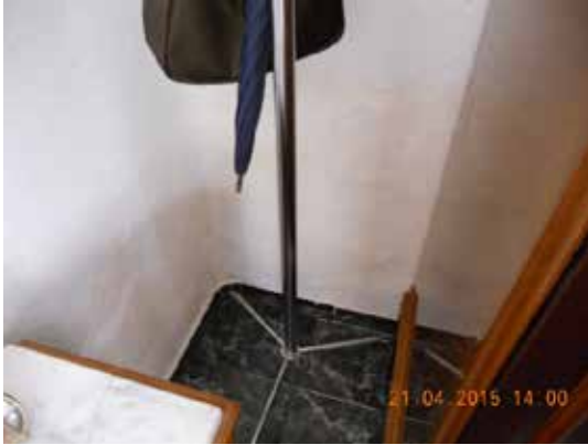
Fotografía 122. Restos de humedades y reparaciones anteriores.
