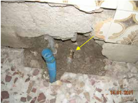
Fotografía 32. Se observa una pieza de latón donde se reparó la avería.
