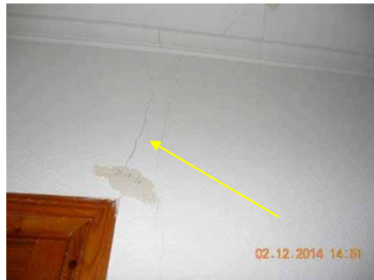
Fotografía 252. Fisura estabilizada en puerta de la cocina.
