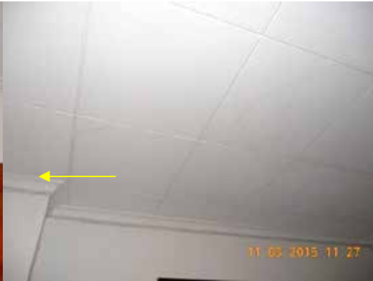
Fotografía 142. Pequeñas fisuras nuevas.
