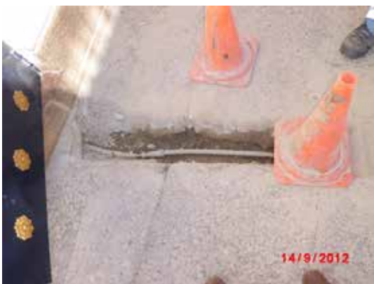
Fotografía 435. Acometida ya reparada, se observa humedad en la zona.
