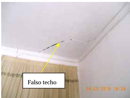
Fotografía 68. Las grietas en el falso techo indican que la estructura se ha movido.
