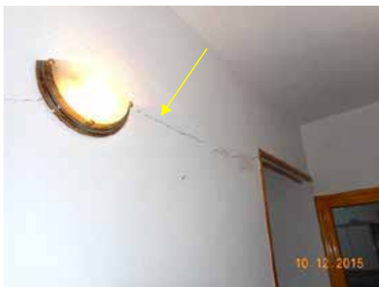
Fotografía 596. Grieta oblicua en el pasillo que accede al baño.
