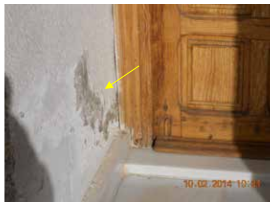
Fotografía 473. Porche de la entrada secundaria, donde se aprecian manchas de humedades antiguas.
