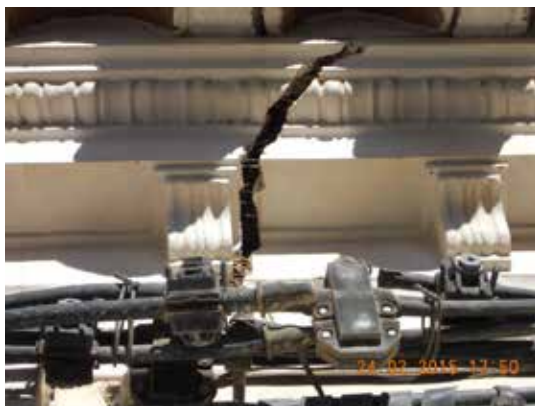
Fotografía 60. Detalle de la grieta en la cornisa.
