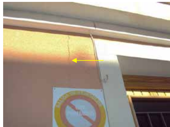
Fotografía 527. Misma fisura tomada 25/04/2016.
