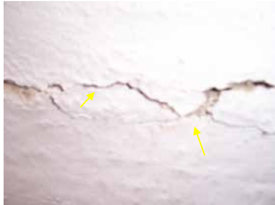
Fotografía 245. En Octubre la misma fisura se había hecho más grande.
