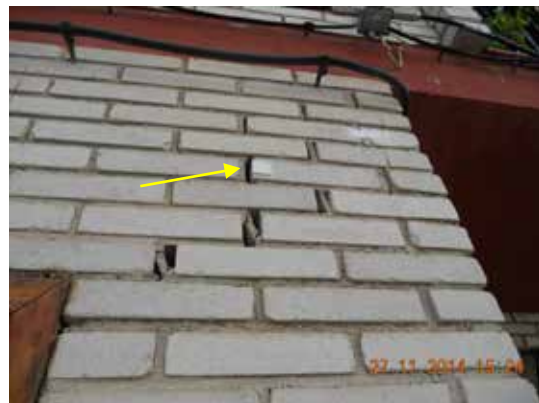
Fotografía 227. Mismo testigo que la Fotografía 226, tomado el 27 de noviembre. Se ha fracturado en solo 15 días.
