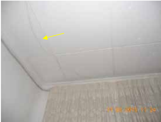
Fotografía 133. Fisuras en el falso techo de la habitación sur junto a la fachada.
