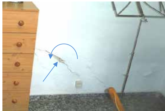
Fotografía 191. Grietas inclinadas unos 45°.
