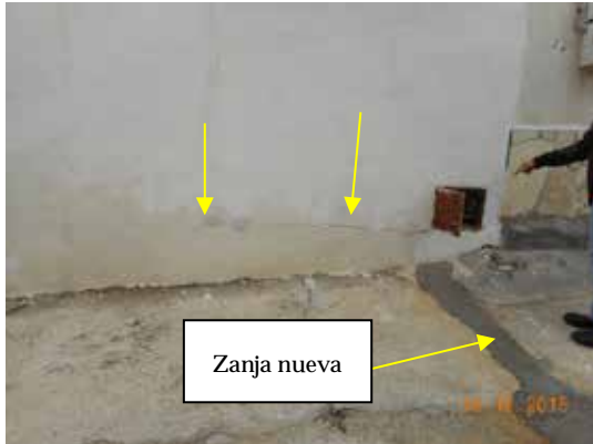
Fotografía 594. Fisuras que coinciden con el hueco de la cajera del contador.
