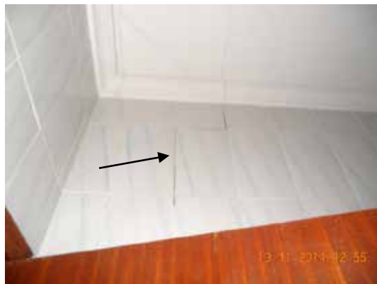
Fotografía 291. Las juntas de los azulejos del aseo del cuarto de baño de la 1º planta se han abierto levemente.
