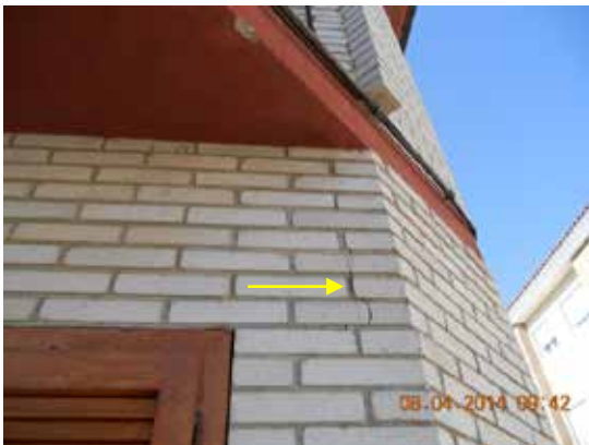
Fotografía 222. Muro donde se encuentra la puerta de entrada donde se aprecia una fisura leve, tomada en abril.
