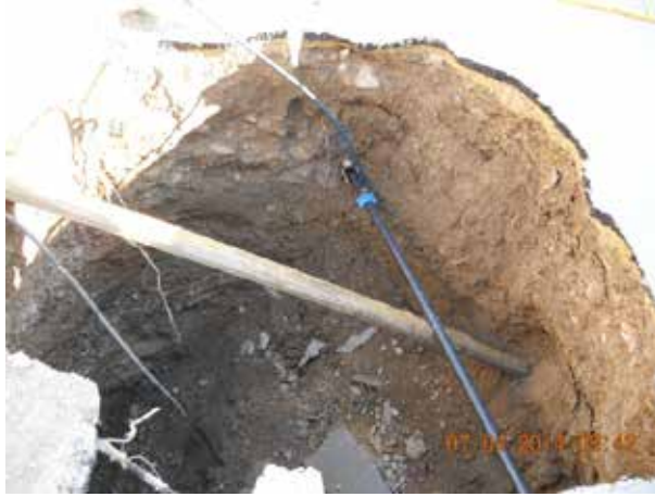
Fotografía 13. Socavón provocado por una rotura sobre la calzada, provocando daños a un aljibe cercano que hubo de derruir.
