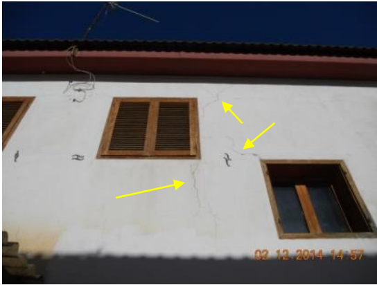
Fotografía 263. Resto de fisuras en el muro de la vivienda que da al patio.
