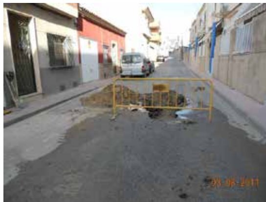
Fotografía 424. Situación donde se encontró una acometida de abastecimiento averiada.
