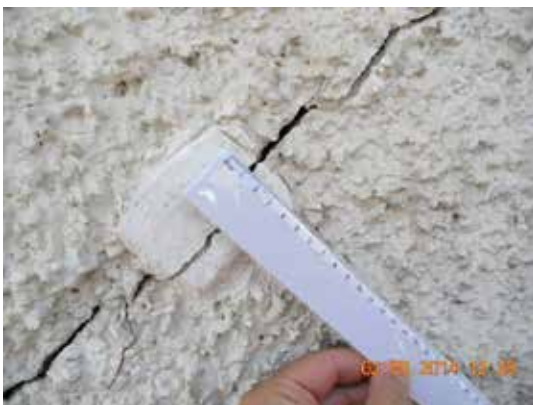
Fotografía 345. En septiembre se midió la apertura de la grieta más abierta.
