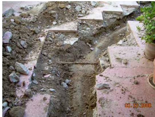
Fotografía 367. Tubería de acero galvanizado donde se ha encontrado una avería.
