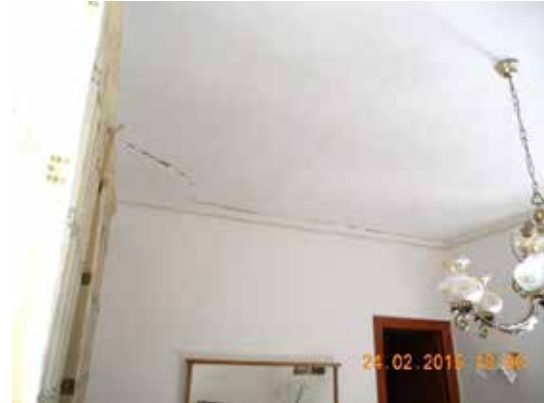
Fotografía 71. Vista general de la grieta del comedor.
