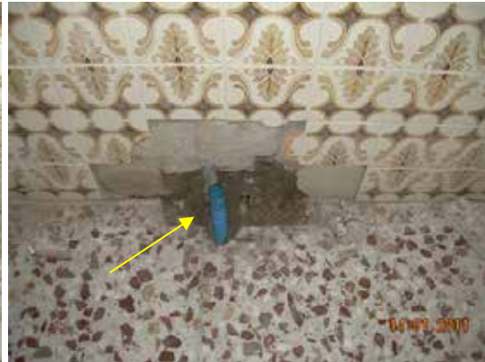
Fotografía 33. Vista completa de la zona de la avería interior.
