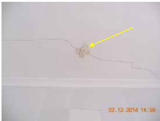
Fotografía 269. Detalle del testigo del techo que se ha fracturado.
