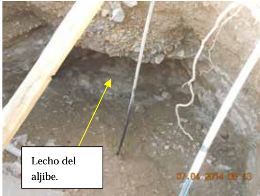
Fotografía 558. El lateral del aljibe resultó afectado.
