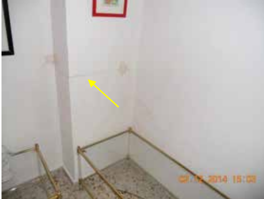
Fotografía 275. Estas fisuras son posiblemente las de mayor tamaño de toda la vivienda.
