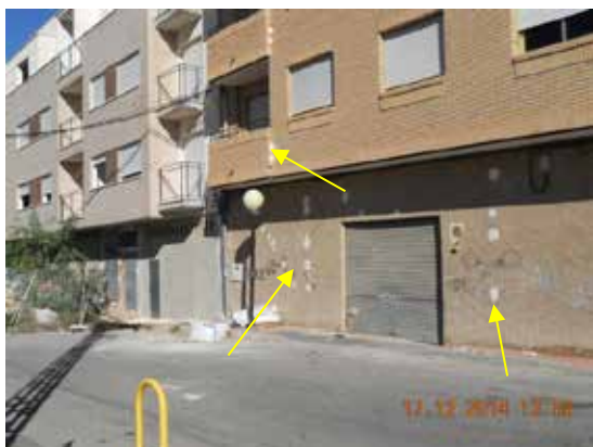
Fotografía 152. Se observan los testigos en el bajo y en los salientes de las balconadas.
