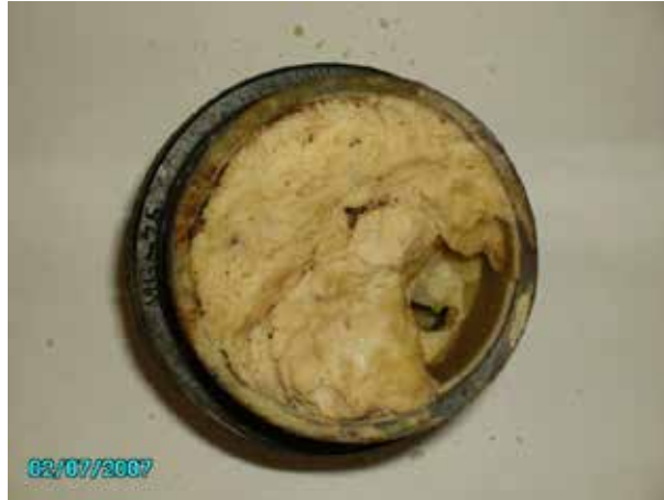
Fotografía 4: Unión Gibault fracturada por la acumulación de carbonato cálcico. Véase la obstrucción cuasi-total del conducto.
