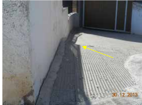
Fotografía 510. Socavón en la rampa de bajada al garaje.
