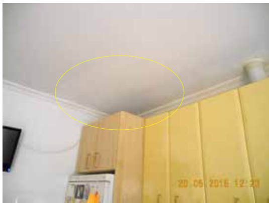
Fotografía 588. Humedades en el techo síntoma de existencia de alguna filtración de la cubierta.
