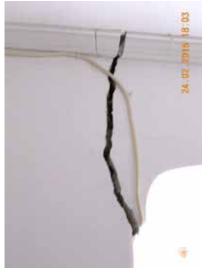
Fotografía 67. La entidad de la grieta hace pensar en que esa parte de la estructura tiene daños importantes.
