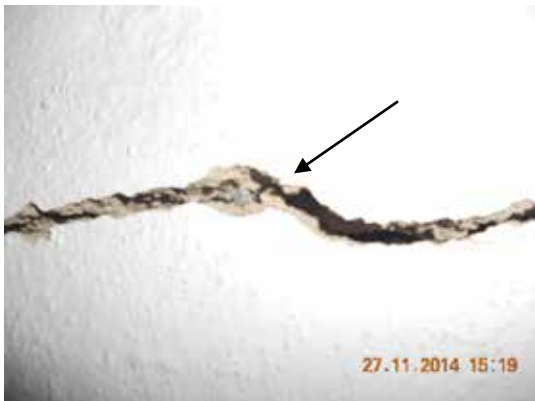
Fotografía 301. En la fisura no se aprecian resto de suciedad lo cual indica que es reciente.
