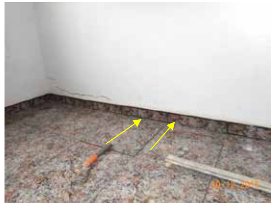
Fotografía 599. Se aprecia en el rodapié el descenso generalizado del solado del dormitorio 1.
