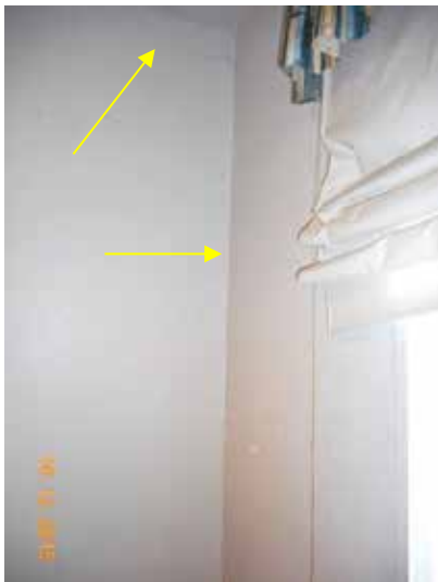
Fotografía 608. Fisuras en la parte superior izquierda del dormitorio 2.
