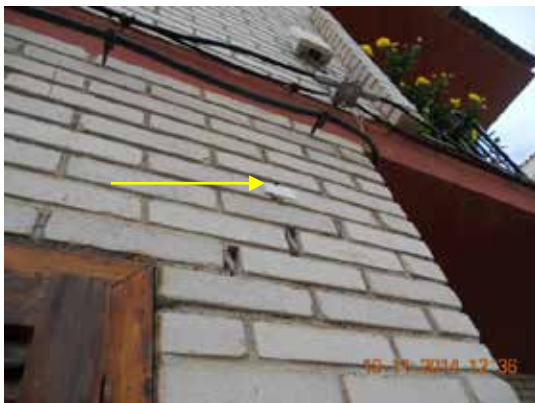
Fotografía 226. Misma grieta que la Fotografía 216 tomada el 13 de noviembre, con un testigo de yeso sin fracturar.
