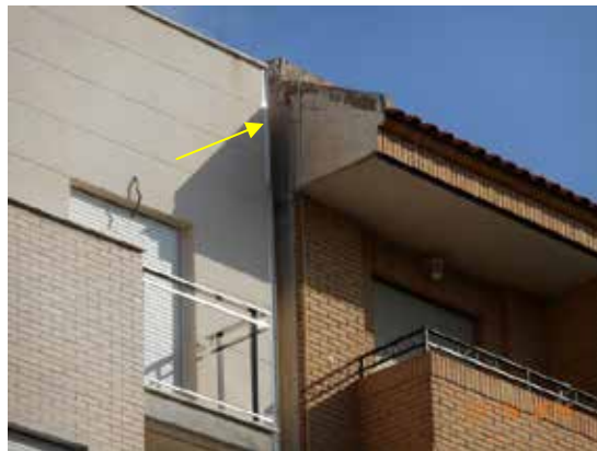
Fotografía 185. Misma separación tomada el 07/12/2015.
