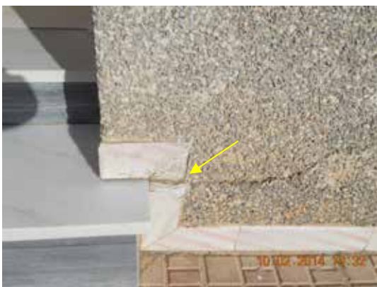
Fotografía 472. La parte que une el peldaño con el muro ha sido reparada con anterioridad.
