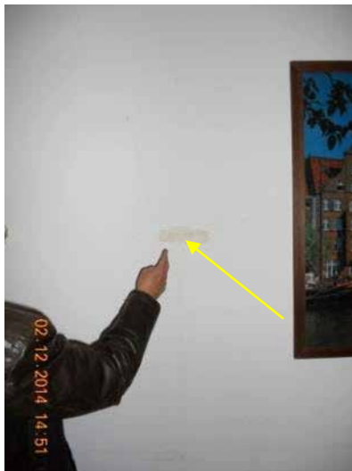
Fotografía 251. Detalle de testigo colocado sin fisurar, junto puerta entrada.
