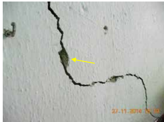
Fotografía 302. La forma de la fisura indica que se ha producido por la unión entre los bloques que forman el muro.
