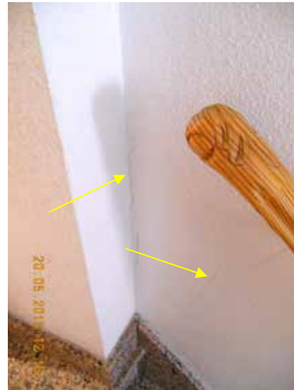
Fotografía 583. Fisuras junto a un pilar.
