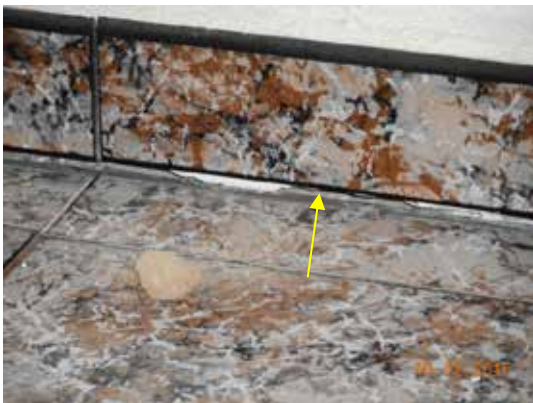
Fotografía 600. Hueco que ha quedado entre el suelo y el rodapié.
