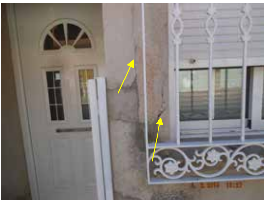
Fotografía 499. Fisuras en el recerco de la ventana anteriores a la rotura.
