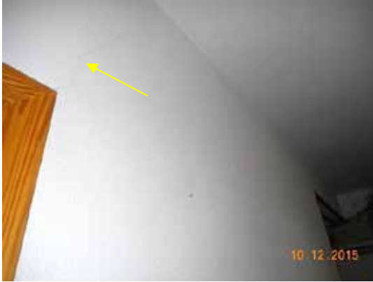
Fotografía 610. Fisura encima del marco de la puerta del dormitorio 3 (matrimonio).
