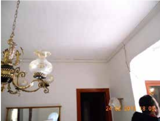
Fotografía 70. La grieta atraviesa todas las estancias.
