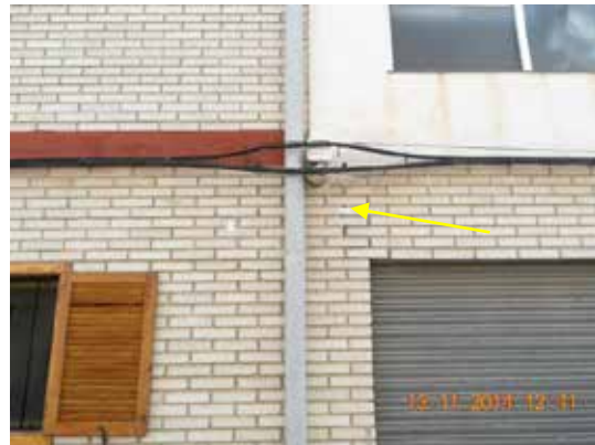
Fotografía 225. Misma fisura que la Fotografía 224 tomada en noviembre. No se aprecian apenas diferencias.
