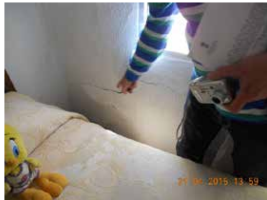
Fotografía 117. Grieta oblicua en la habitación norte que da al muro de la fachada.
