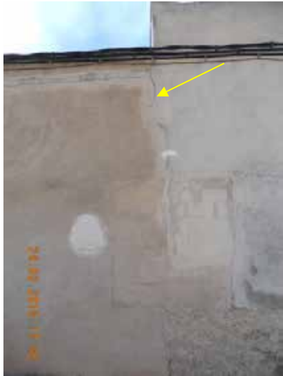
Fotografía 58. Fisuras en la unión entre obras de diferente antigüedad calle Parricas
