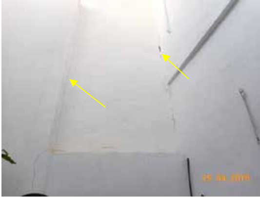
Fotografía 524. Fisuras en la juntas de los edificios.
