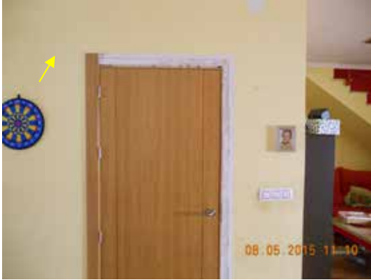
Fotografía 505. Fisura reciente que indica giro hacia la calle.
