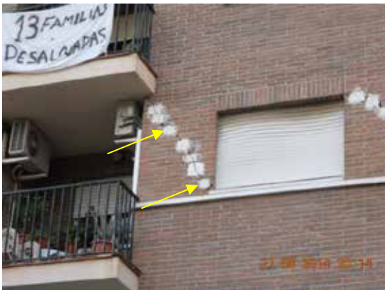
Fotografía 172. Grieta segunda planta con testigo del día 21/8/2014 sin fracturar.
