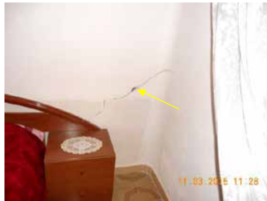
Fotografía 144. Grieta en la medianera con la vivienda n° 61.
