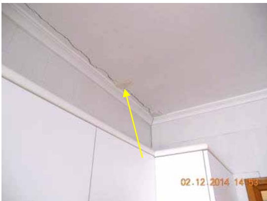
Fotografía 255. Parte derecha de la cocina donde la fisura es de mayor amplitud.
