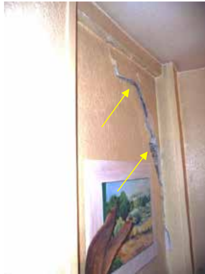
Fotografía 214. Paramento dislocado entre el pórtico.
