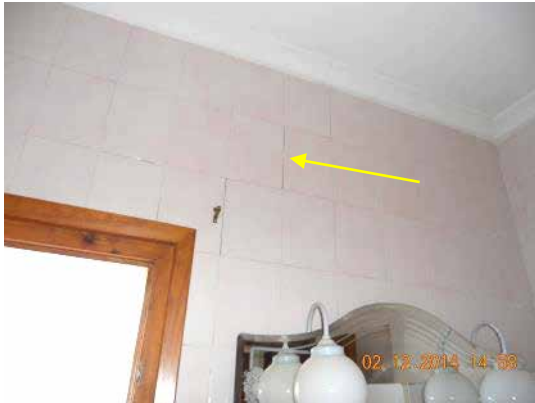
Fotografía 267. Fisuras que coinciden con la escuadra del marco de la puerta.
