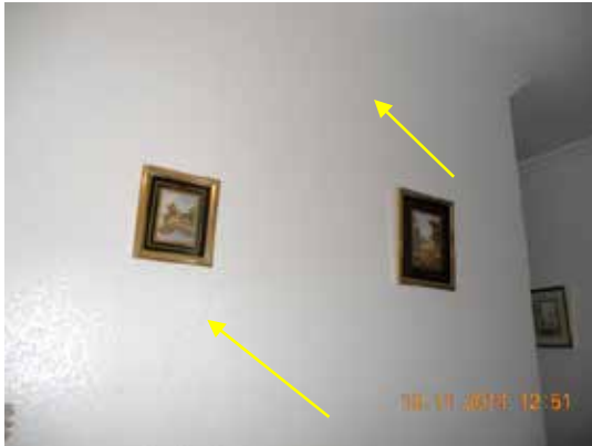
Fotografía 282. Fisura oblicua en el pasillo de la primera planta.
