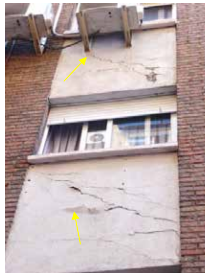
Fotografía 203. Vista parcial de la fachada con grietas y zonas que no han aguantado la presión.
