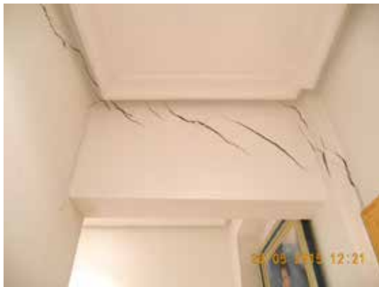
Fotografía 584. Colapso parcial del enlucido de la viga y el pilar.
