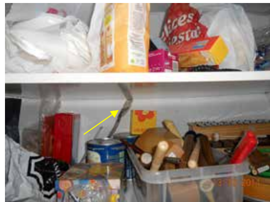
Fotografía 626. Grieta al fondo del armario empotrado.
