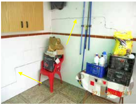
Fotografía 295. Fisuras en los paramentos verticales medianeros.
