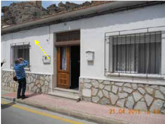
Fotografía 114. Fisuras que nacen el hueco de la ventana sur.
