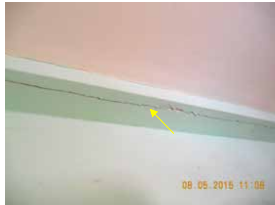
Fotografía 504. Grieta en la escayola que cubre una viga.
