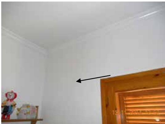
Fotografía 284. Fisura en ventana de la primera planta.
