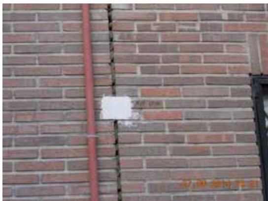
Fotografía 160. Testigo intacto colocado el 18/08/2014 a las 17:00.
