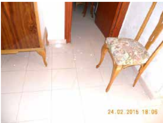
Fotografía 72. Restos de trozos de yeso caídos del falso techo, señal de que son recientes.
