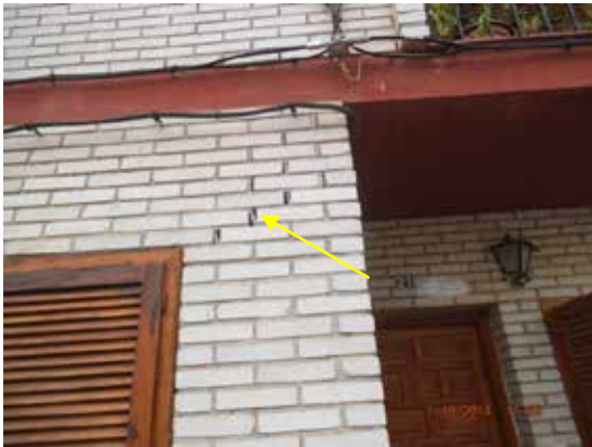
Fotografía 216. Grietas más considerables observadas en la fachada junto a la puerta de entrada.
