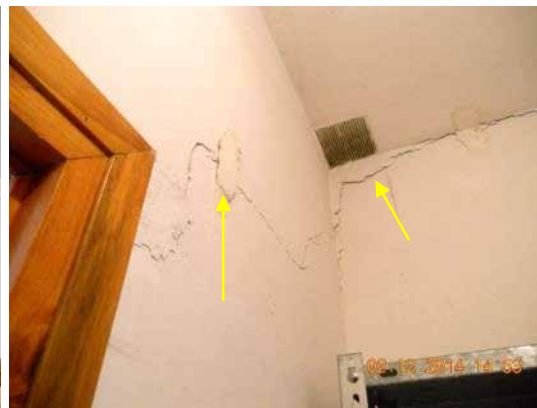
Fotografía 256. Fisuras en el interior de la despensa.
