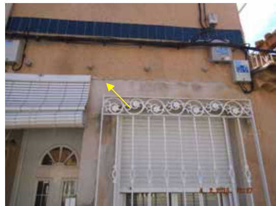
Fotografía 500. Fisura paralela al dintel de la puerta y la ventana.
