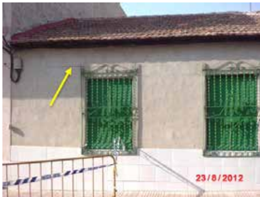
Fotografía 314. Grietas en la fachada del n°19.
