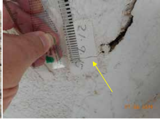
Fotografía 481. Testigo fisurado de fecha 21/09/15.
