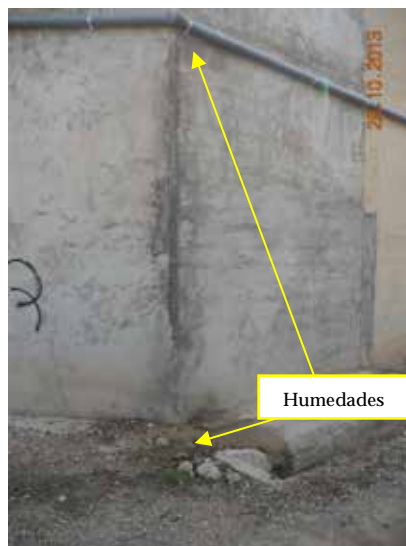
Fotografía 397. Humedades de las lluvias de los últimos días.
