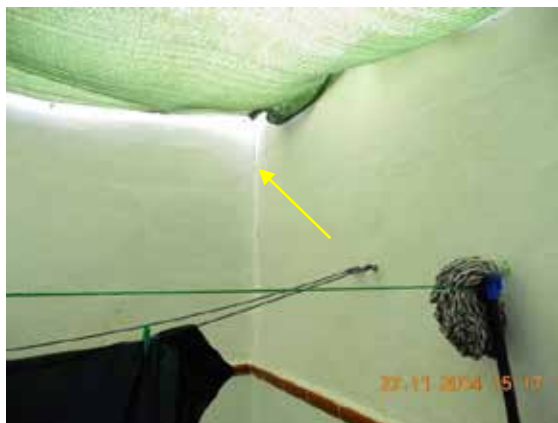
Fotografía 297. Fisura en el encuentro de las 2 paredes.
