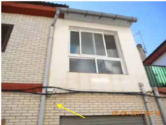
Fotografía 224. La fisura sobre la puerta del garaje, tomada en abril.
