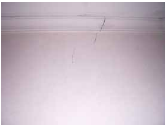
Fotografía 103. Grieta oblicua en el dormitorio.
