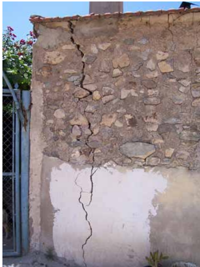
Fotografía 451. Grieta que ya había sido reparada con anterioridad.
