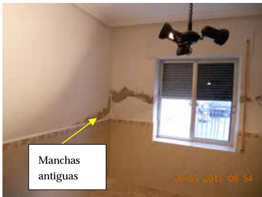
Fotografía 578. Humedades por capilaridad antiguas.
