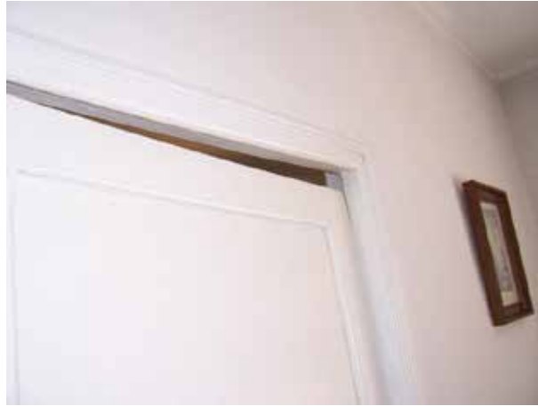
Fotografía 10. Se aprecia que en ese extremo del marco de la puerta de madera y contrachapado, se producido una elevación como de unos 5 cm, dejando un hueco importante.
