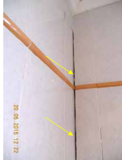
Fotografía 587. Grietas de 10mm en el alicatado.
