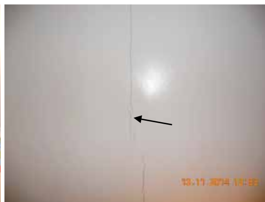
Fotografía 287. La fisura continua a lo largo del techo de esa habitación, siguiendo una línea recta
