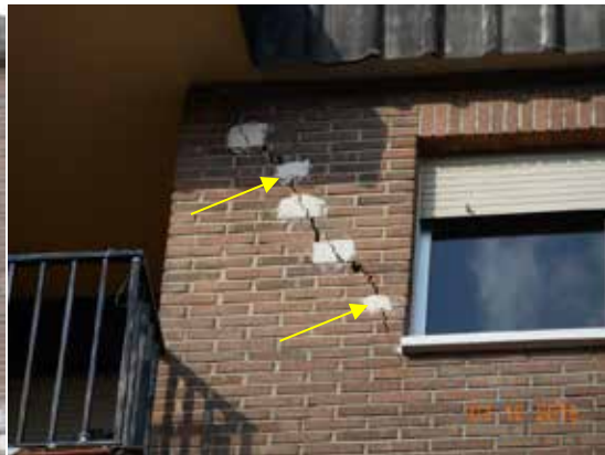
Fotografía 171. Misma fotografía de la grieta anterior tomada 07/12/2015 con el testigo de 21/8/2014 sin fracturar.
