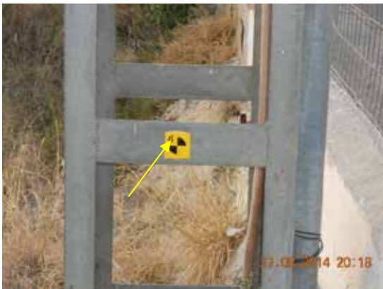
Fotografía 156. Marca topográfica de referencia situado en un poste de tendido eléctrico de baja tensión.
