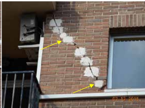
Fotografía 173. Misma fotografía de la grieta anterior tomada 07/12/2015 con el testigo de 21/8/2014 sin fracturar.
