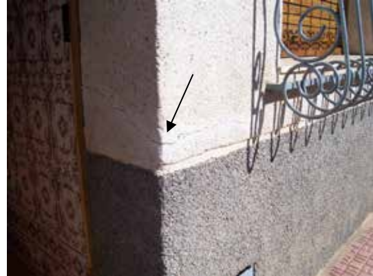
Fotografía 96. Grieta en el muro de la fachada principal.
