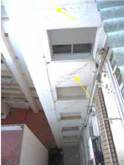
Fotografía 188. Grietas en el patio de luces del edificio.
