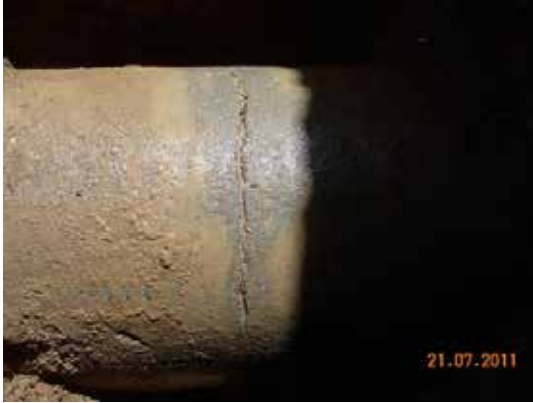
Fotografía 420. Fisura encontrada en la conducción de hormigón de la red de saneamiento.
