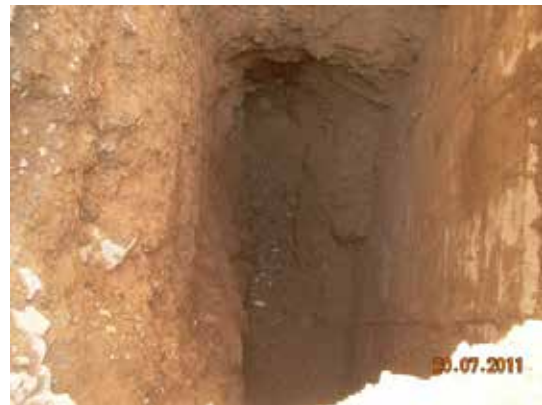
Fotografía 415. Detalle de la cata realizada donde se aprecia la ausencia de humedad.
