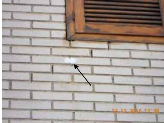
Fotografía 221. Misma fisura que la Fotografía 220 con un testigo de yeso no fracturado a fecha 13 de noviembre de 2014.
