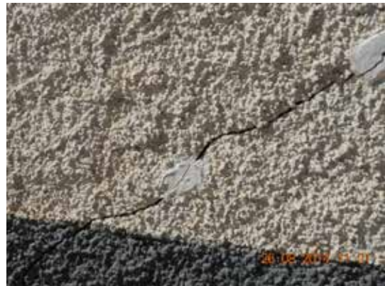
Fotografía 336. Testigo fisurado en la misma grieta oblicua.
