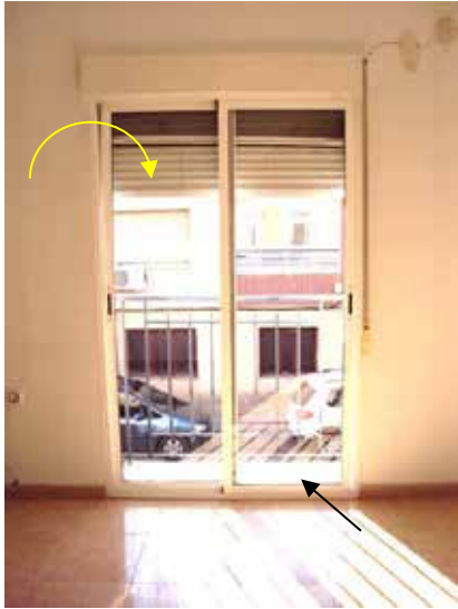
Fotografía 540. Detalle marco puerta descajado, tomada 25/04/2016.
