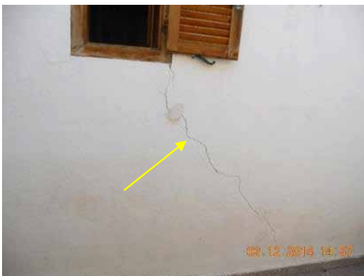
Fotografía 261. Fisuras en la ventana del aseo de la planta baja.
