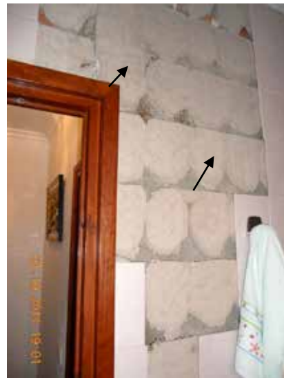
Fotografía 247. En el aseo se habían desprendido los azulejos de una superficie aproximadamente del 20% del total.
