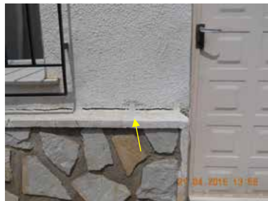
Fotografía 113. Testigo del día 4 de diciembre fisurado.
