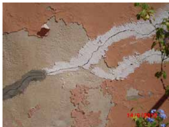
Fotografía 436. Testigos fracturados en los muros de carga.
