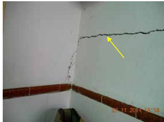
Fotografía 300. Fisura más amplia de toda la vivienda, unos 5 mm
