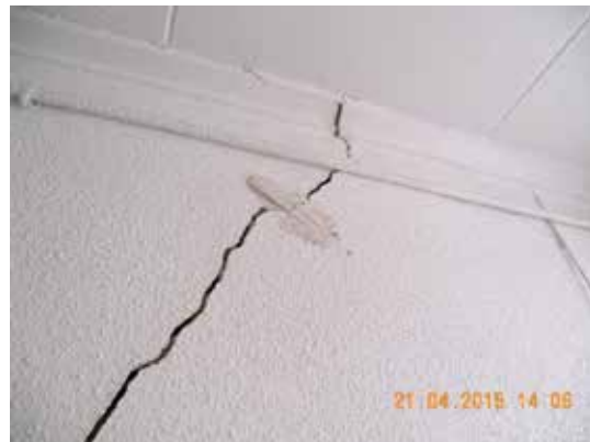
Fotografía 129. El testigo colocado el 4 de diciembre de 2014 se ha fisurado.
