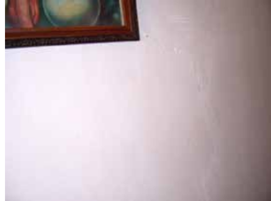
Fotografía 110. Continuidad de la grieta hasta el solado.
