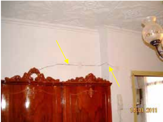
Fotografía 24. Se observan grietas a la altura del dintel de la puerta. Se han colocado testigos de yeso para el seguimiento de posibles movimientos.
