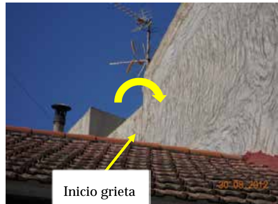
Fotografía 324. Se comprueba que la grieta que marca el giro del edificio está a ambos lados del edificio.
