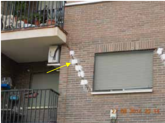
Fotografía 174. Grieta primera planta con testigo del día 21/8/2014 sin fracturar.
