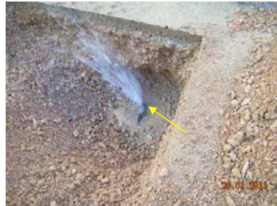
Fotografía 44. La segunda avería en otra acometida de abastecimiento.
