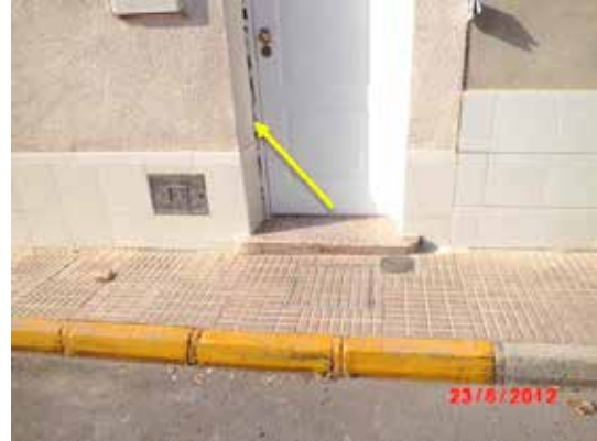
Fotografía 317. Se aprecia que el marco de la puerta de entrada se ha despegado de la mocheta.
