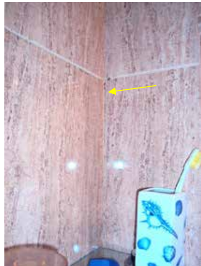
Fotografía 543. Junta desprendida, tomada 25/04/2016.
