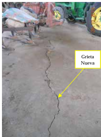
Fotografía 409.- Grieta longitudinal paralela al muro donde se produjo la avería.
