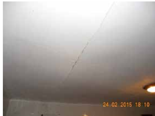
Fotografía 75. El falso techo de la cocina interior ha cedido al límite de su resistencia.
