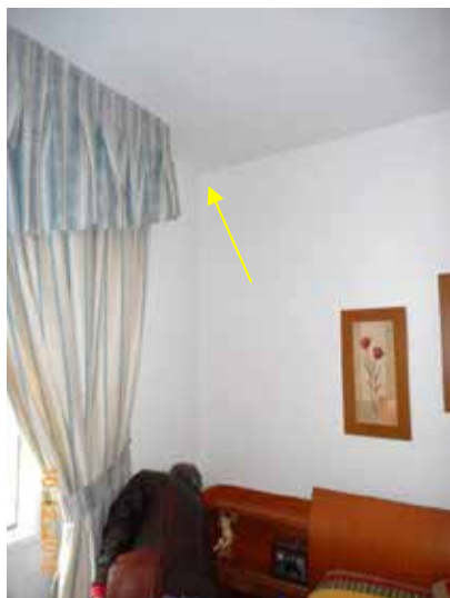
Fotografía 612. Esquina superior derecha del dormitorio 3 sin fisuras.
