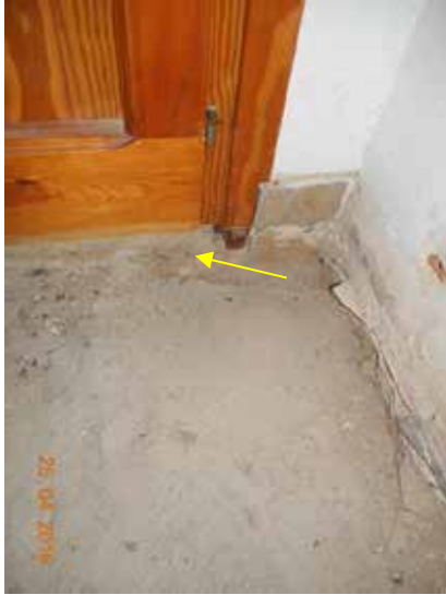
Fotografía 520. Base del marco de la puerta descalzado.
