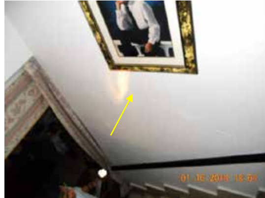
Fotografía 241. Continuación de la fisura del hueco de las escaleras que dan acceso a la primera planta.
