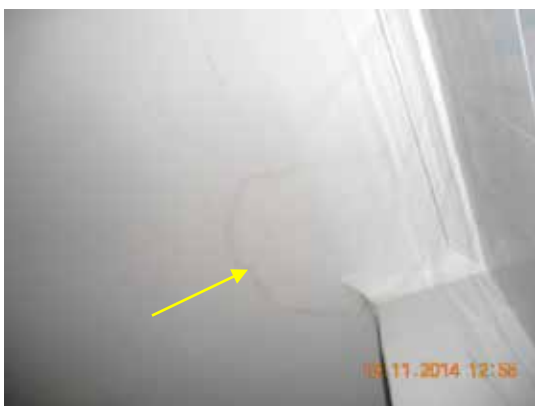
Fotografía 292. Mancha de humedad proveniente de la cubierta, síntoma de filtraciones de agua de lluvia.
