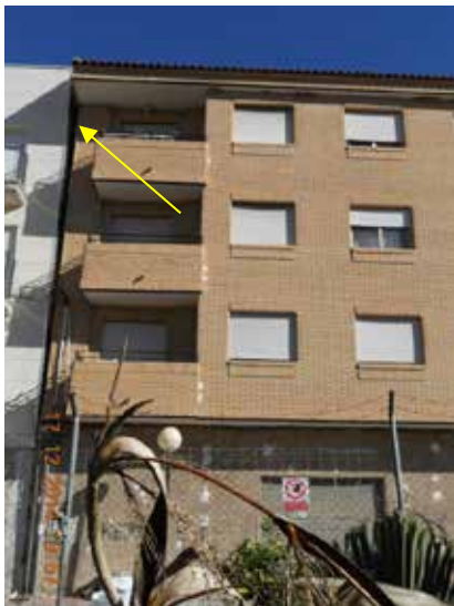
Fotografía 184. Separación entre ed. Jofi II y contiguo en construcción.
