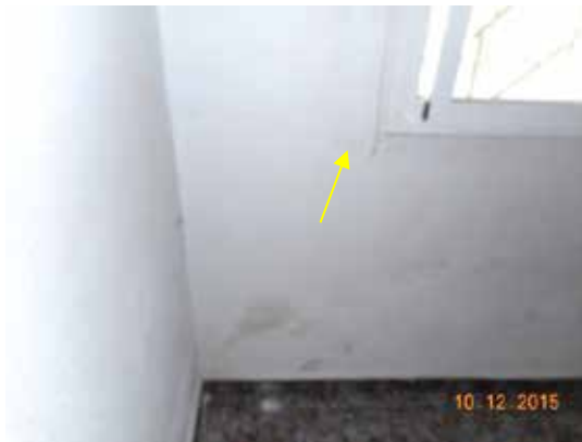
Fotografía 602. Fisura que termina en el hueco de la ventana.
