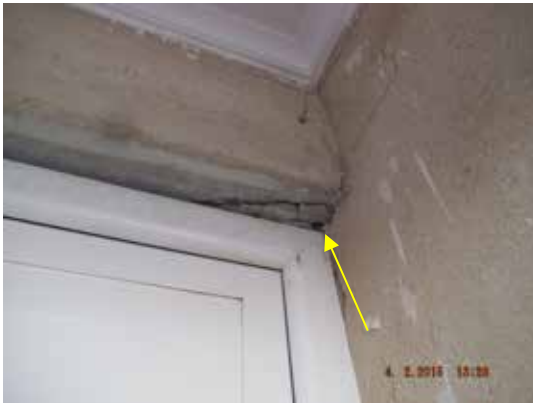
Fotografía 501. Parte del mortero de sujeción desprendido.
