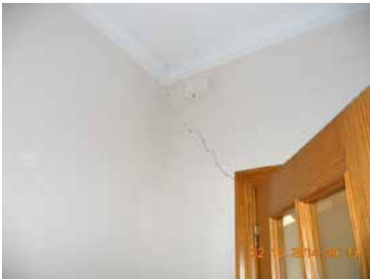
Fotografía 347. Grieta localizada en la puerta del comedor.
