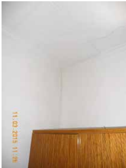
Fotografía 135. Fisura en la esquina de las paredes de la habitación.
