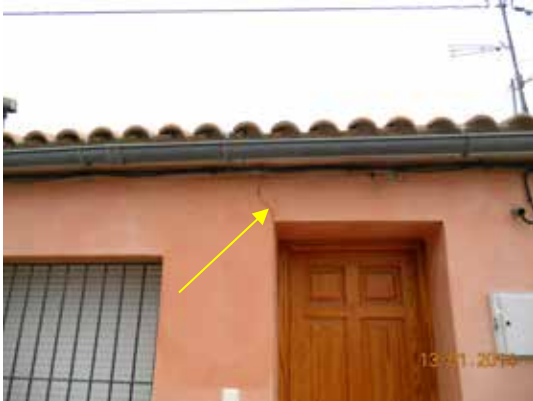
Fotografía 455. Grieta oblicua en la fachada Suroeste.
