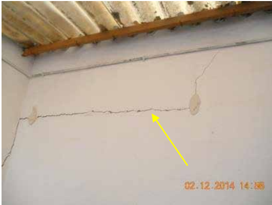
Fotografía 259. Fisuras en el tabique colindante en el patio con la vivienda n° 21.
