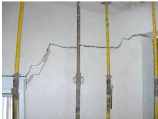
Fotografía 383. Grietas el 16 de septiembre de 2005, dentro de la vivienda afectada.
