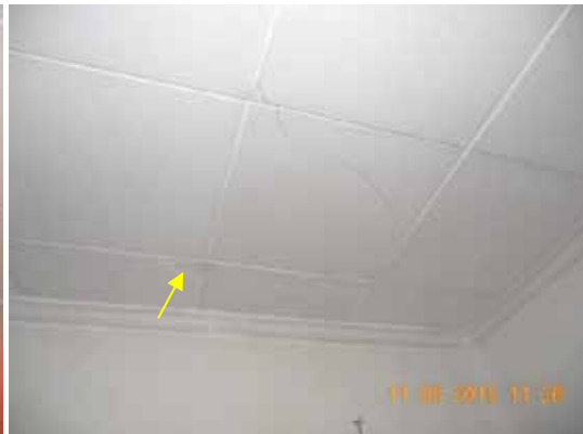
Fotografía 140. Fisuras nuevas y antiguas reparadas.
