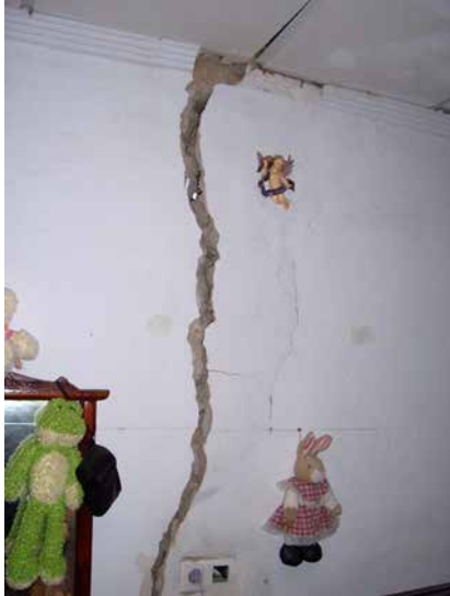
Fotografía 453. Interior de la habitación afectada, grieta existente de 85 mm.
