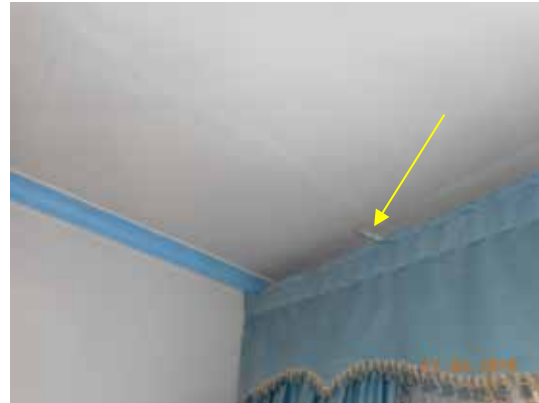
Fotografía 485. Humedades y fisuras repintadas en el techo de la misma habitación.
