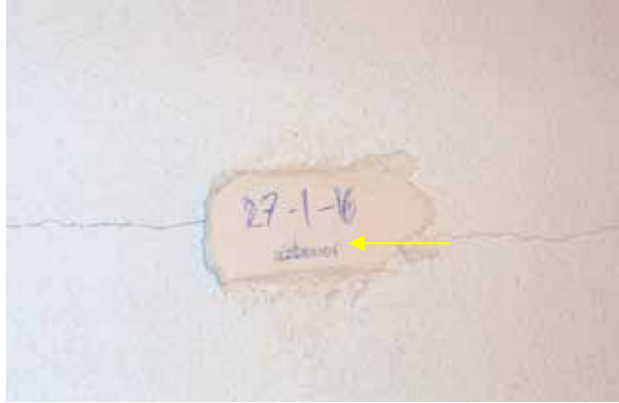
Fotografía 533. Mismo testigo modificado, tomado 25/04/2016.
