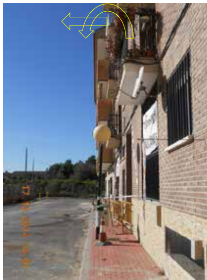
Fotografía 186. Inclinación del edificio Jofi II.
