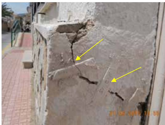
Fotografía 112. Grietas en el muro de fachada
