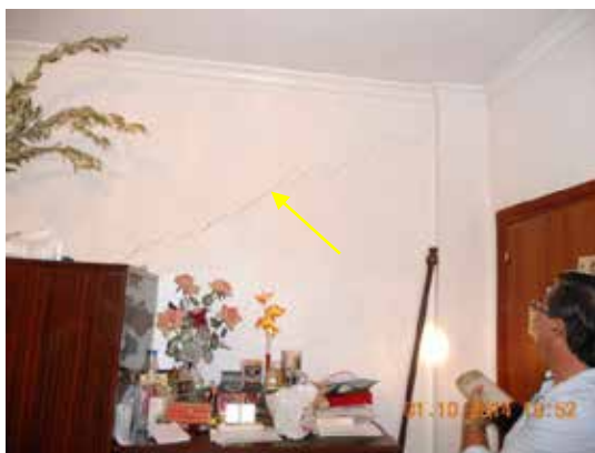
Fotografía 238. Fisuras en la habitación de la primera planta.
