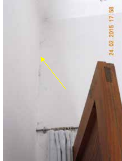
Fotografía 63. Fisura al otro extremo de la puerta de entrada.
