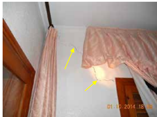
Fotografía 243. Grieta en la habitación que da a la fachada.
