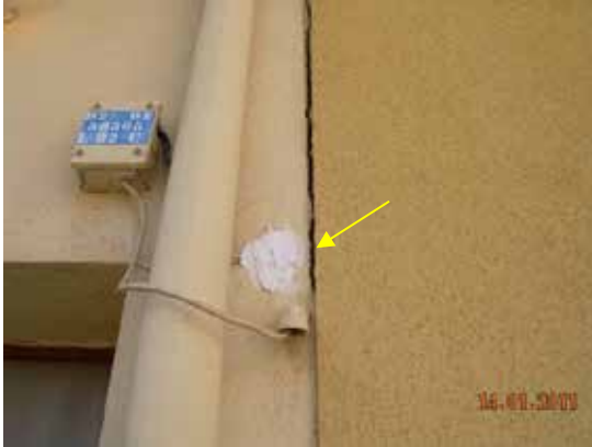
Fotografía 36. Testigo de yeso de seguimiento de una grieta en fachada.
