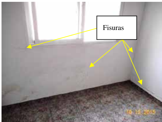
Fotografía 604. Fisuras en el dormitorio 1.
