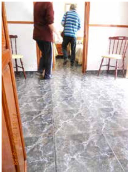
Fotografía 116. Junta del solado de gres que se ha abierto.
