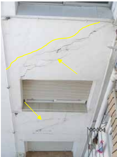
Fotografía 190. Grietas entre los huecos de las ventanas del patio de luces.
