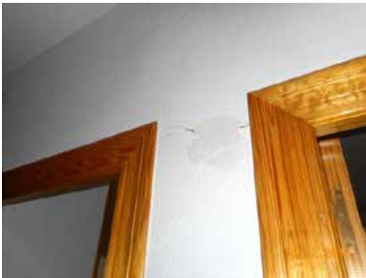
Fotografía 598. Testigo intacto entre las puertas de los Dormitorios 1 y 2.
