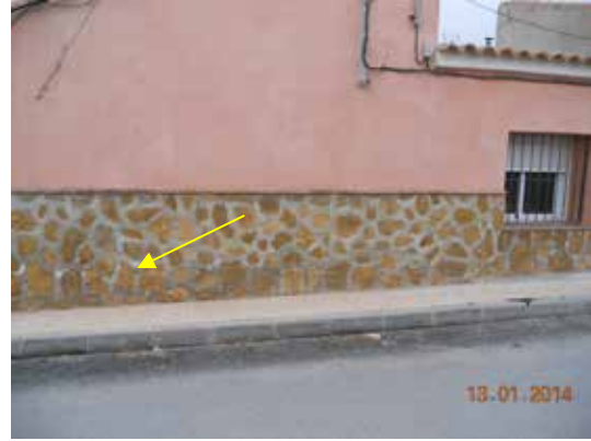
Fotografía 460. Restos de eflorescencias.
