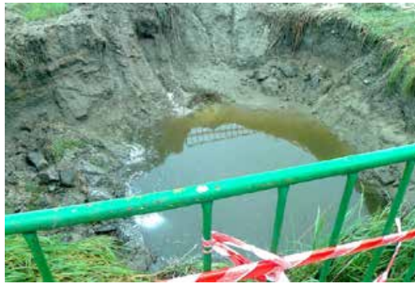
Ilustración 14.- Socavón con aguas negras. (Servicio Navalmoral de la Mata, 2014)
