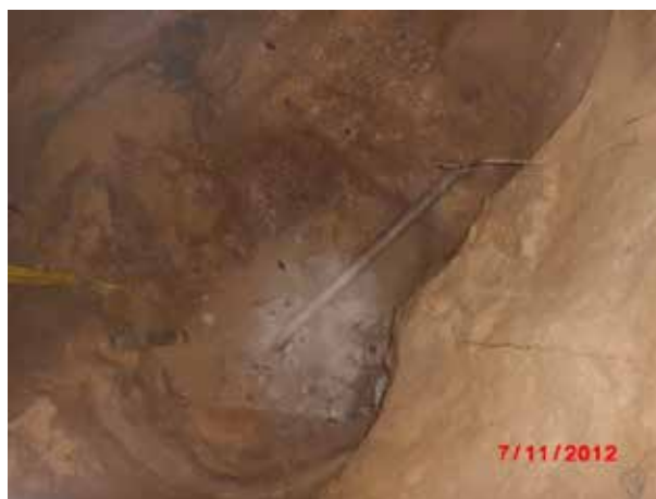
Fotografía 14. Socavón de 7 metros de profundidad, 3 de ancho y 8 de largo. En el fondo se aprecia la tubería de abastecimiento de fibrocemento desprendida.
