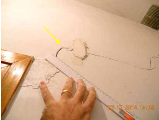
Fotografía 257. La fisura junto a la puerta de la despensa mide 4mm.
