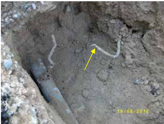
Fotografía 311. La acometida se cortó durante la excavación con retroexcavadora.
