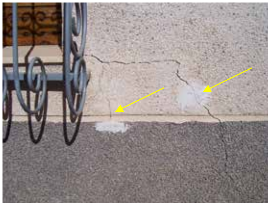
Fotografía 93. Grietas en el hueco de la ventana
