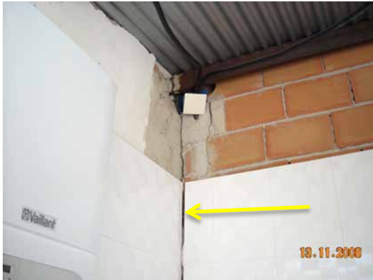
Fotografía 368. Grieta vertical de 2 cm en el número 12, primera planta.
