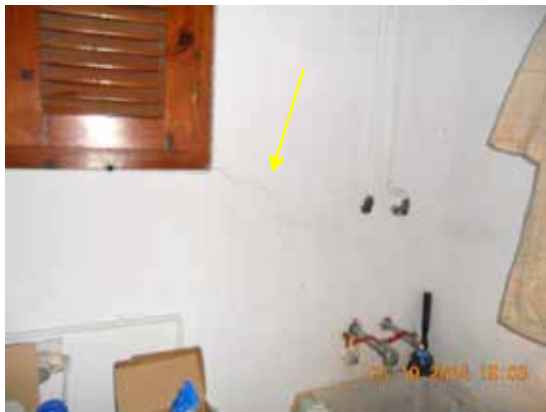
Fotografía 246. Fisuras en patio junto a la ventana del aseo.
