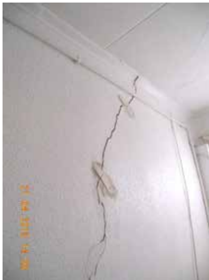
Fotografía 128. Grieta en el pasillo que da acceso a la cocina desde la entrada auxiliar a la vivienda.
