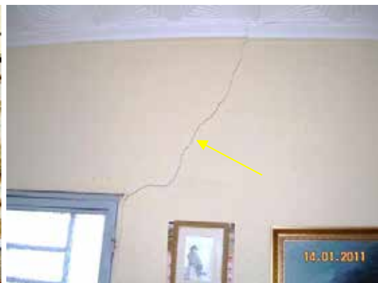
Fotografía 35. Grieta inclinada que parte del encuentro del hueco de la puerta.
