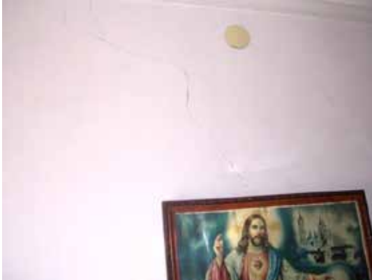
Fotografía 109. Paramento vertical de una habitación totalmente agrietado.
