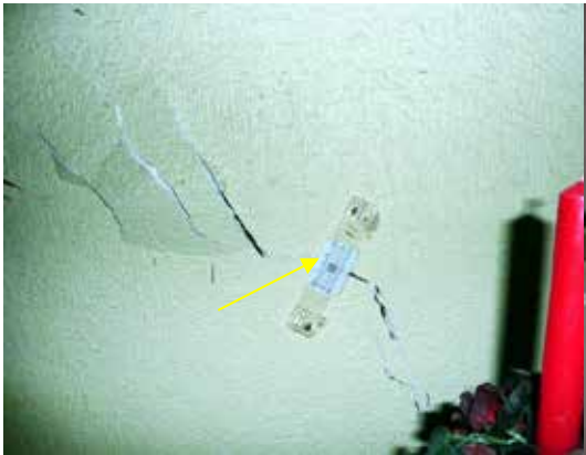
Fotografía 210. Fisurómetro sobre grieta interior.
