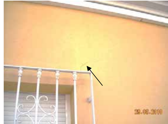
Fotografía 494. Se aprecian unas pequeñas fisuras en la fachada, con origen en las esquinas de los huecos de las ventanas.
