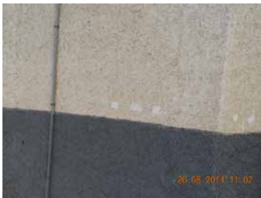
Fotografía 331. Grieta horizontal en la esquina del edificio
