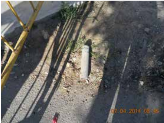
Fotografía 554. Tramo de la tubería que se fracturó cerca de una unión.
