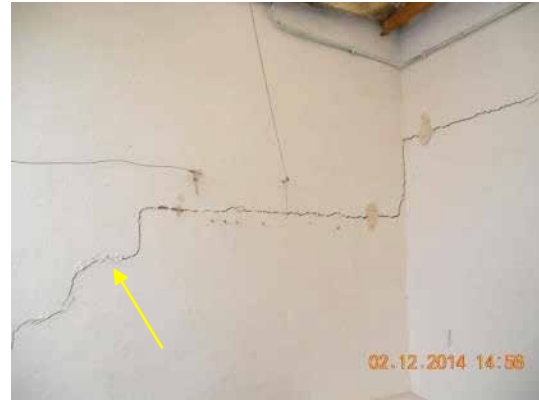
Fotografía 260. Se aprecia que las fisuras pueden responder a un asiento diferencial.
