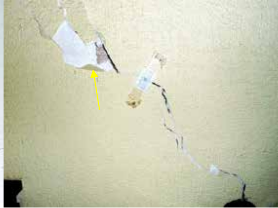
Fotografía 209. Parte del yeso de la pared se ha desprendido por la presión ejercida.
