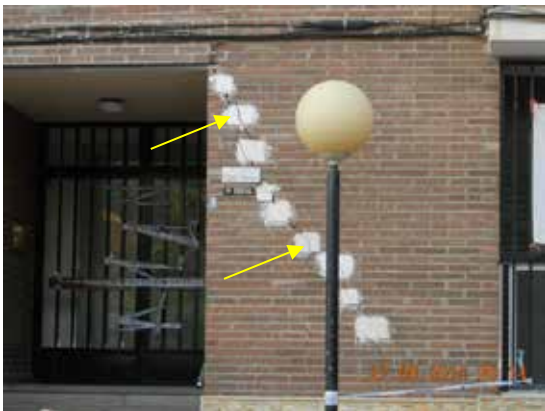
Fotografía 180. Grieta planta baja con todos los testigos fracturados.
