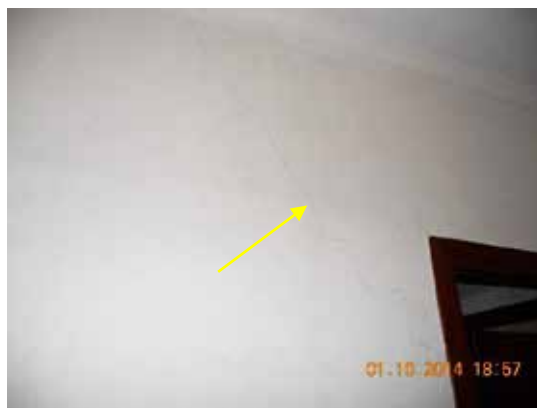
Fotografía 239. Fisura inclinada en la primera planta.
