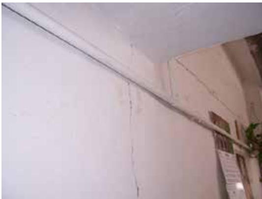
Fotografía 101. Grieta vertical en el pasillo de acceso desde la entrada al patio.
