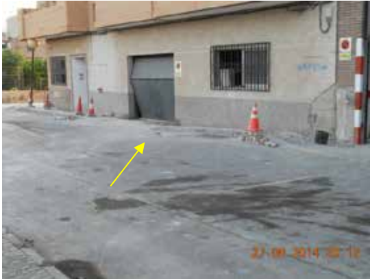
Fotografía 166. Desnivel del terreno entre las entradas a los garajes de los dos edificios.
