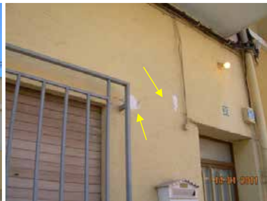
Fotografía 39. Grieta en fachada entre dintel de la puerta y el de la ventana.
