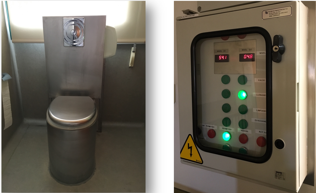
Fig. 8. Inodoro de la habitación radioprotegida y panel de control del sistema de recogida de residuos radioactivos líquidos de la UTM del hospital Quironsalud Torre Vieja
