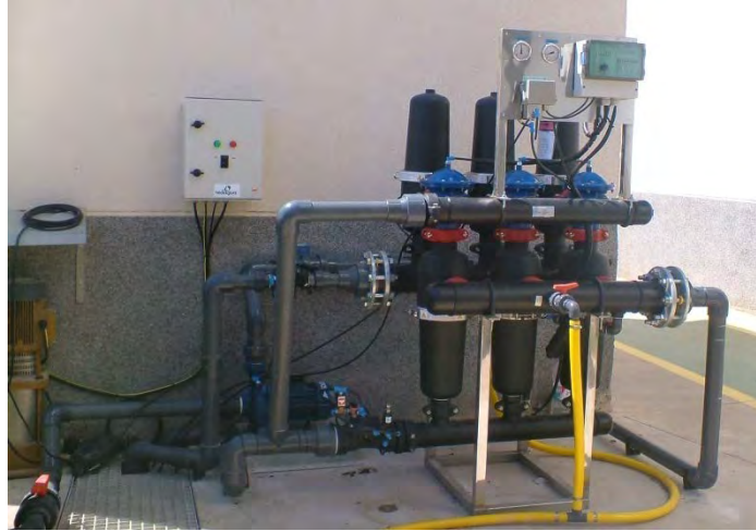
Imagen 1. Filtros de anillas instalados en la EDARI
