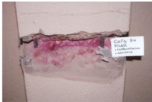
Figura 2: Cata realizada en pilar. Comprobación de la profundidad de carbonatación. (Fuente: Los autores)
