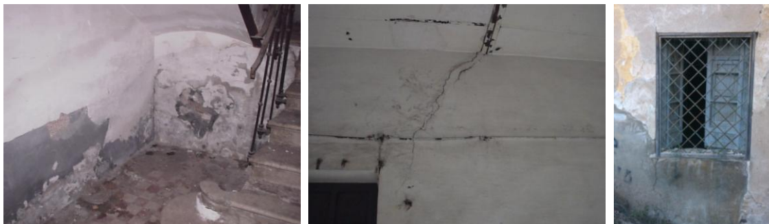
Figura 4: Fotografías de patologías encontradas. (Fuente: Los autores)
