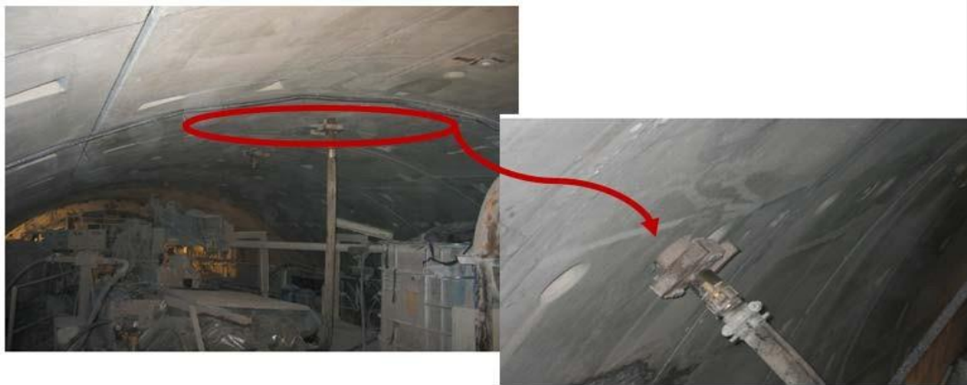
Figura 1.3 Detalle del mecanismo de Inyección a través de huecos en las dovelas de hormigón. Fuente: [1]
