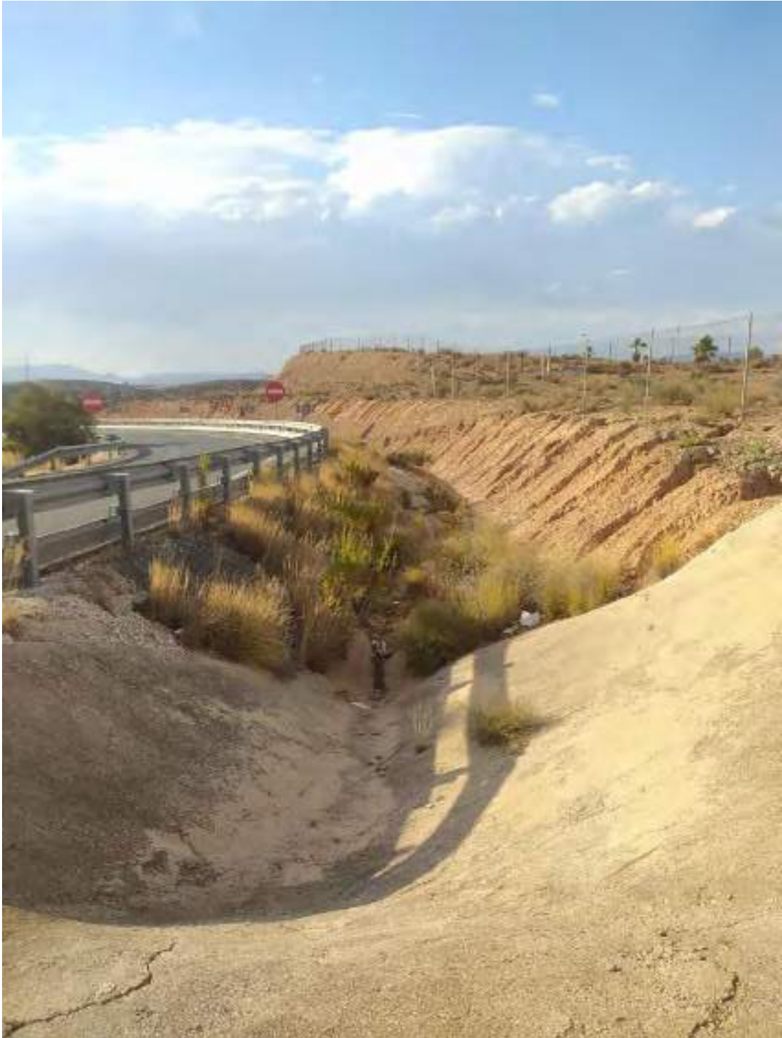
Figura 5.-Fotografía del estado actual de las cuentas del enlace de la salida de la autovía con la rotonda (El Chorrico)
