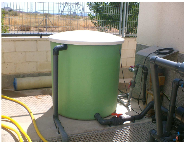
Figura 25. Depósito intermedio instalado antes del sistema de prefiltración
