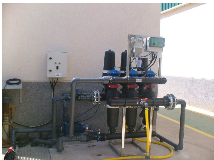
Figura 19. Filtros de anillas instalados en la EDARI
