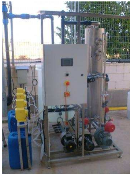
Figura 22. Planta Piloto instalada en la EDARI de la fábrica de cervezas, vista desde una perspectiva frontal
