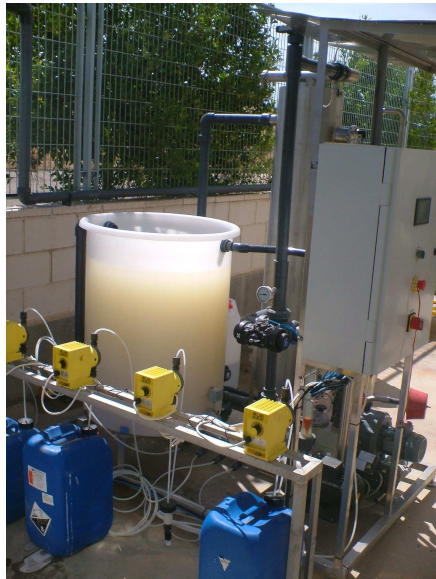
Figura 21. Planta Piloto instalada en la EDARI de la fábrica de cervezas, vista desde una perspectiva lateral
