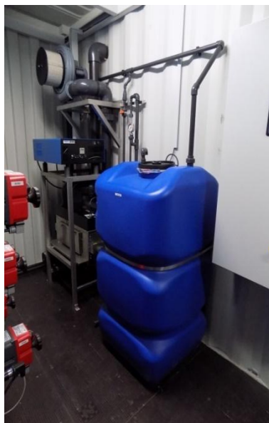
Figura IV.17 Tanque de agua producto.
