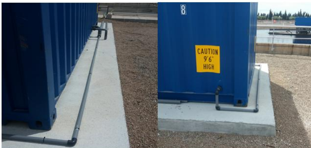
Figura V.42 Acometida entrada efluente y drenajes de depuradora al contenedor donde ira el piloto semiindustrial en la EDAR de Cabezo
