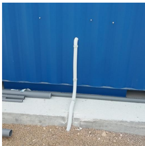
Figura V.43 Acometida eléctrica al contenedor donde ira el piloto semiindustrial en la EDAR de Cabezo Beaza.
