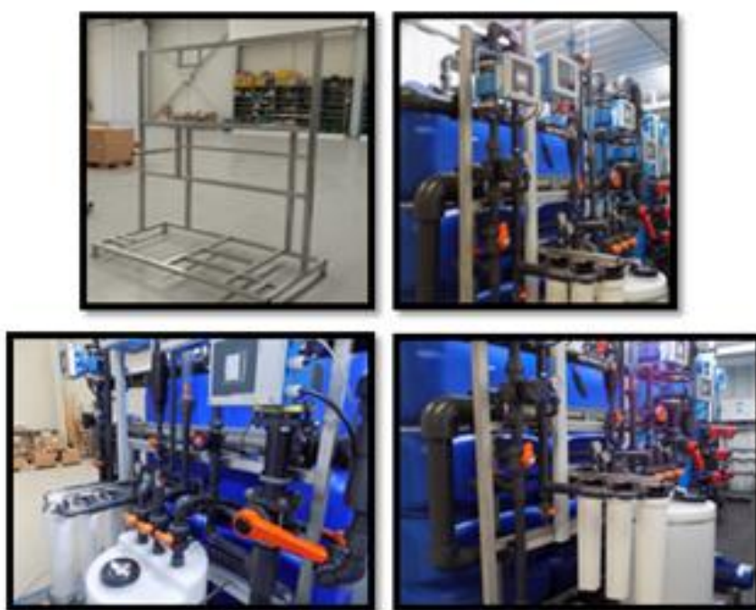
Figura IV.14. Marco/montaje de la unidad de pretratamiento.
