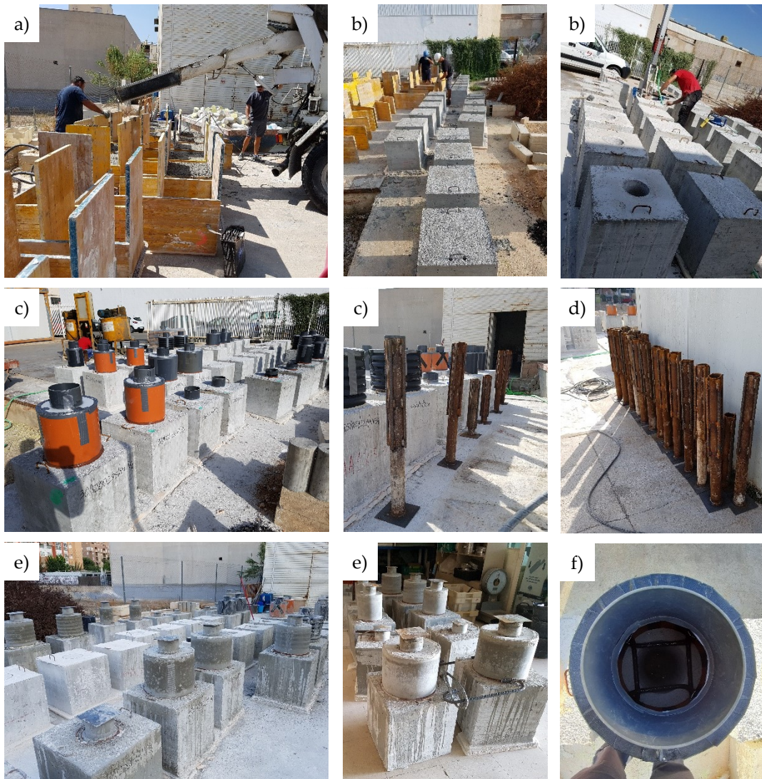
Figura 12. Proceso de fabricación de las probetas: a) Encofrado bloques de hormigón. b) Desencofrado y perforación de los huecos. c) Colocación de encofrado con diferentes tubos de PVC para definir la nueva conexión. d) Armaduras tubulares con las barras corrugadas soldadas. e) Especímenes obtenidos. f) Barras corrugadas para reforzar la nueva conexión propuesta. Fuente: Elaboración propia.
