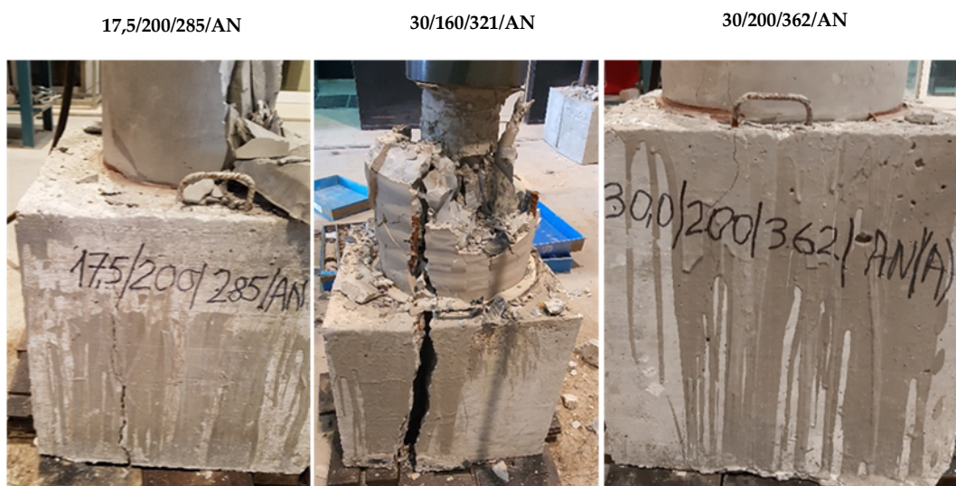
Figura 54. Probetas llevadas a rotura en pórtico en las que han aparecido fisuras/fracturas en la zona de la zapata. Fuente: Elaboración propia.
