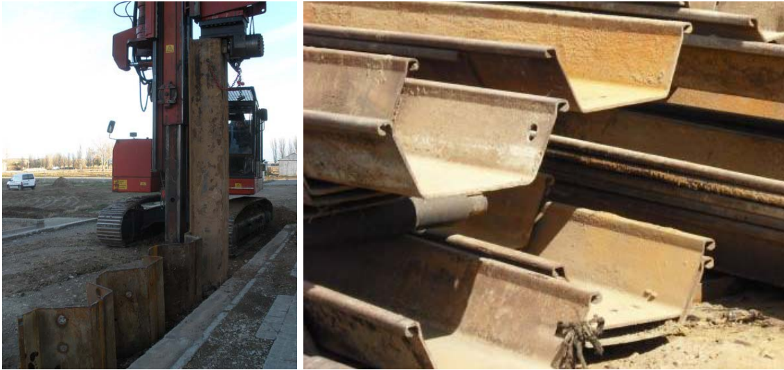
Ejecución de las pantallas y perfiles de las tablestacas. Fuente: <www.emgrisa.es> y <www.azendra.com> [Consulta: 3 de febrero de 2012].
