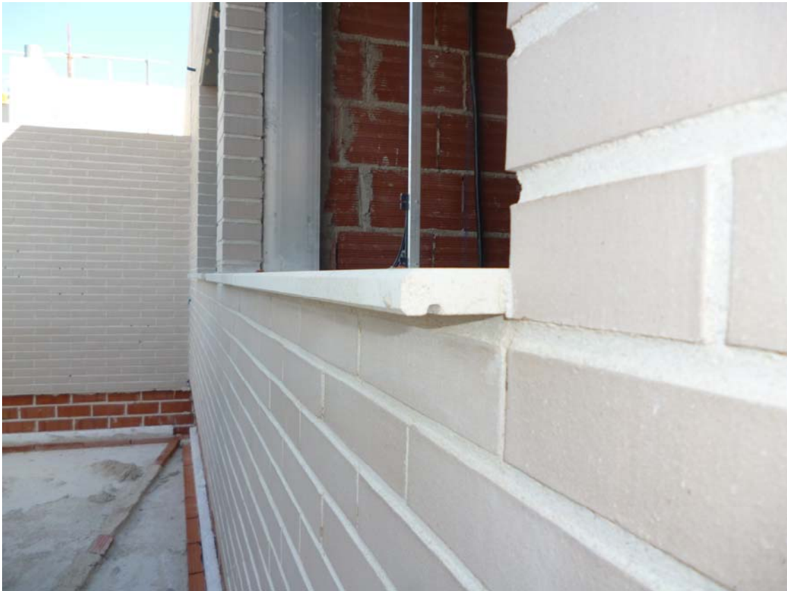
Vierteaguas con goterón a más de 2 cm de distancia del cerramiento de fachada.
