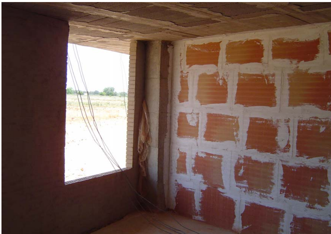
Hoja exterior de ladrillo caravista revestida interiormente con un enfoscado de mortero de cemento a buenavista.
