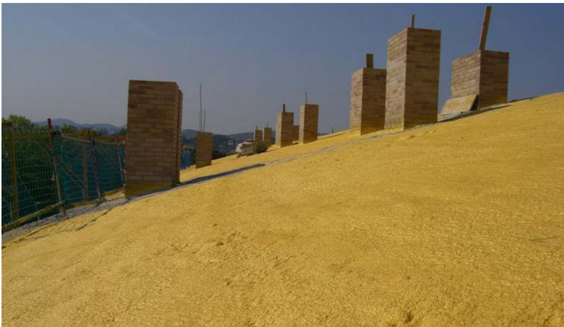
Aislamiento cubierta inclinada con espuma de poliuretano proyectada. Fuente: <www.aisla.org> [Consulta: 20 de mayo de 2018].
