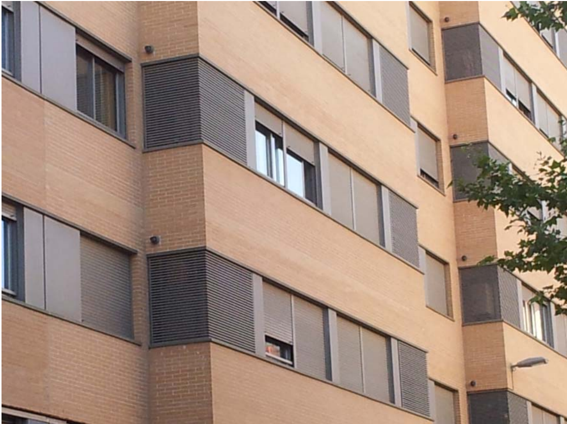
Fachada caravista con un desprendimiento incipiente de las plaquetas de los frentes de forjado.
