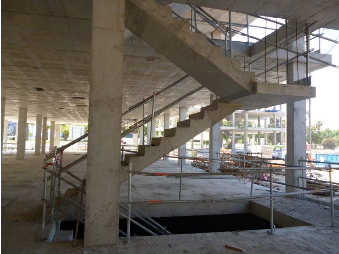
Escalera de hormigón armado con descansillo apoyado en murete de carga de ladrillo perforado de medio pie.
