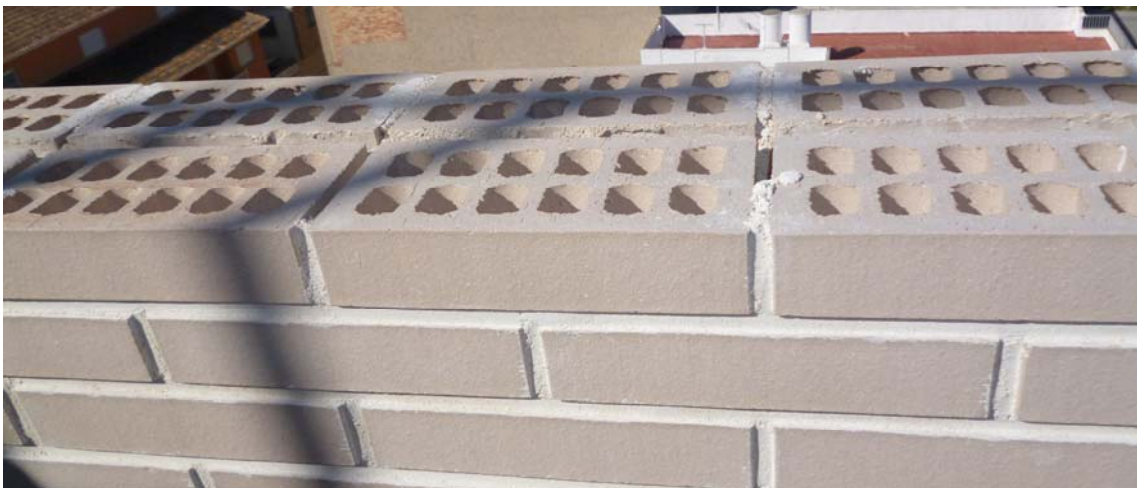
Antepechos de cubierta de doble hoja de fábrica de ladrillo cerámico (perforado+doble hueco o perforado+perforado).
