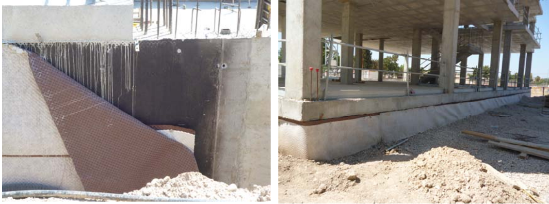
Drenaje de muro de sótano con lámina nodular con geotextil incorporado en la cara exterior en contacto con el terreno.
