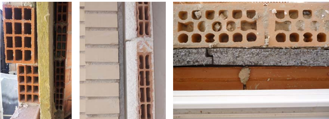
Aislamiento térmico de lana de roca, poliestireno expandido y poliestireno expandido de grafito, en fachada capuchina tradicional..
