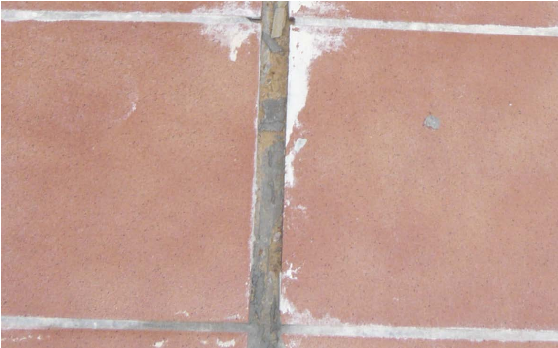
Junta en pavimento cerámico de cubierta plana transitable.
