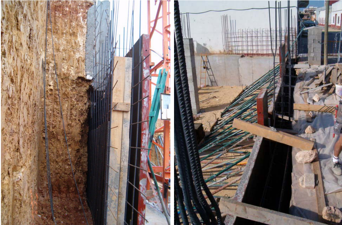
Encofrado del muro y apuntalamiento del mismo durante el proceso de vertido y de fraguado y endurecimiento del hormigón.
