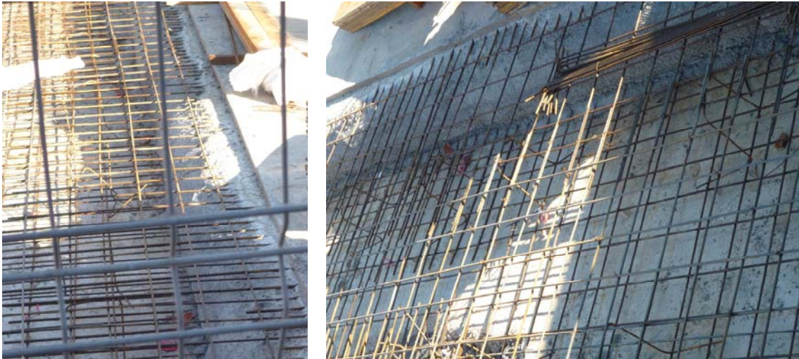
Junta de hormigonado en losa de cimentación. Disposición de tela de gallinero para mejorar la adherencia.
