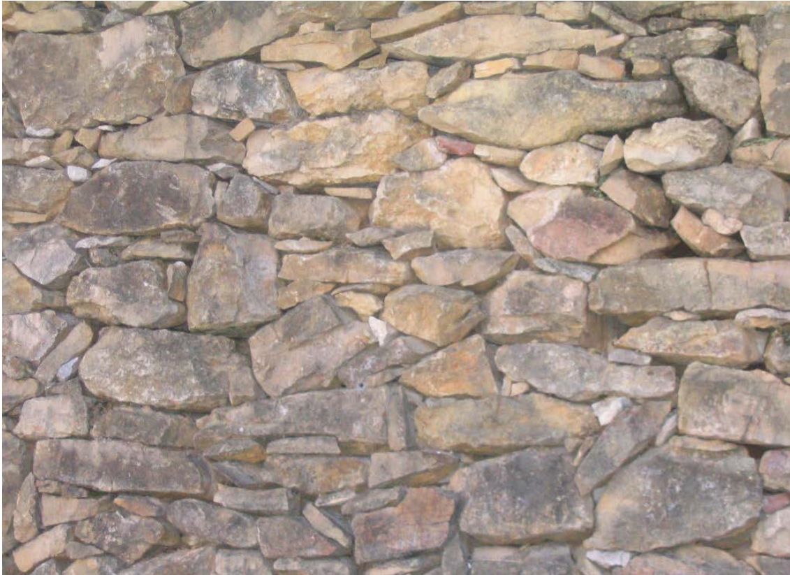
Muro de piedra en seco con los mampuestos prácticamente sin labrar, con la interposición de ripios para relleno de juntas.
