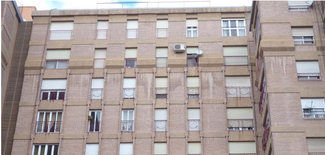
Lavado diferencial en fachada de ladrillo caravista.
