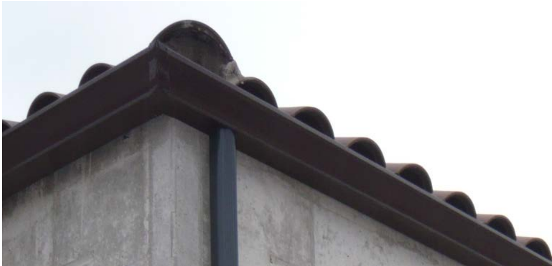
Canalón exterior en cubierta inclinada con teja cerámica,
