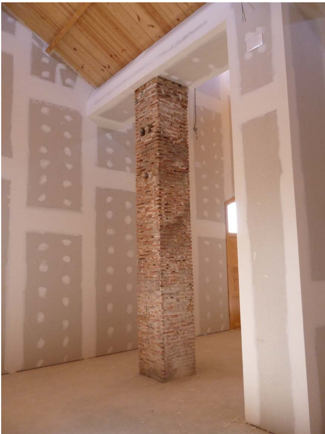
Aspecto final del tabique tras la terminación fina del tratamiento de junta.
