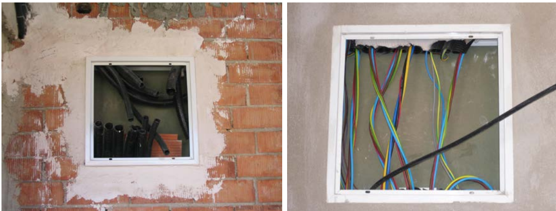
Registros de instalaciones generales en zonas comunes del edificio.
