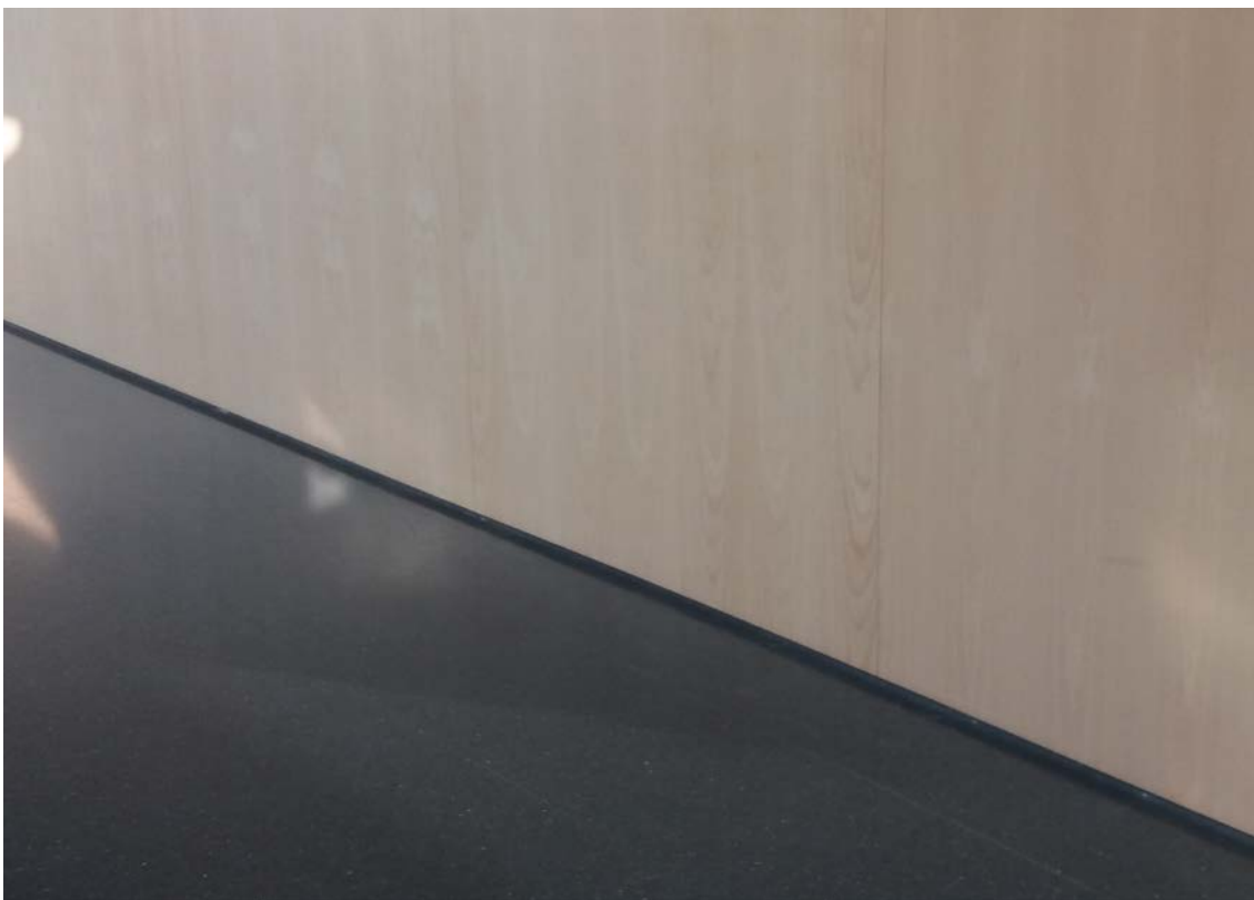
Holgura de 1 cm en el encuentro con el pavimento.
