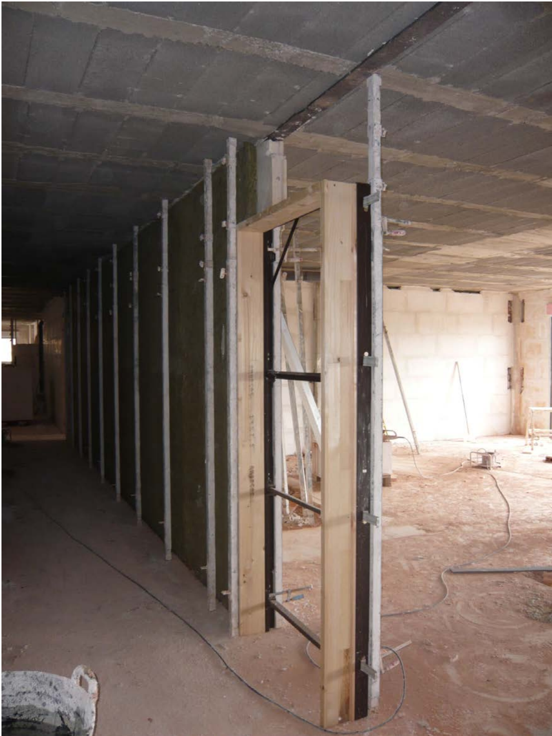
Premarco de acero de puerta acorazada de acceso a una unidad de uso.
