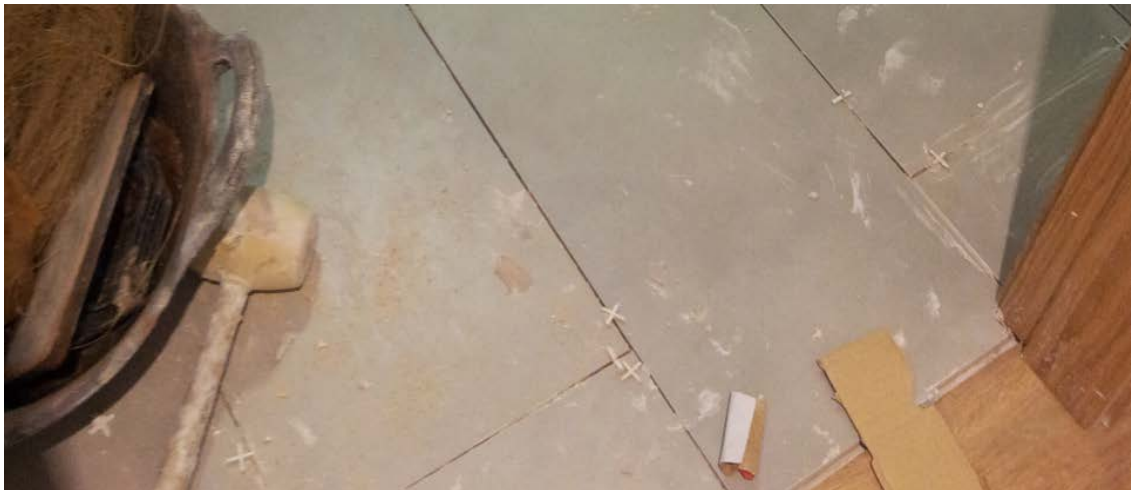
Holgura entre pavimento de tarima flotante y de baldosa cerámica.
