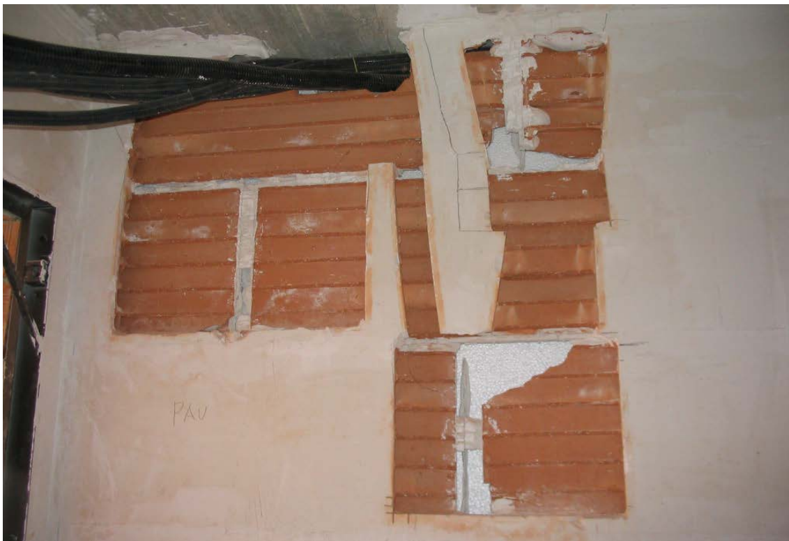
Rozas practicadas en tabique de fábrica de ladrillo para colocación de cuadros de control de instalaciones.
