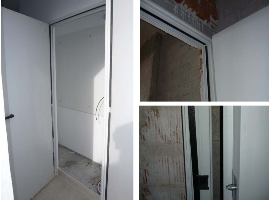
Tiras de material intumescente en el perímetro del marco de una puerta cortafuegos.
