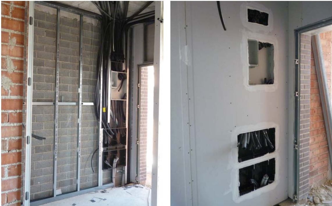
Integración de instalaciones eléctricas en la estructura del tabique, ocultas tras la colocación de los tableros de cierre, quedando vistos tan sólo los puntos de toma, control y registro.
