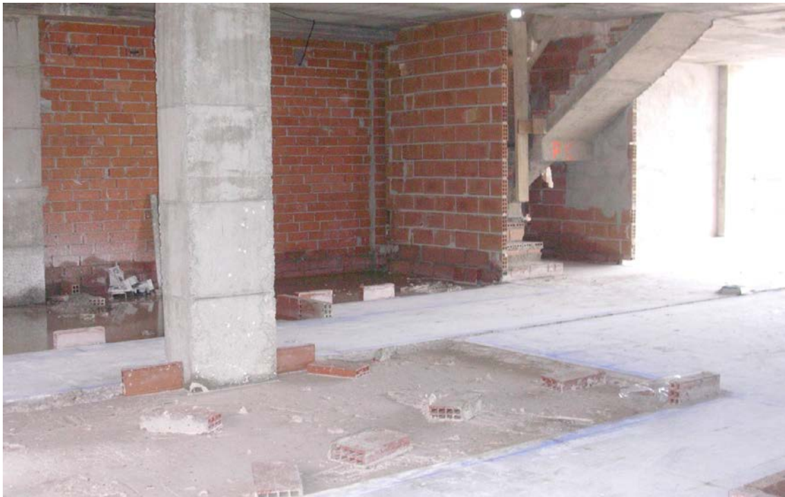
Apoyo de la tabiquería sobre forjado en cambio de pavimento de zona húmeda a zona seca.
