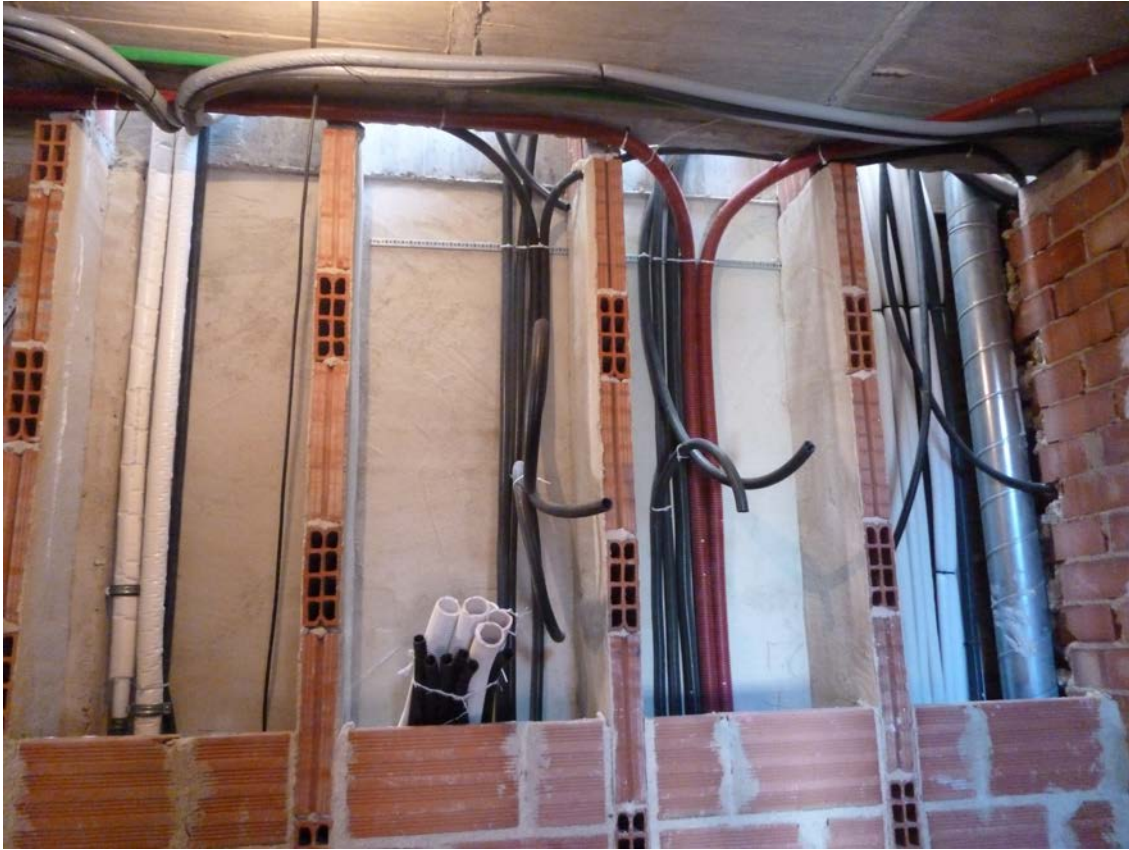
Patinillo de instalaciones.
