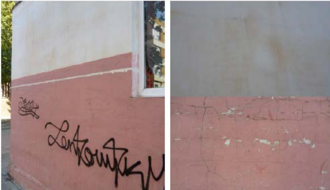
Niveles de degradación de la pintura de una fachada con orientación sur en función del color.
