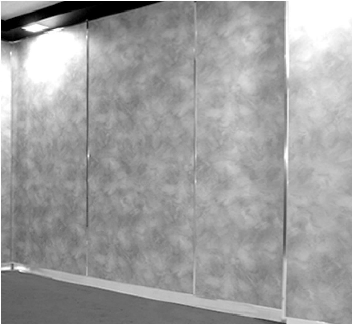
Tabique con placas de yeso laminado con acabado de vinilo de PVC. Fuente: < www.laminados.escayescos.com > [Consulta: 24 de enero de 2019].
