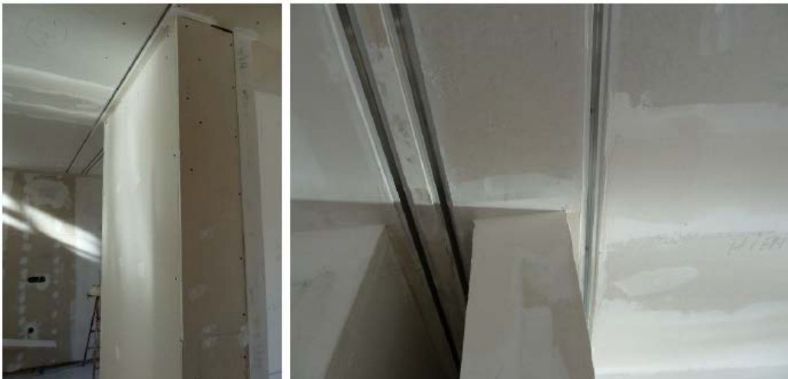
Guías aéreas de puerta corredera embebidas en un falso techo de cartón-yeso.
