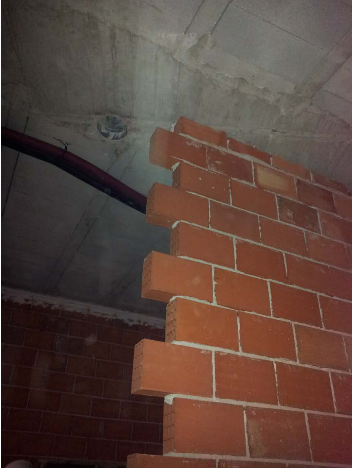
Encuentro entre distintos tramos de un mismo tabique debido al proceso constructivo.
