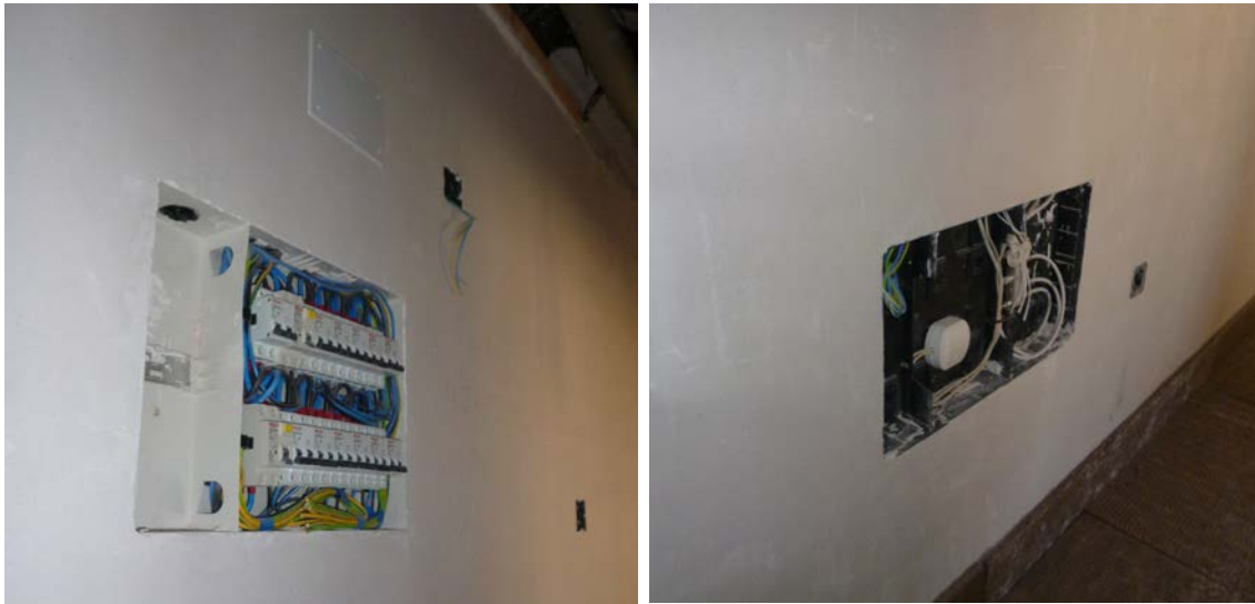
Registros de instalaciones de derivaciones particulares en la vivienda.
