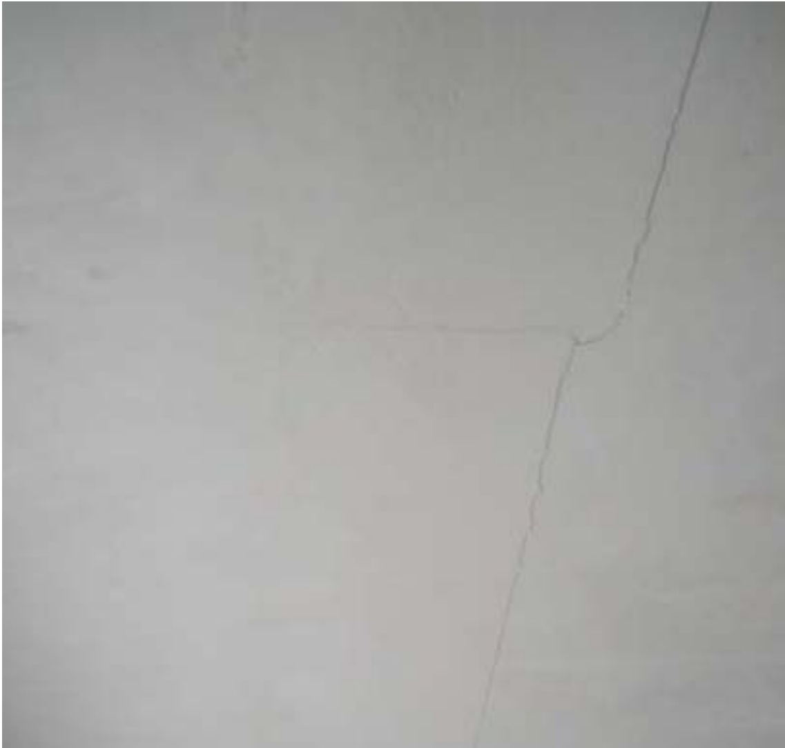
Grietas entre placas en techo sin juntas de dilatación.
