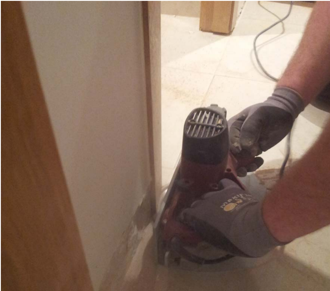
Ajuste de los marcos de puertas para el paso de la tarima flotante.
