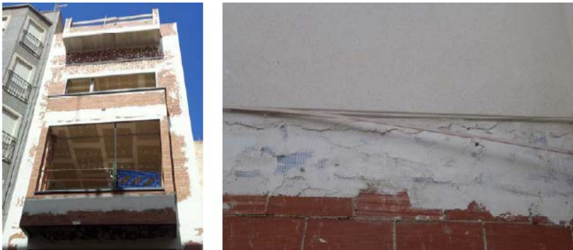
Colocación de malla de fibra de vidrio en el encuentro de los pilares y forjados con la hoja exterior del cerramiento de fachada, quedando embebida en el grueso del monocapa.
