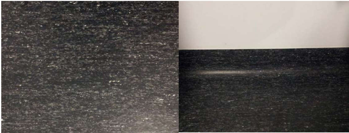
Detalle de la superficie del pavimento y del encuentro a media caña con los paramentos vesticales.
