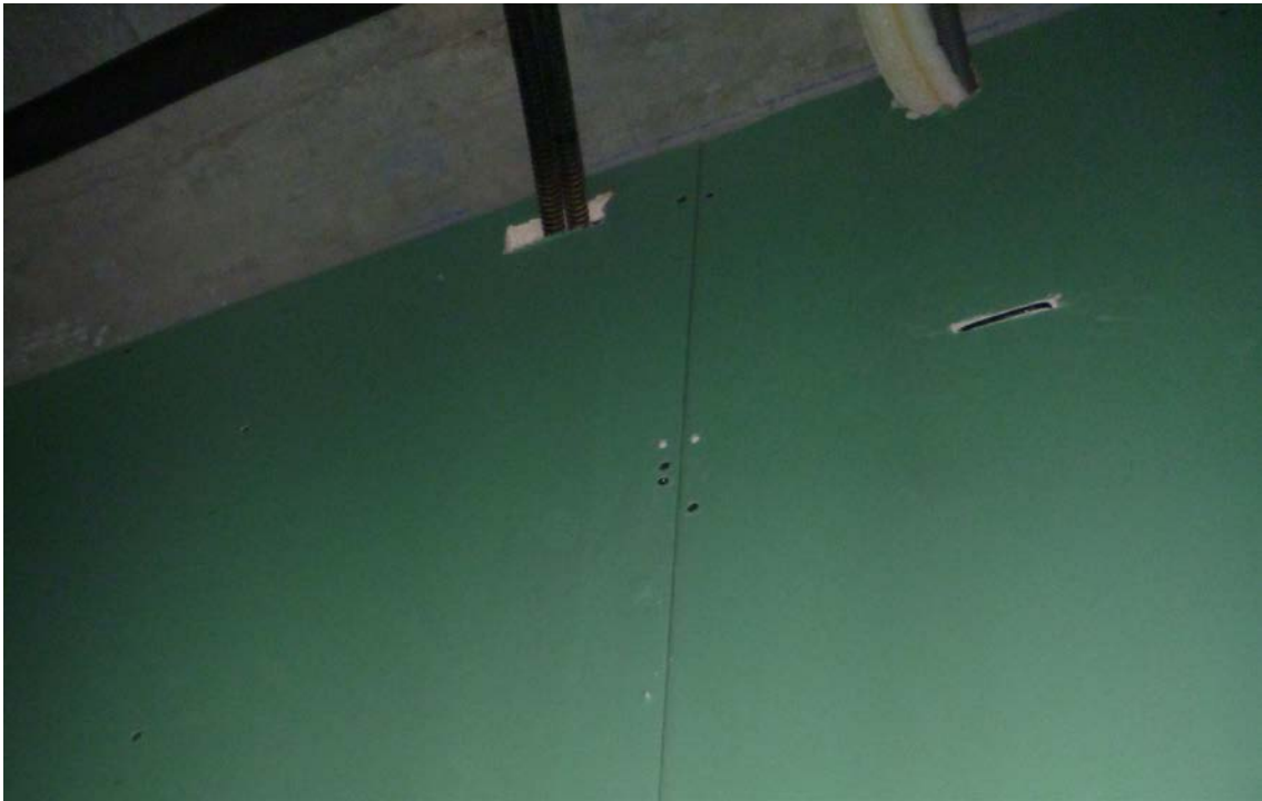
Instalaciones integradas tras las placas hidrófugas del baño.
