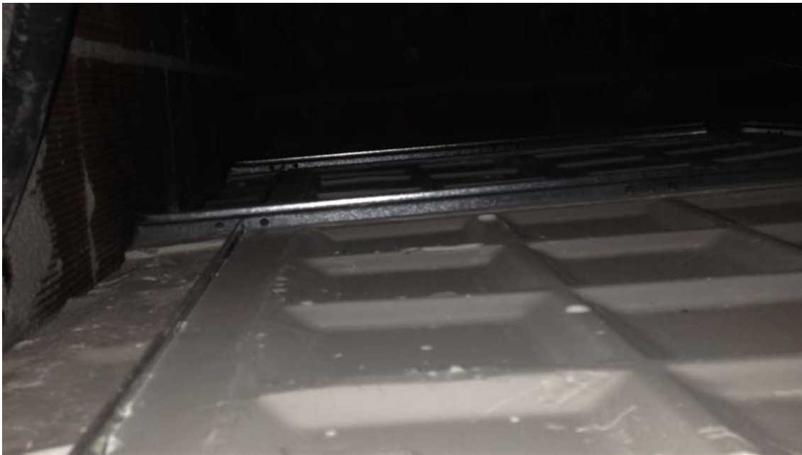
Falso techo de placas de escayola tomadas con tirantes de alambre de acero galvanizado.
