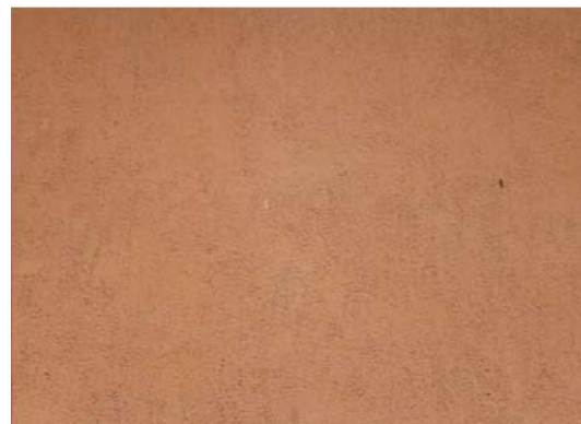
Ejemplos de revocos pétreos en la planta baja de una fachada.
