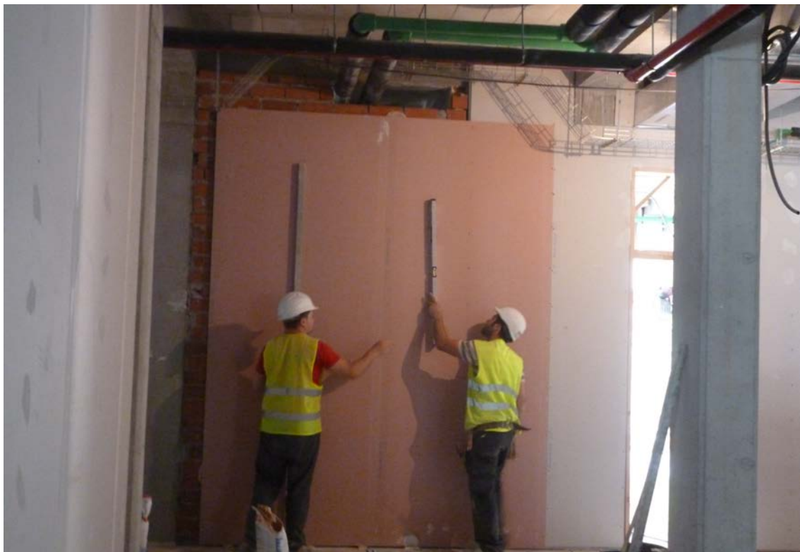
Placas resistentes al fuego dispuestas en tabique que alberga el cuadro eléctrico del edificio.
