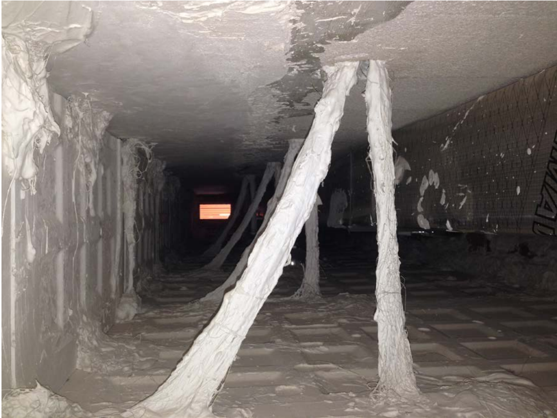
Falso techo de placas de escayola tomadas con tirantes de escayola y cáñamo.
