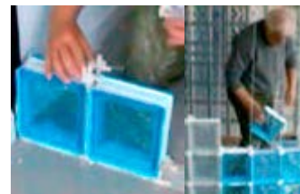
Colocación de los bloques de vidrio para formación de tabique. Fuente: <www.vitroland.com> [Consulta: 9 de septiembre de 2019].
