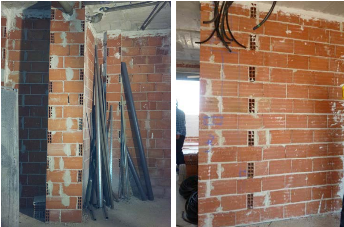
Encuentro entre tabiques en L y en T. Disposición de enjarjes entre las hialadas de ambos.
