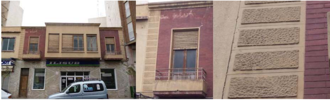
Ejemplo del estuco a la martillina imitando el almohadillado de las esquinas de una fachada.
