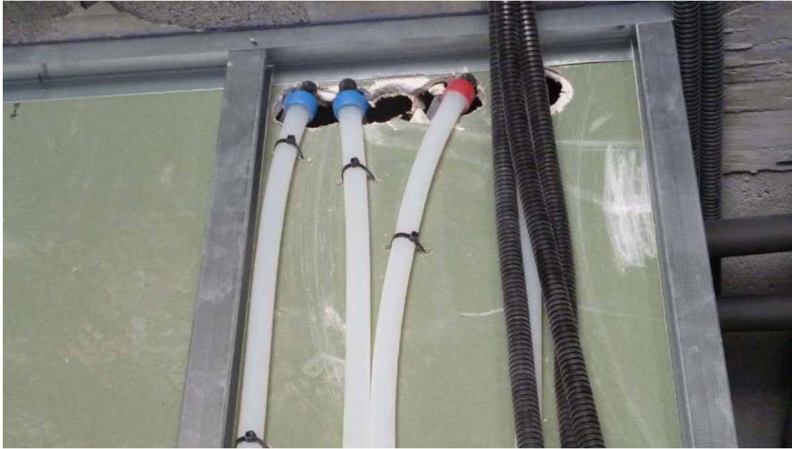
Placas hidrófugas en los tabiques que albergan instalaciones de agua.
