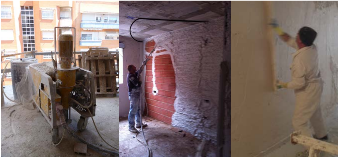
Ejecución de un conglomerado a Buenavista con proyección de la pasta de yeso a máquina.
