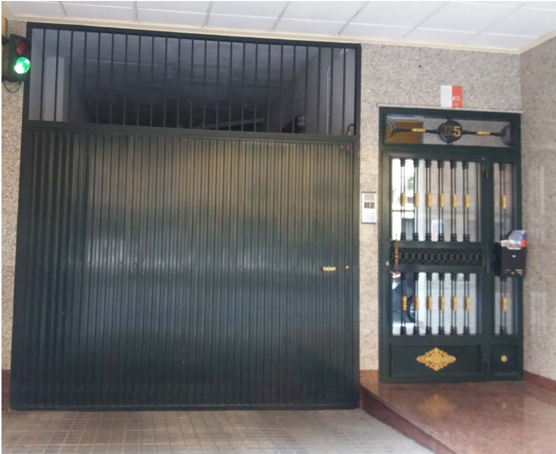
Rejilla de ventilación natural del garaje integrada en la parte superior del marco de la puerta de acceso.
