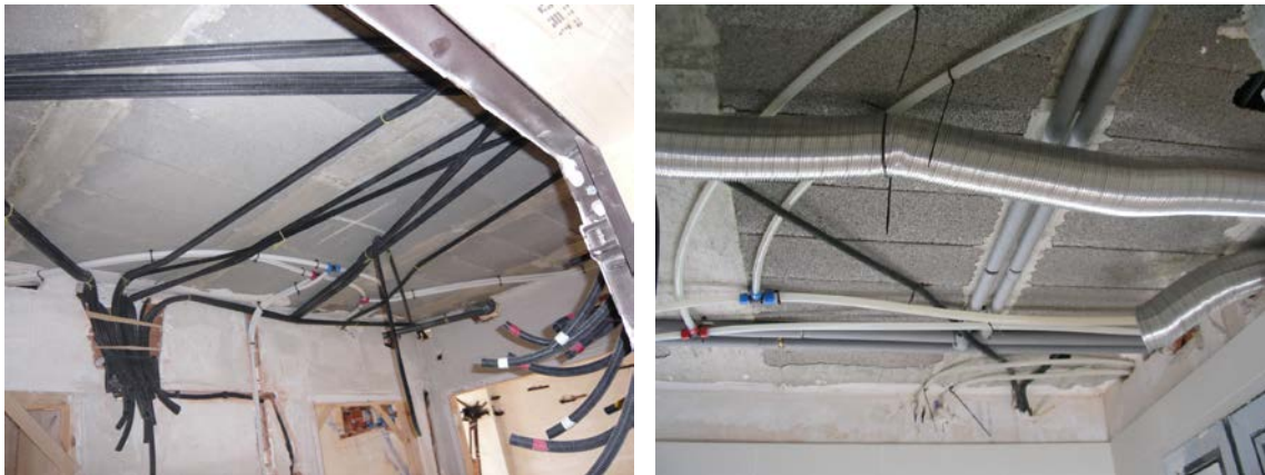
Instalaciones colgadas de la cara inferior del forjado.
