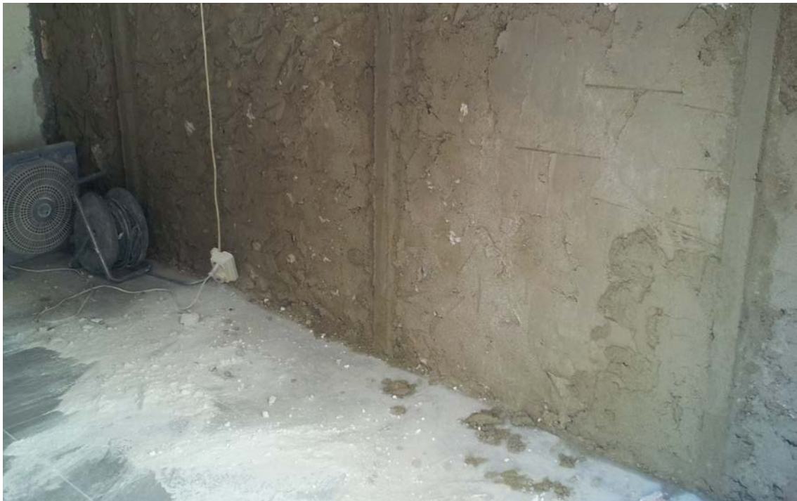
Relleno de los cajones creados entre maestras contiguas con un conglomerado hidráulico.
