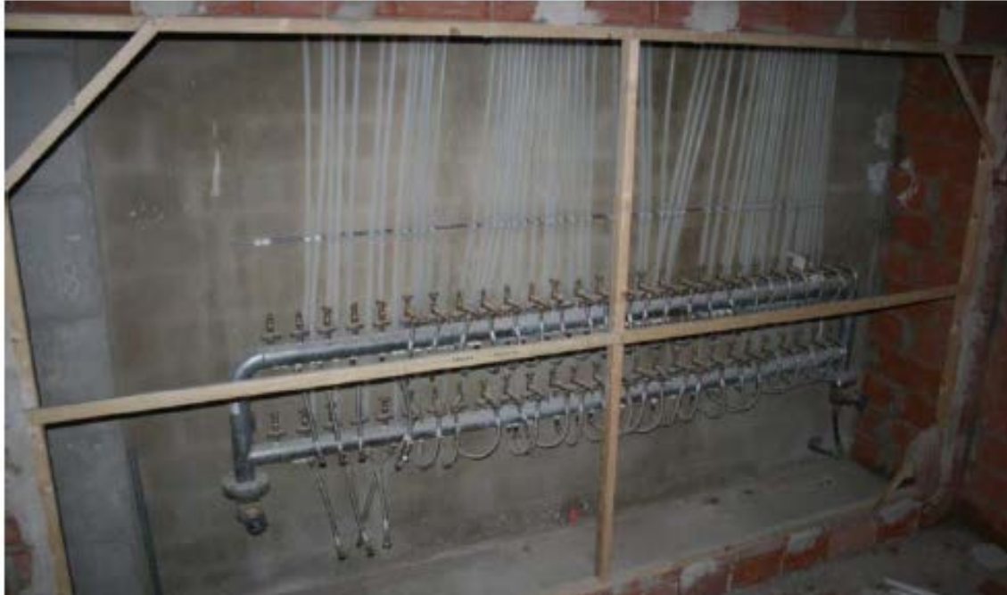
Armario que aloja la batería de contadores de agua.
