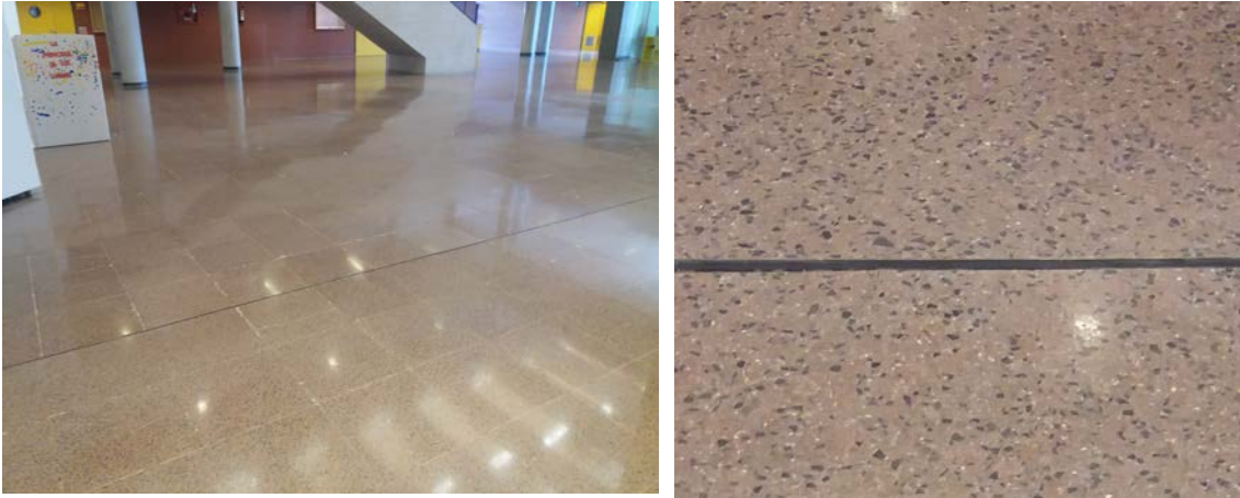
Junta entre pavimento de terrazo rellena de masilla elástica.
