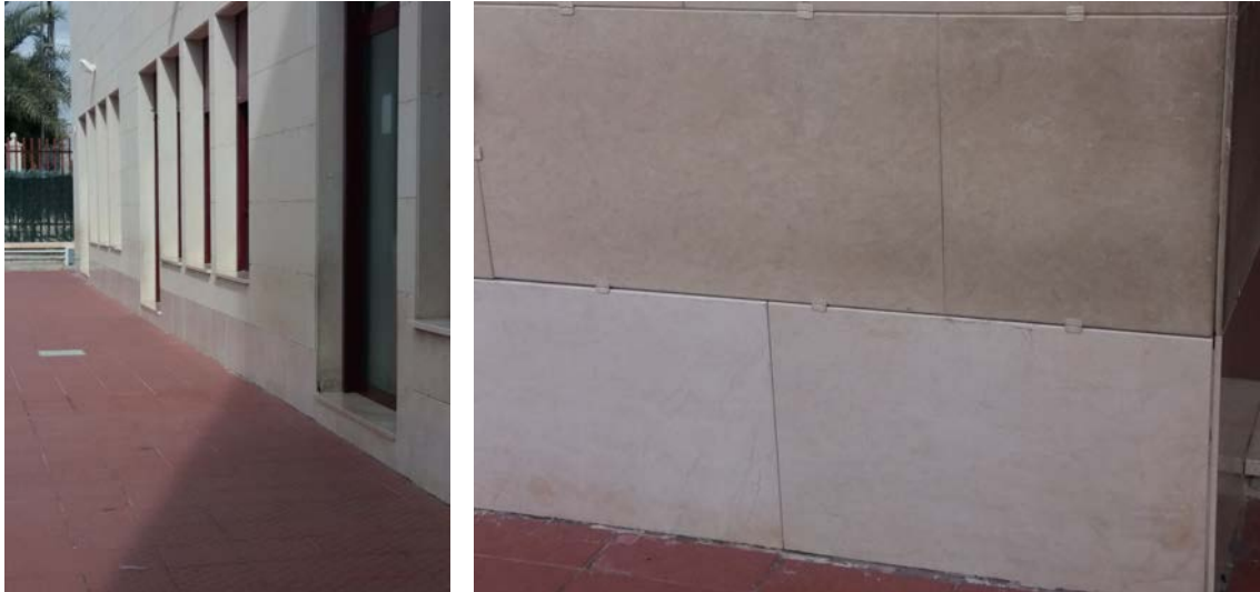
Pestañas de seguridad en el aplacado de fachada de un centro de educación infantil.
