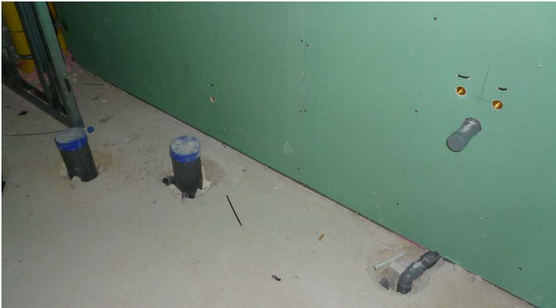
Paneles con puntos de toma de instalaciones.
