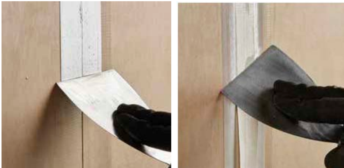
Tratamiento de juntas entre tableros de madera. Fuente: <www.tectonica-online.com> [Consulta: 24 de enero de 2019].
