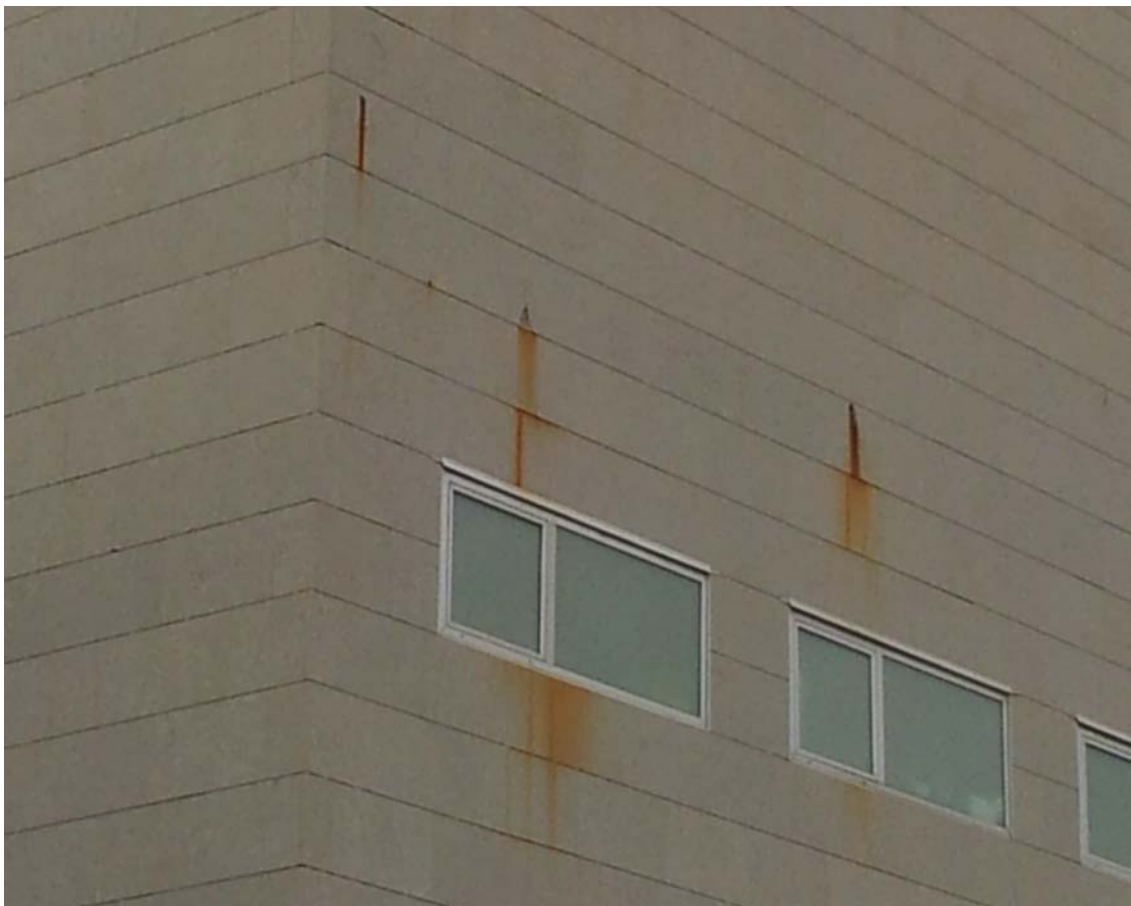
Manchas por oxidación de los elementos de anclaje del aplacado. Además de producir el ensuciamiento de la fachada tiene el grave peligro de producir un fallo del anclaje y la caída de placas a la vía pública. .
