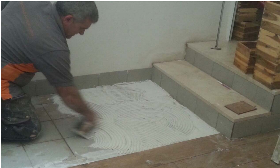
Mortero cola de agarre aplicado sobre la base y peinado con llana dentada.
