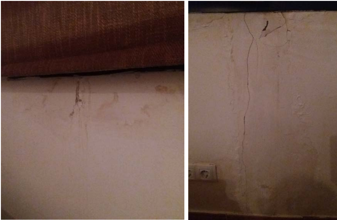
Filtraciones procedentes de ventanas.
