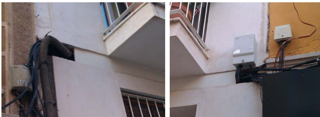
Sujeción del cableado mediante tapa de registro.
