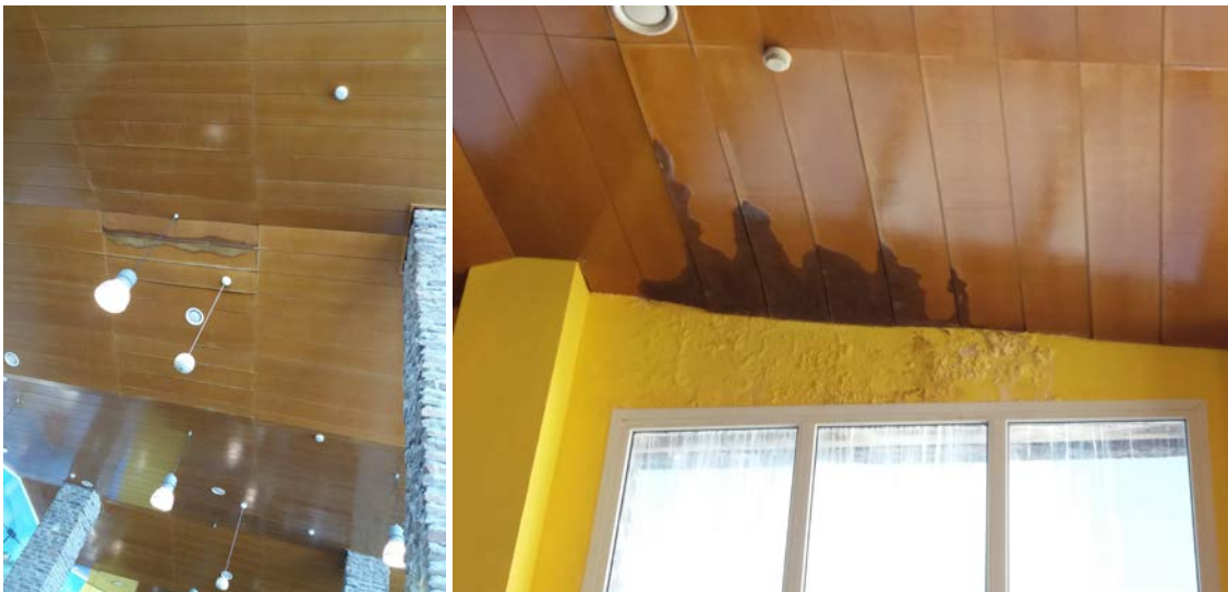
Filtraciones procedentes de la cubierta.
