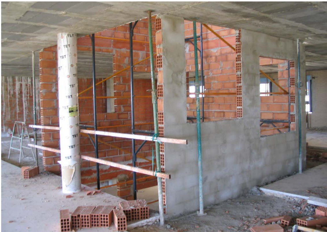
Revestimiento interior de la hoja exterior del cerramiento de fachada, enfoscado de mortero de cemento a buenavista.
