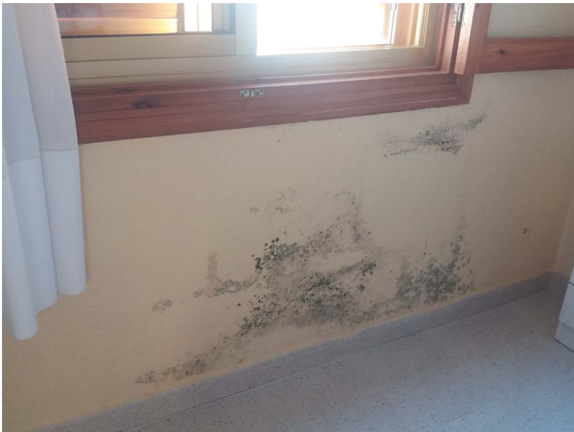
Filtraciones procedentes de ventanas.
