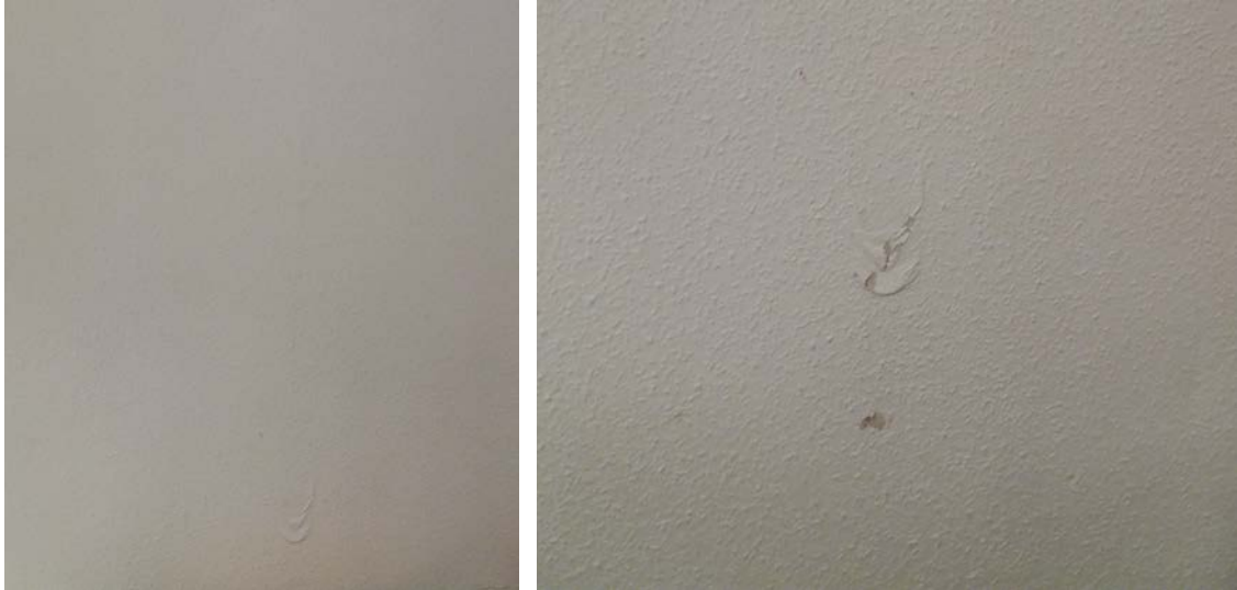
Filtraciones procedentes de la fachada.
