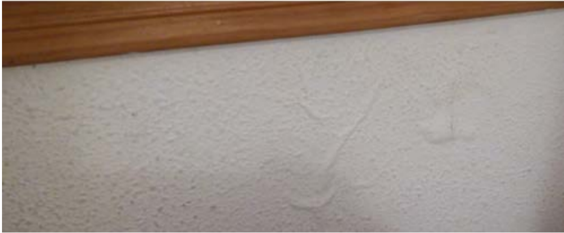
Bolsas en la pintura por filtración de agua por la carpintería de ventana.
