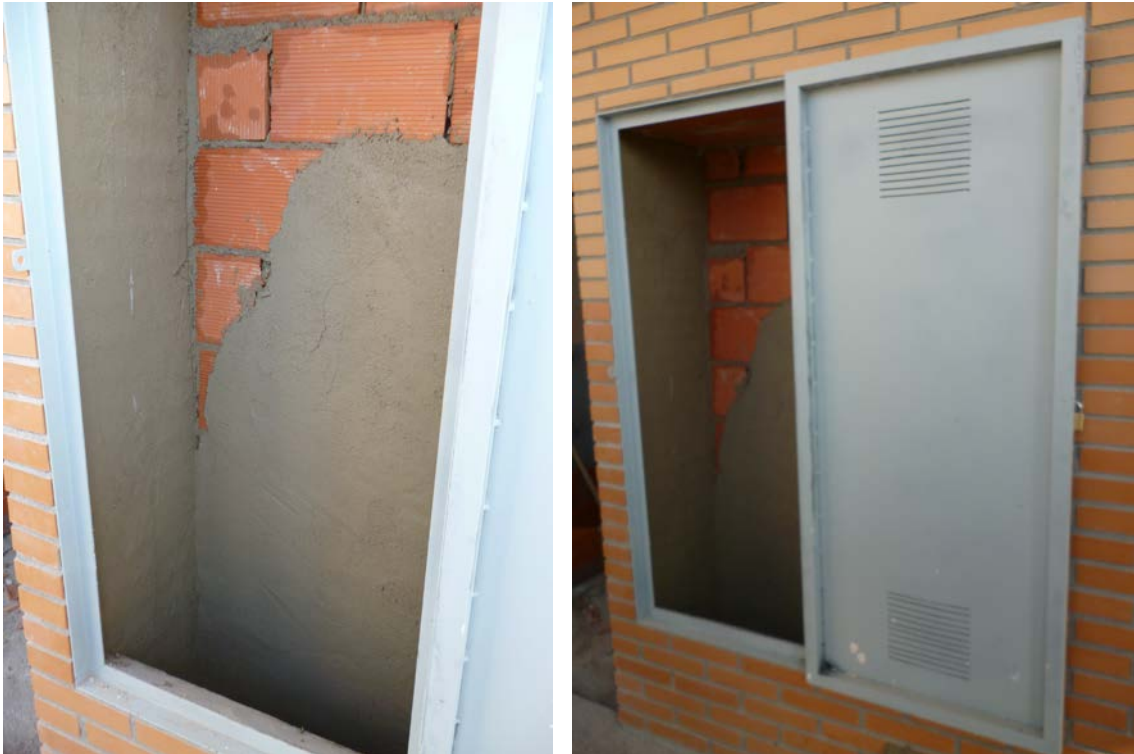
Armario de acometida de la red de abastecimiento de agua potable en construcción.
