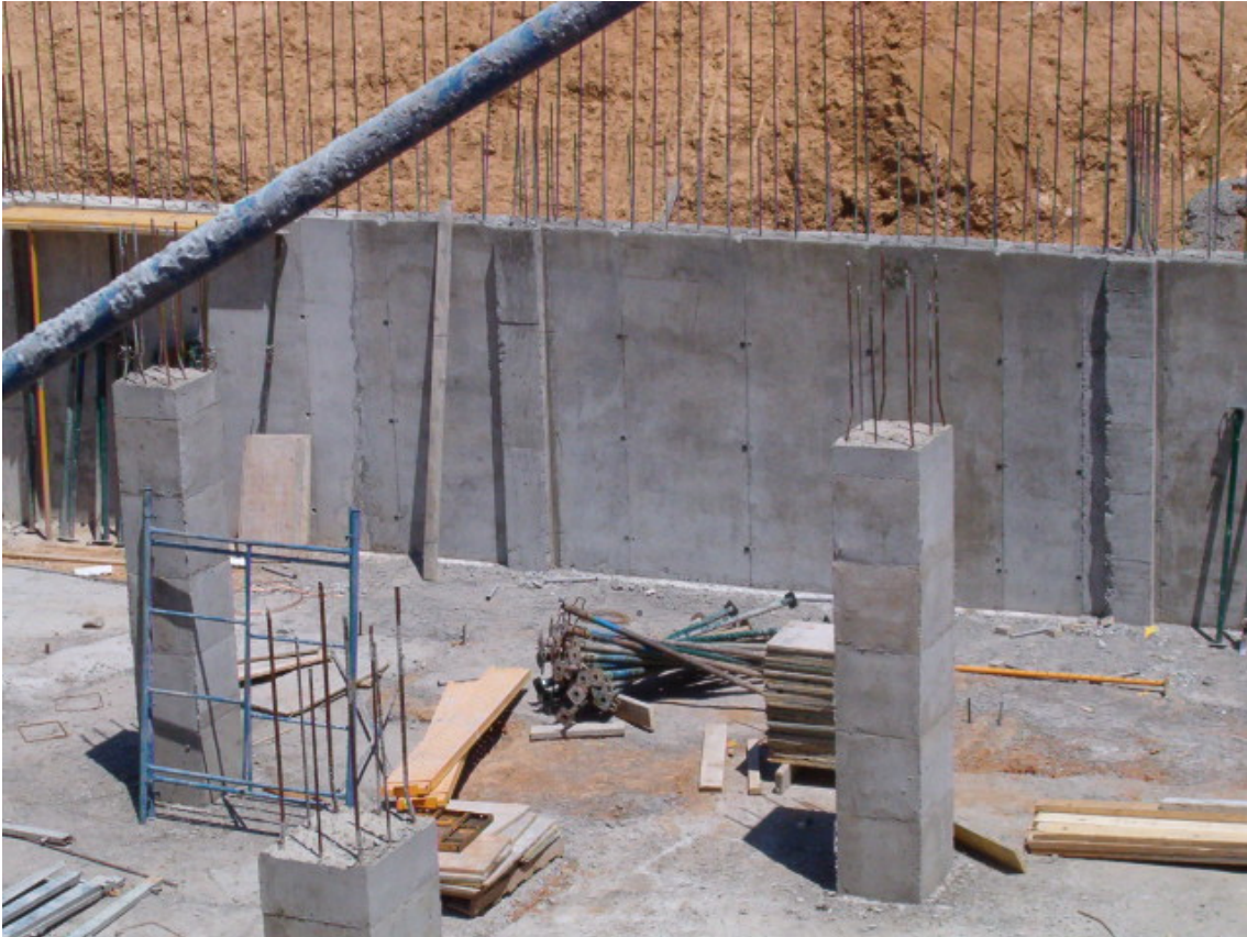
Armaduras en espera del pilar sobresaliendo de la coronación del muro de sótano: pilar de mayor sección que el muro - el pilar continua hasta la cimentación.
