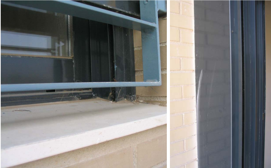
Sellado de la junta exterior entre carpintería y obra con cordón de silicona.
