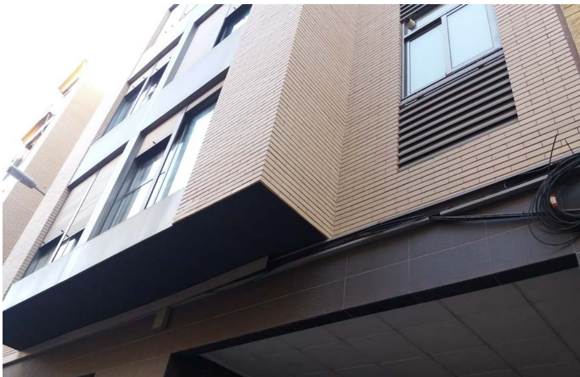
Caída de tapa de registro de caja de instalaciones anclada a la fachada.
