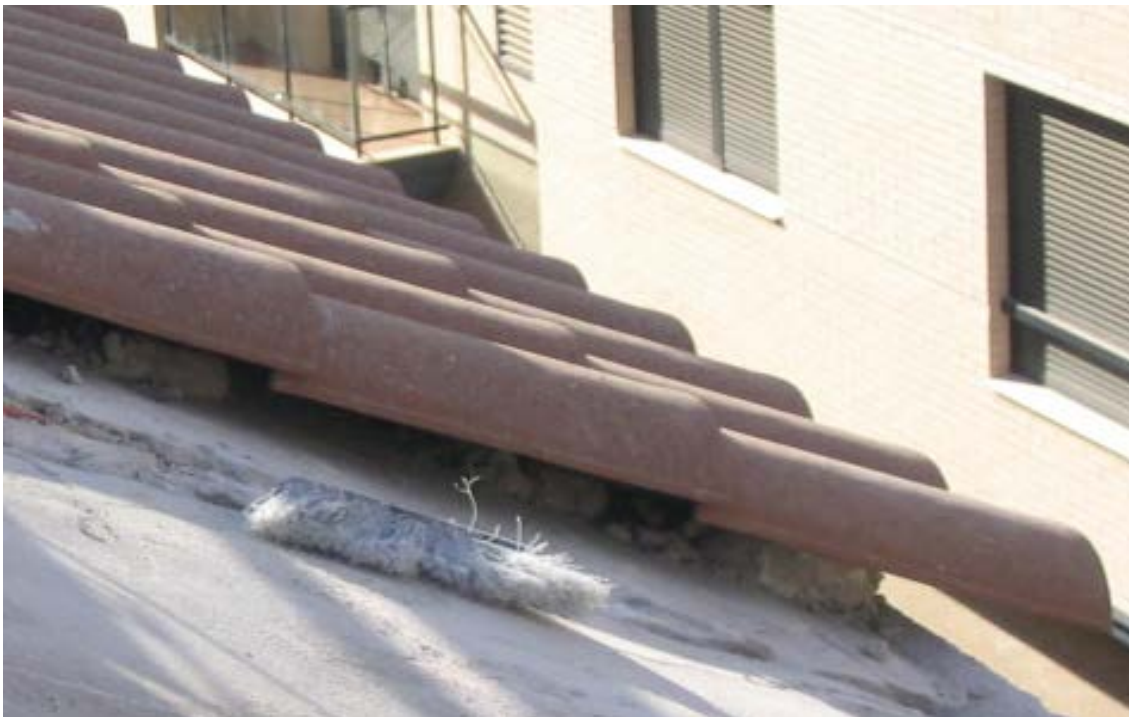
Cubierta inclinada de teja cerámica mixta tomada con pelladas de mortero de cemento.
