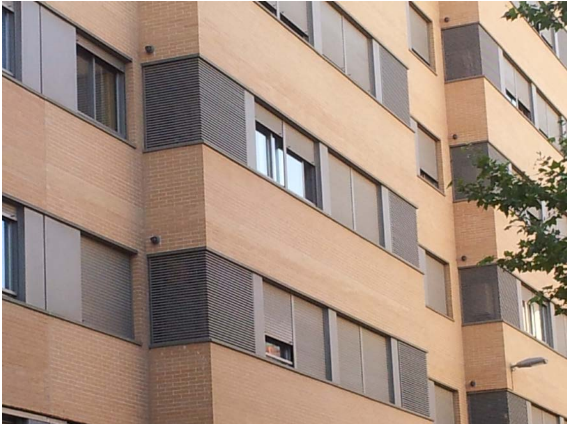
Fachada caravista con un desprendimiento incipiente de las plaquetas de los frentes de forjado.
