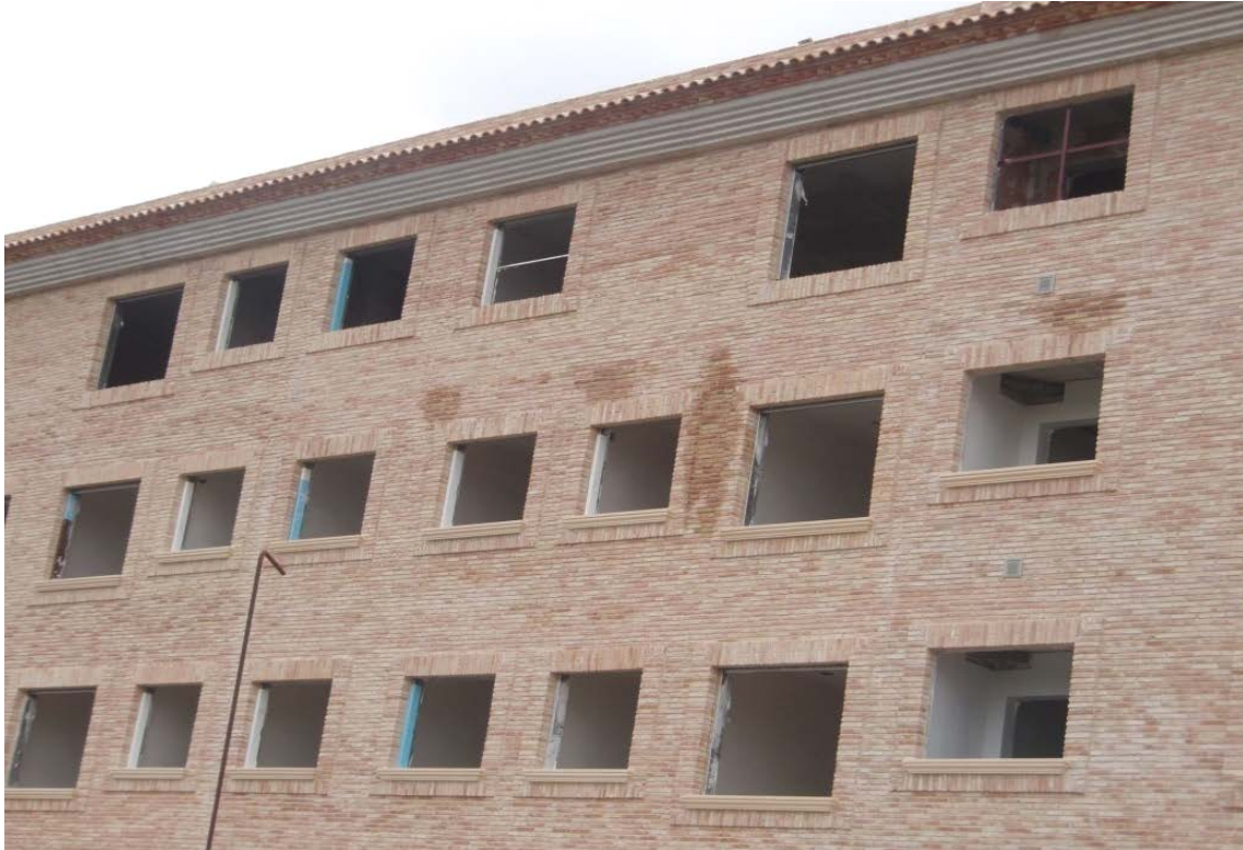
Humedad en cerramiento de fachada.
