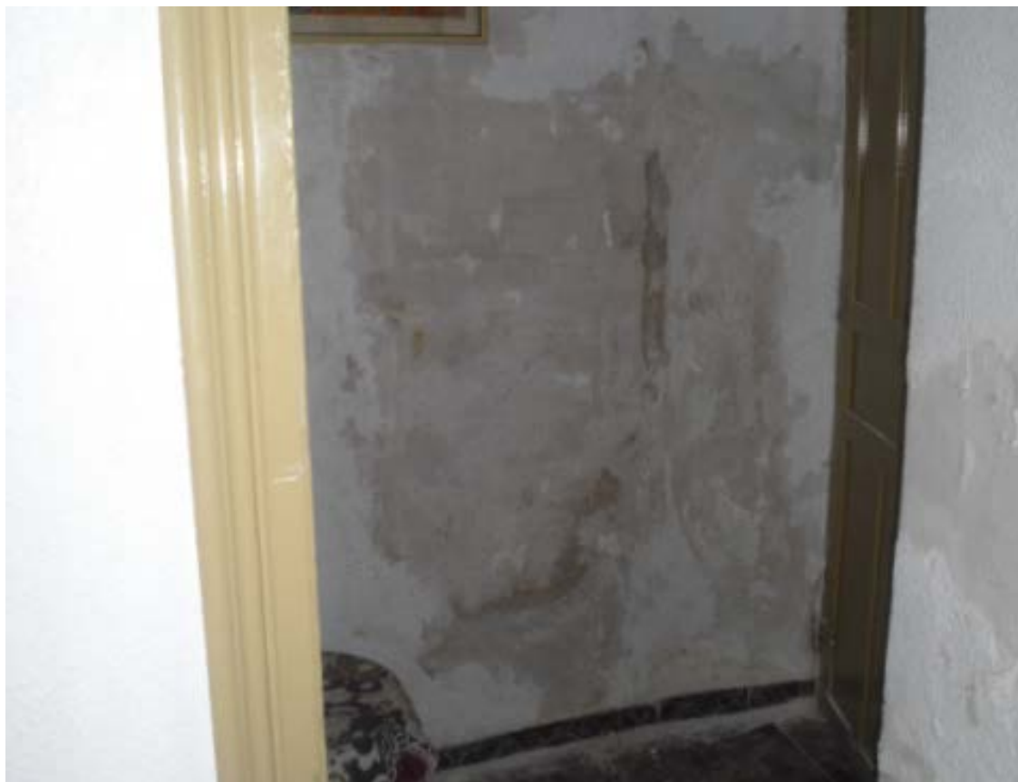
Humedad por capilaridad en particiones interiores debida a la ausencia de impermeabilización y ventilación en la solera.
