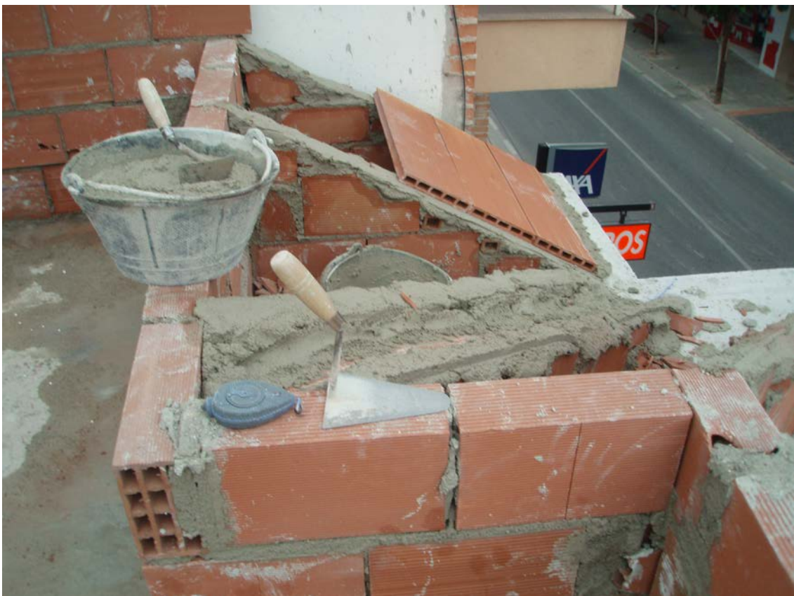
Remate de los tabiques palomeros con capa de mortero de cemento de regulación.
