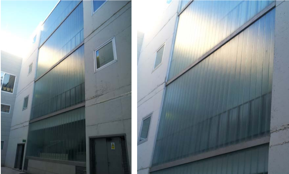
Sistema de fachada U-Glass, transparencia y privacidad del espacio interior.
