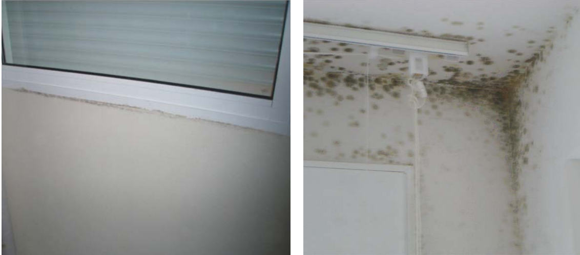
Lesiones debidas a la condensación del vapor de agua en las superficies.
