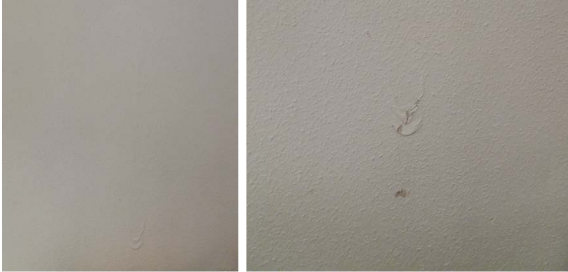
Filtraciones procedentes de la fachada.
