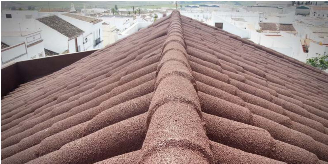
Aislamiento cubierta inclinada con corcho proyectado. Fuente: < www.decoproycandalucia.com > [Consulta: 20 de mayo de 2018].
