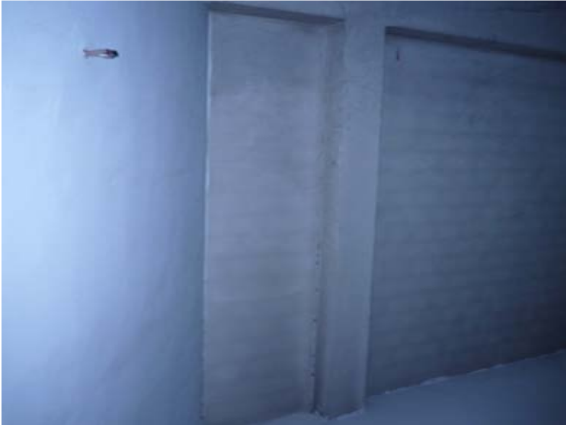
Humedad en muro de sótano marcada en el enfoscado de recubrimiento interior.
