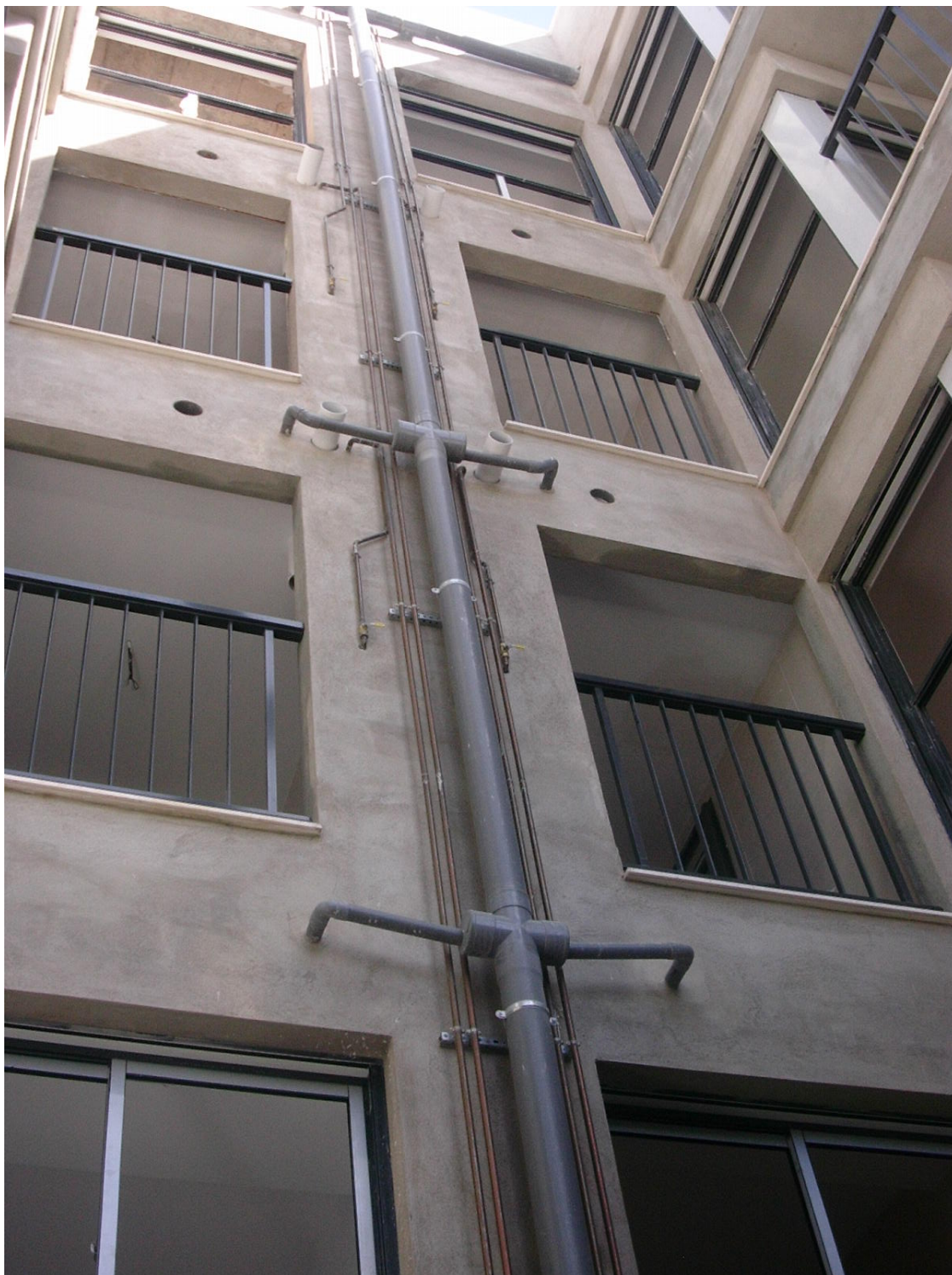
Instalación de gas canalizado y de saneamiento en fachada a patio interior.
