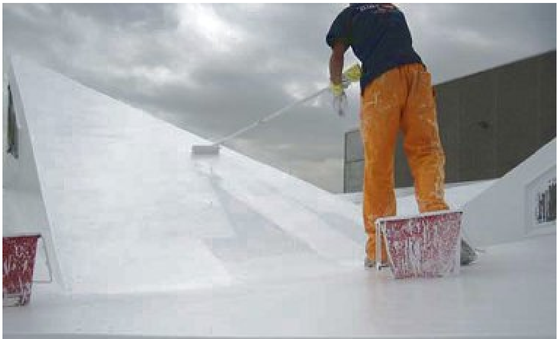
Impermeabilización de cubierta inclinada con poliuretano líquido. Fuente: < www.generadordeprecios.info > [Consulta: 20 de mayo de 2018].
