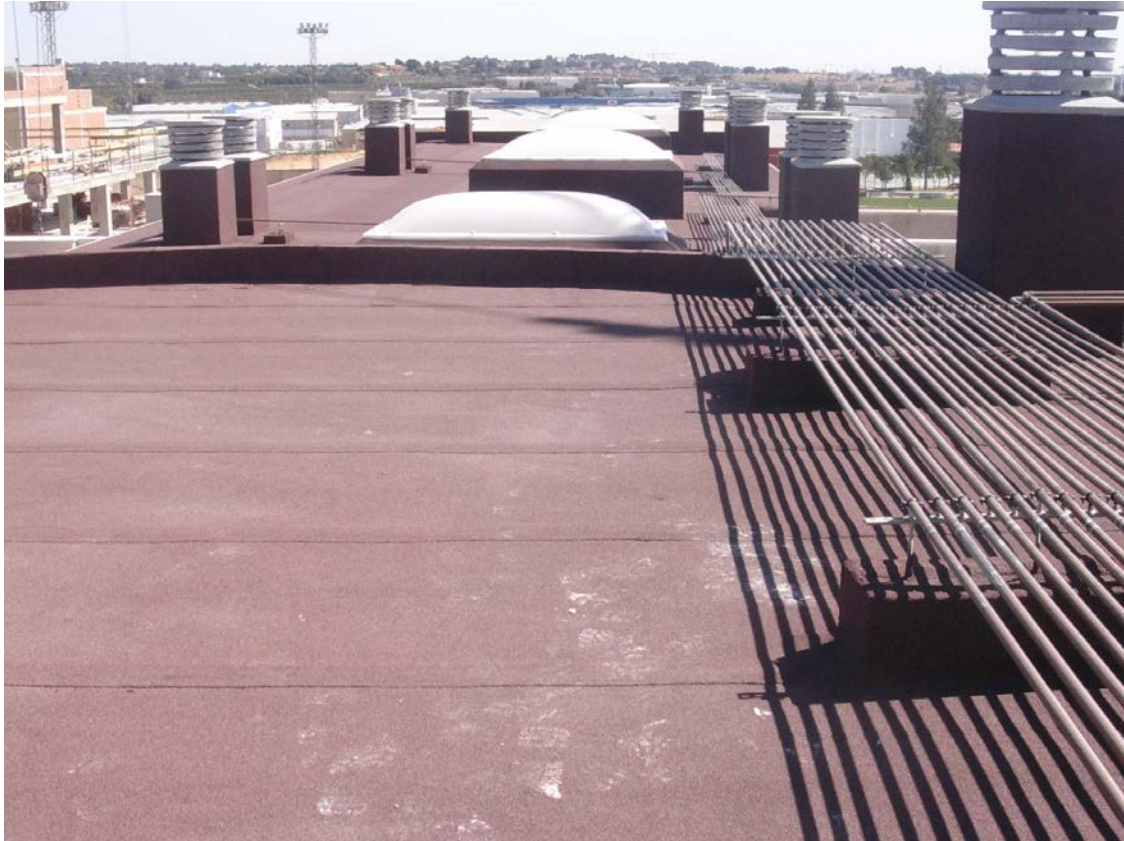
Tuberías de gas canalizado discurriendo por cubierta plana autoprottegida sobre caballetes.
