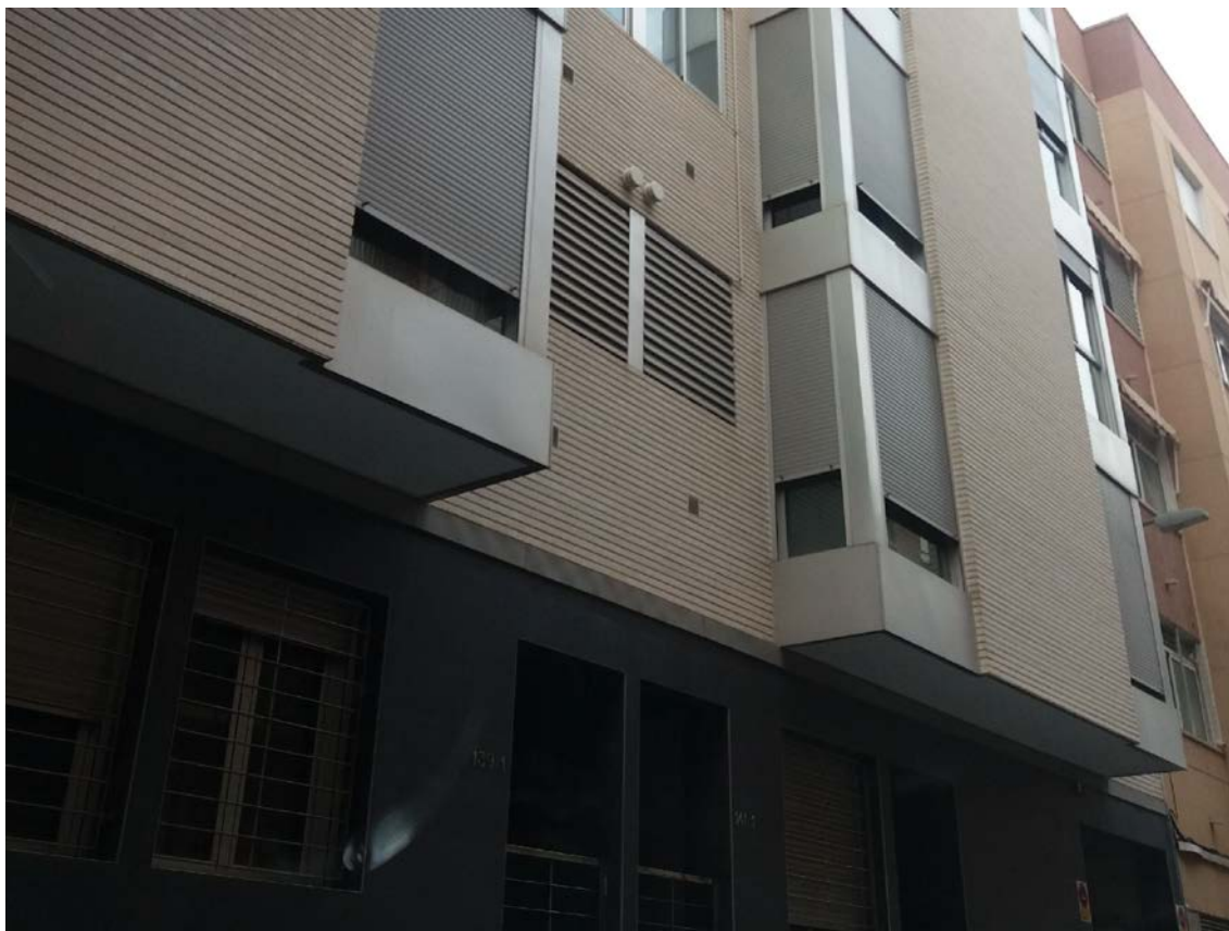
Cableado integrado en caja de instalaciones gris anclada a la fachada.
