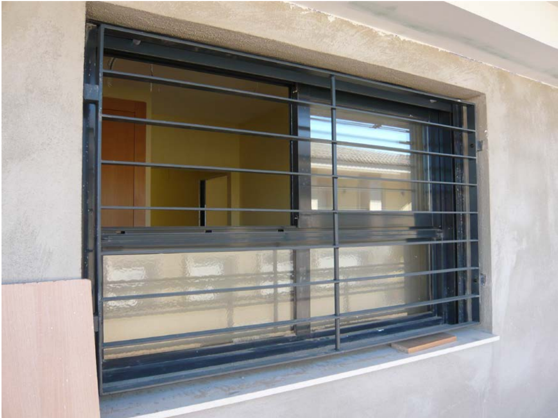
Huecos en fachada.
