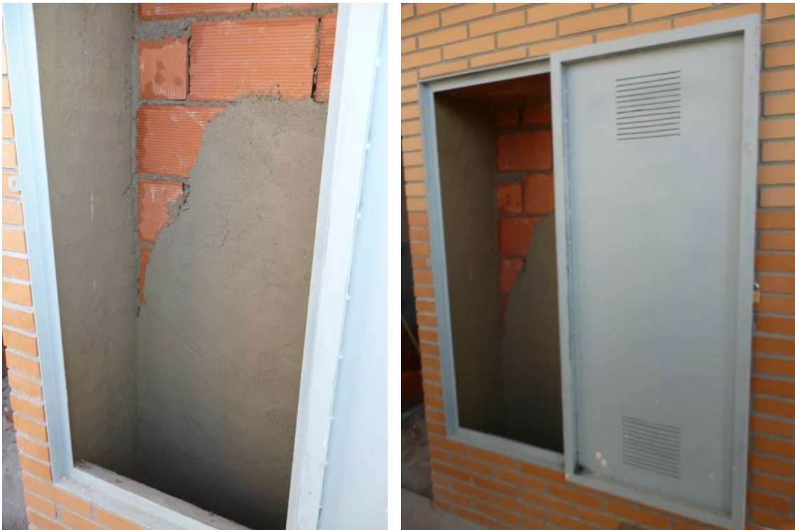
Armario de acometida de la red de abastecimiento de agua potable en construcción.
