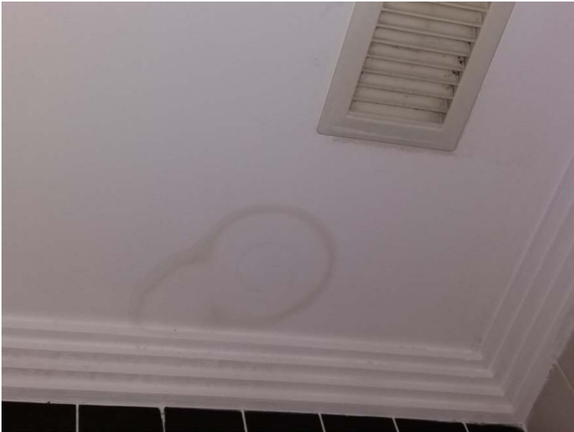
Filtraciones procedentes de núcleos húmedos afectando a falsos techos.
