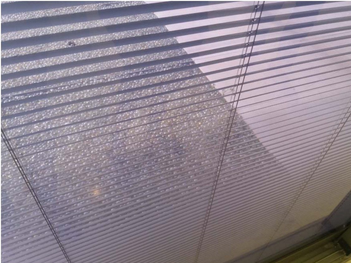
Cubierta plana no transitable con acabado de esferas de vidrio, MACA, Alicante.
