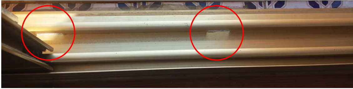
Orificios de salida del agua en marco de ventana corredera.
