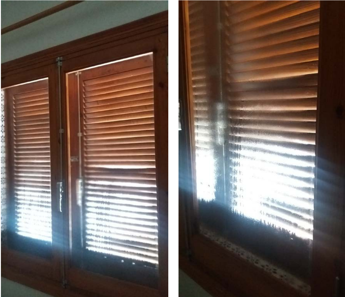
Condensación del vapor de agua en carpinterías de acristalamiento sencillo.
