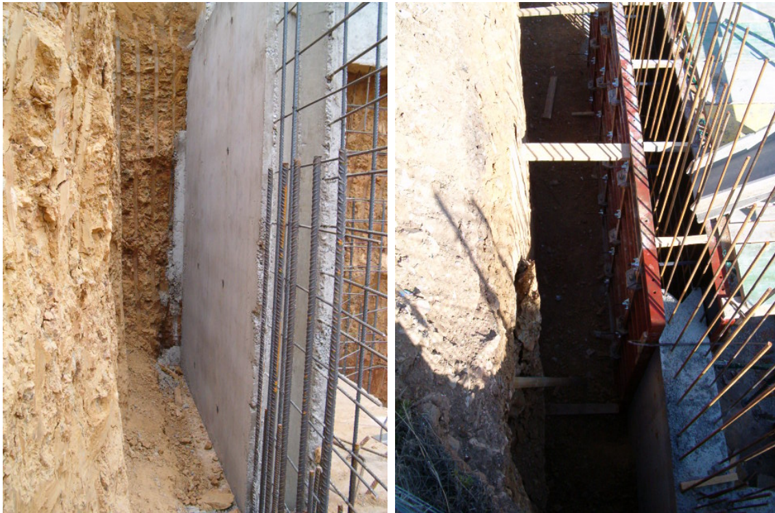
Disposición y atado de las armaduras del alzado del muro, encofrado y hormigonado.
