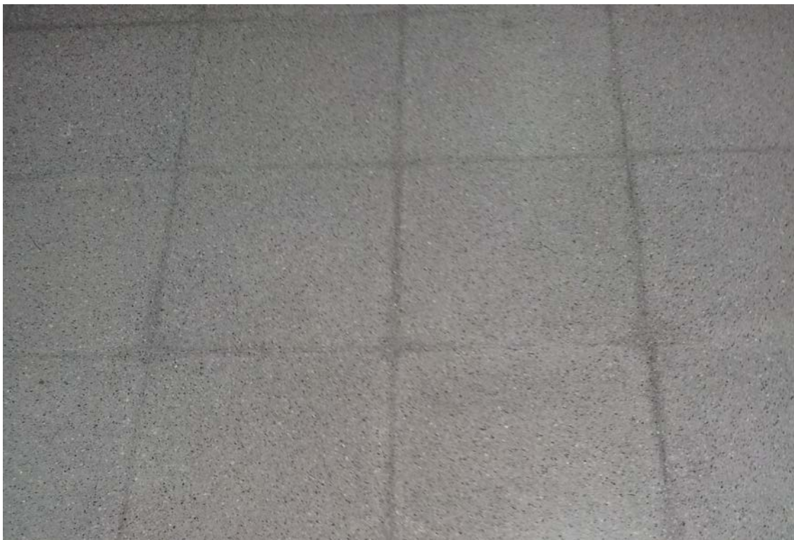
Humedad en pavimento de terrazo marcada en las juntas de las piezas.
