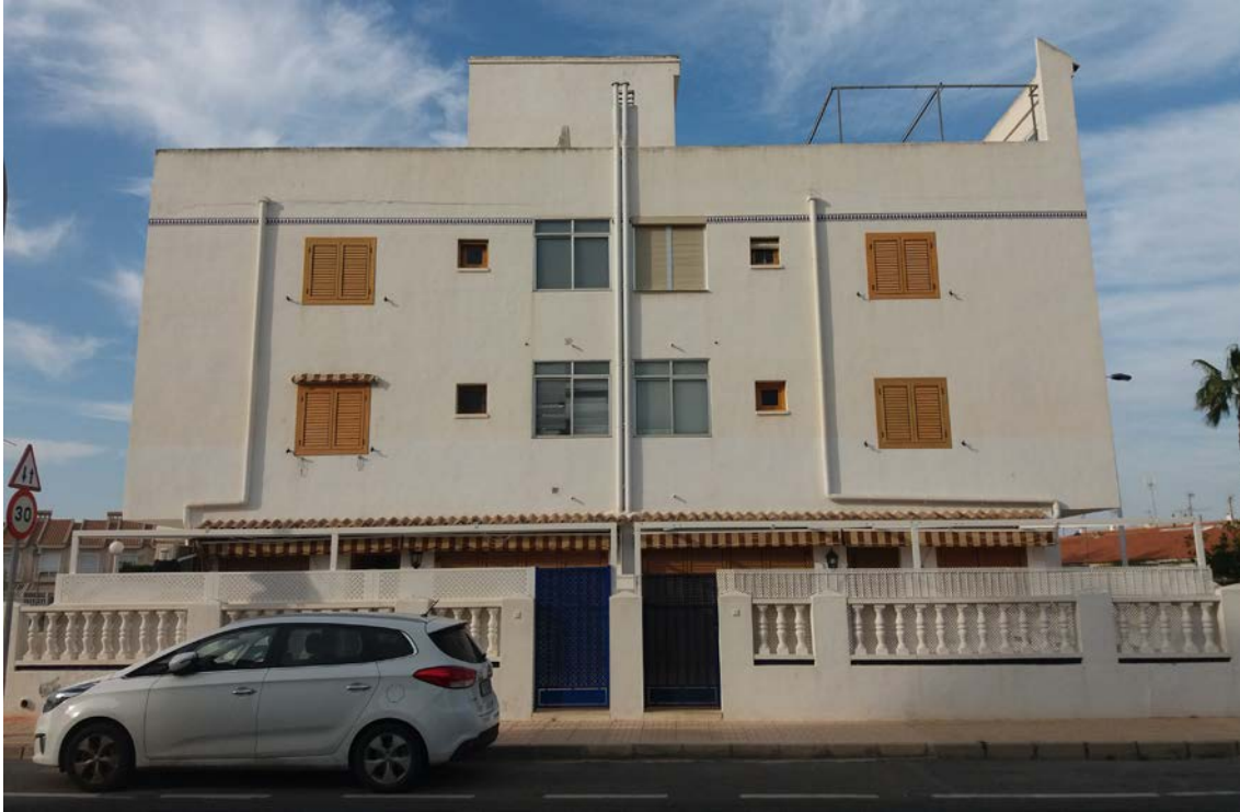
Instalación de saneamiento vista en fachada a la vía pública.
