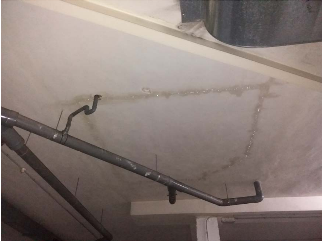
Filtraciones procedentes de patios interiores.
