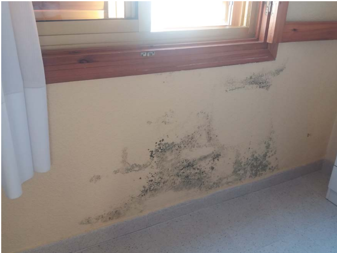
Filtraciones procedentes de ventanas.
