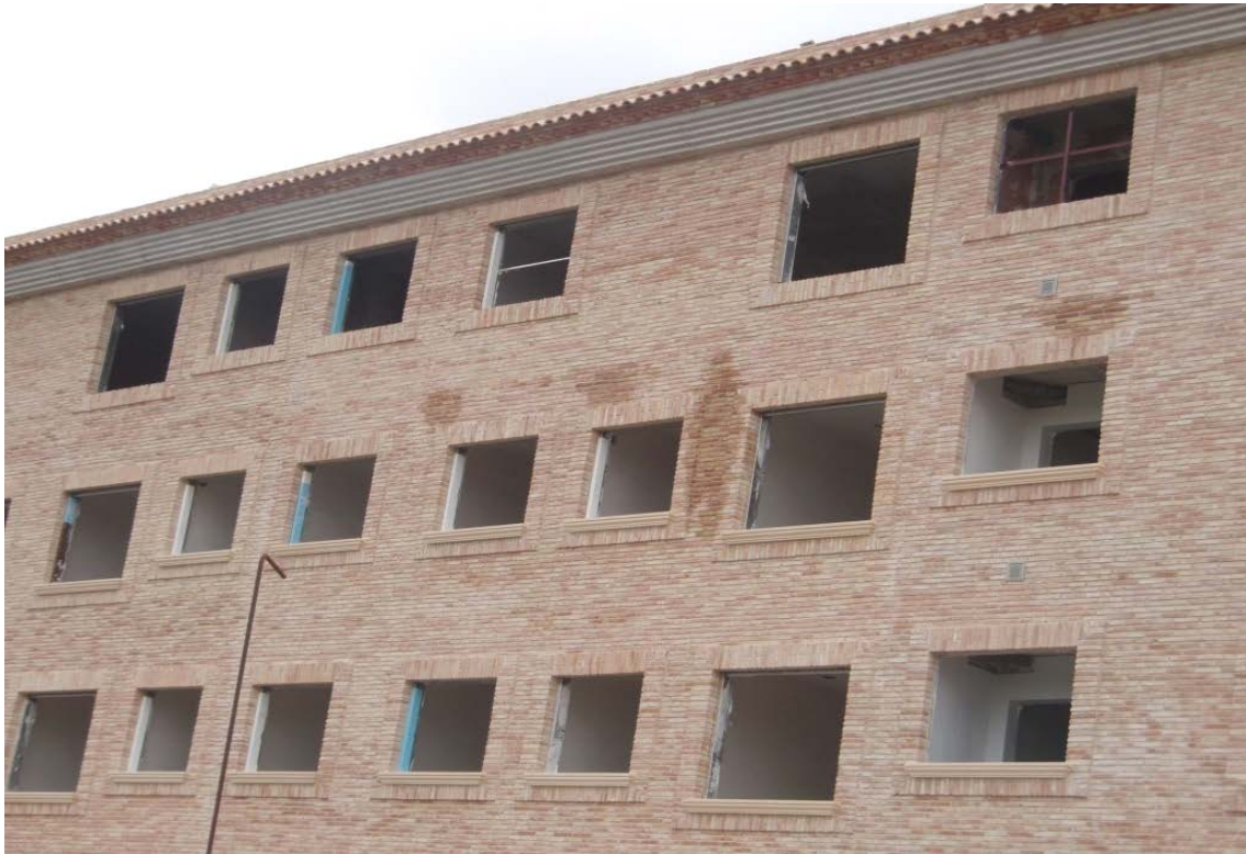
Humedad en cerramiento de fachada.
