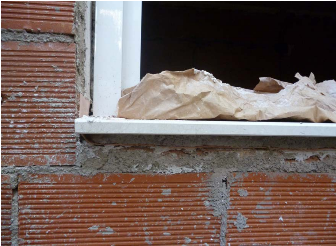
Disposición de lámina impermeable en la parte inferior del vierteaguas de ventana.
