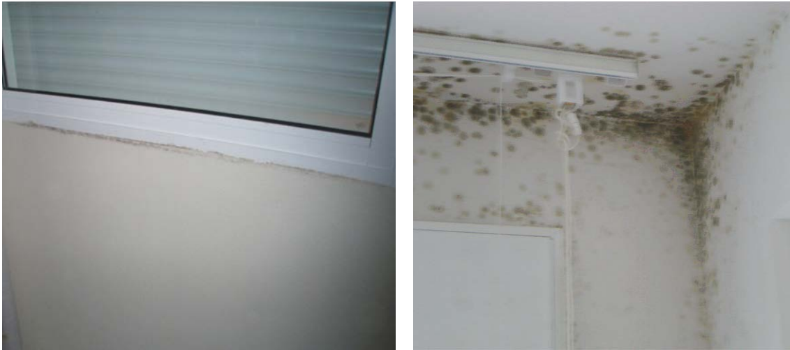
Lesiones debidas a la condensación del vapor de agua en las superficies.
