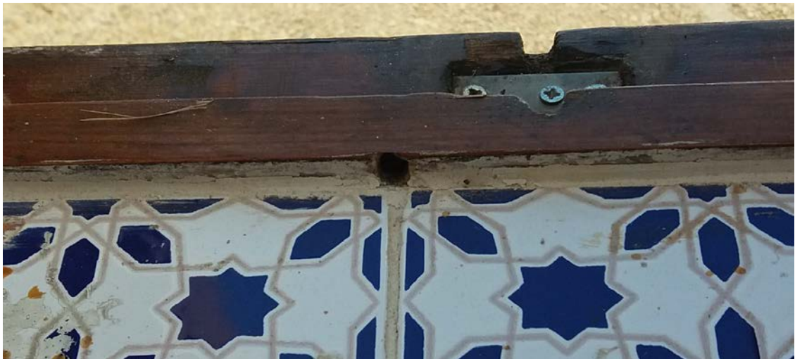
Orificios de salida del agua en marco de ventana y en contraventana.
