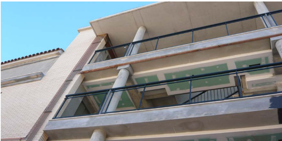
Instalación de gas canalizado vista en fachada a patio de manzana.
