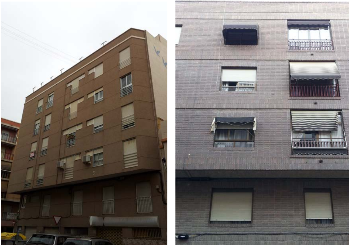
Cableado no integrado en la fachada.
