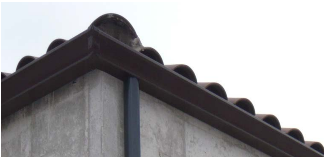
Canalón exterior en cubierta inclinada con teja cerámica,
