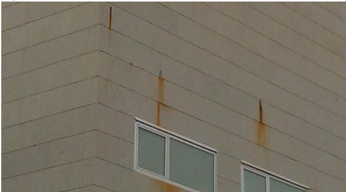
Manchas de óxido en las placas metálicas por oxidación de los anclajes metálicos de la fachada.
