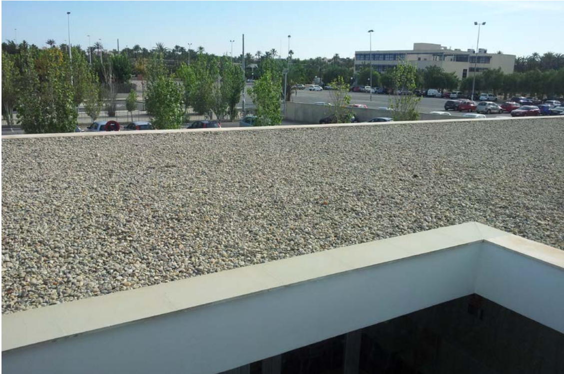
Acabado de cubierta plana no transitable con grava. Escuela Oficial de Idiomas de Elche.
