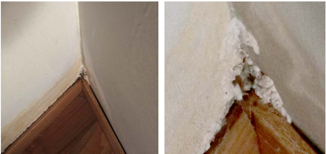
Filtraciones procedentes de núcleos húmedos afectando a revestimientos de paredes y pavimentos.
