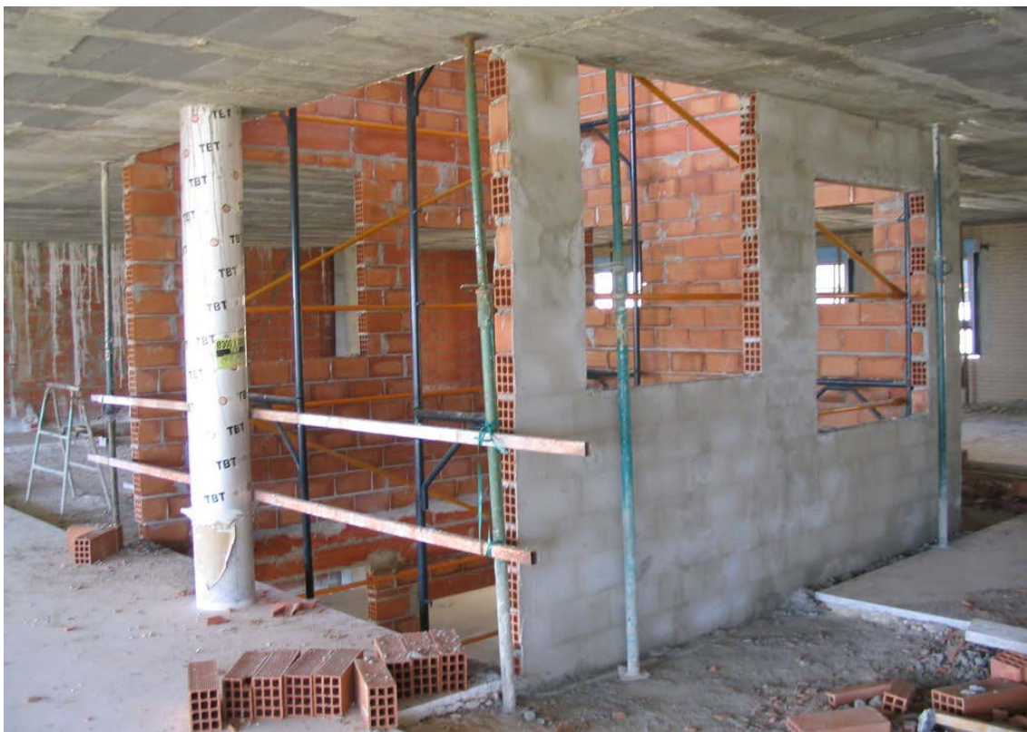
Revestimiento interior de la hoja exterior del cerramiento de fachada, enfoscado de mortero de cemento a buenavista.
