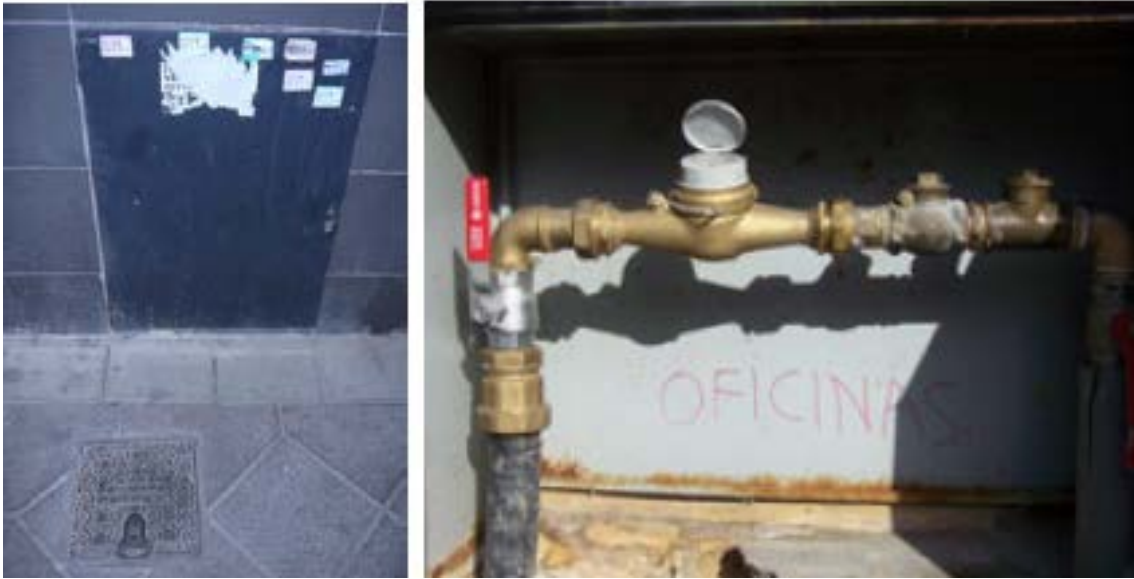
Armario de acometida de la red de abastecimiento de agua potable en servicio.
