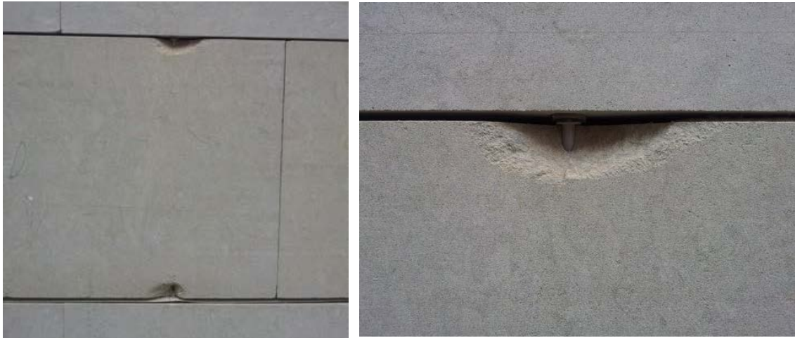
Rotura del aplacado por efecto cuña.
