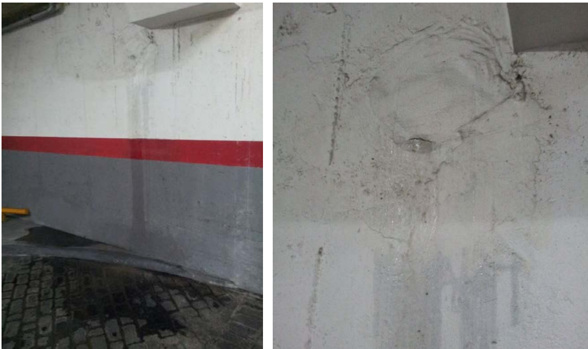
Filtraciones procedentes de muros de sótano.
