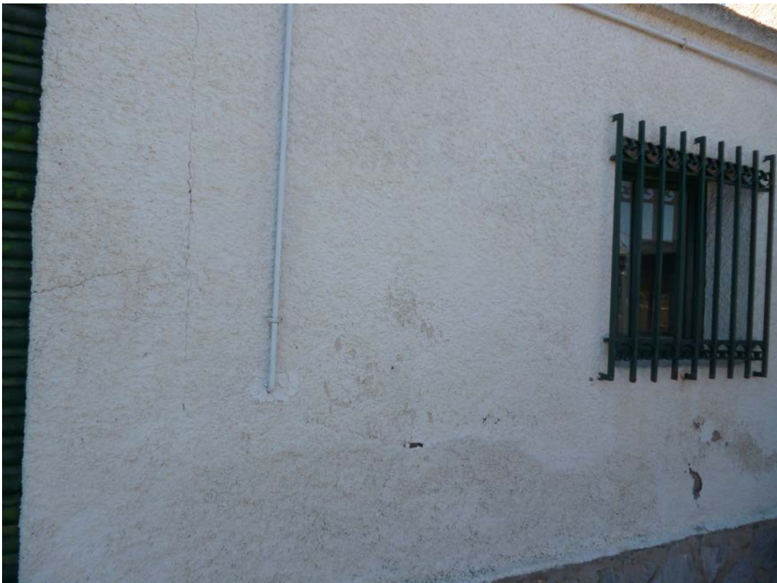
Humedad por capilaridad en cerramiento de fachada debida a la cercanía de cámaras sanitarias (pozos ciegos).
