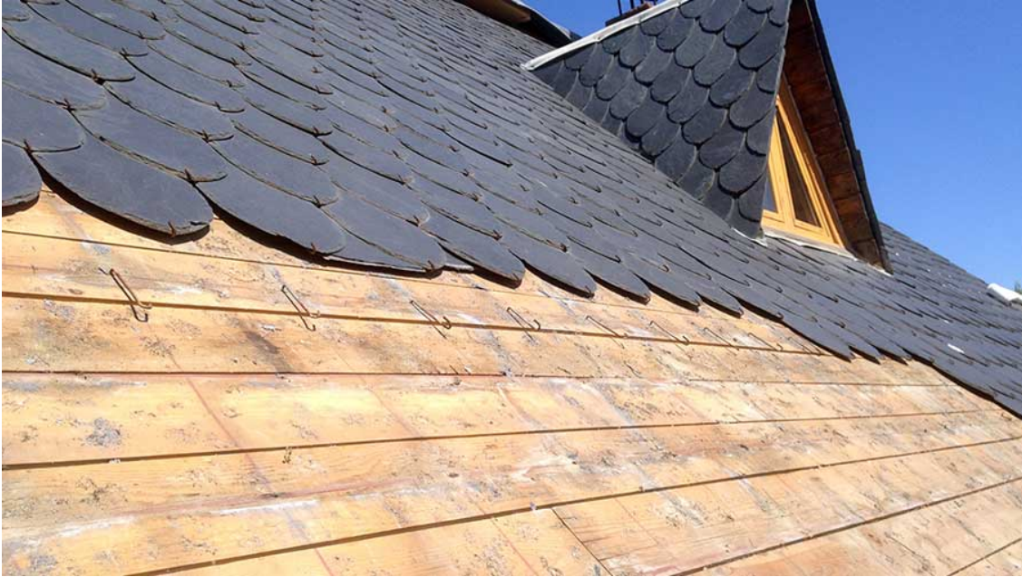
Faldón de cubierta inclinada acabado con teja de pizarra. Fuente: <aistercel.es> [Consulta: 20 de mayo de 2018].
