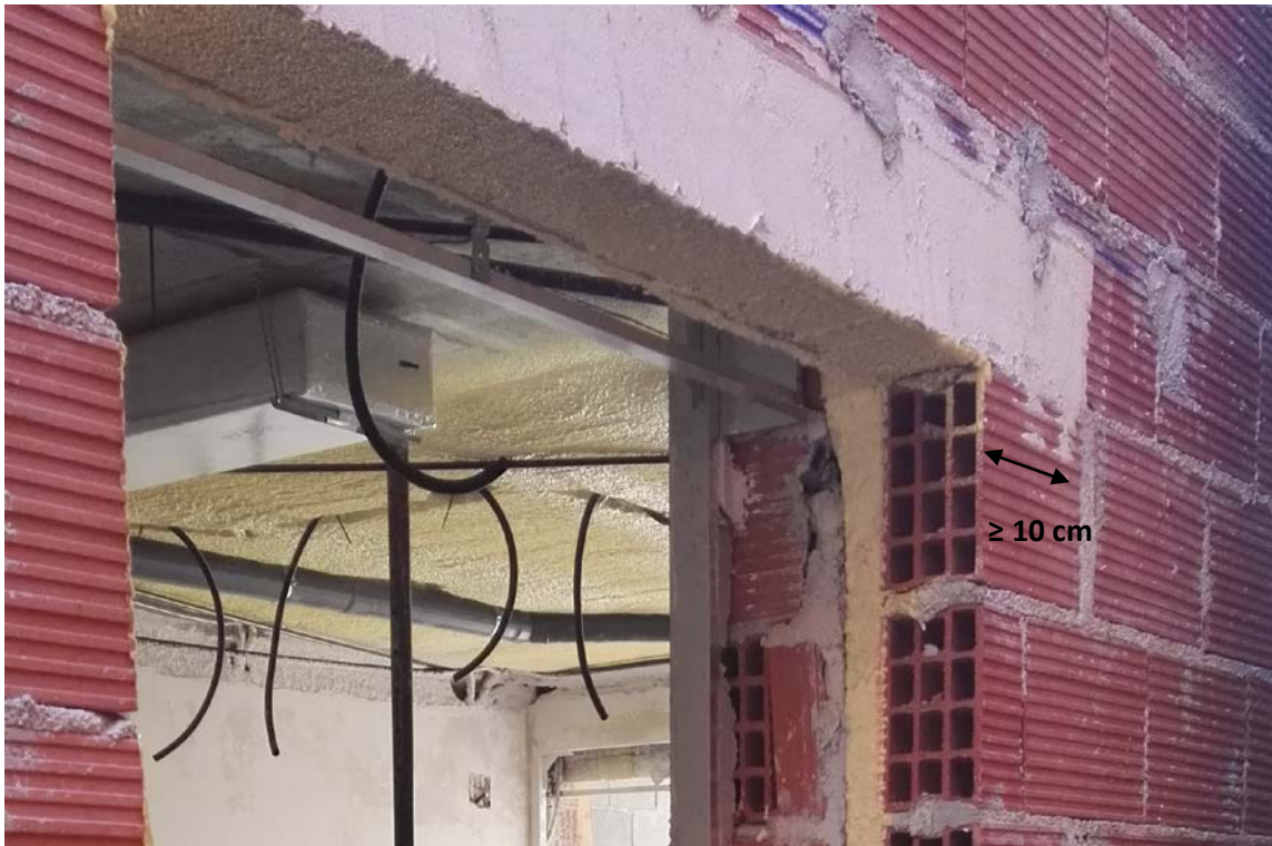
Apoyo de cargadero de hormigón en los paños de fábrica de ladrillo contiguos.
