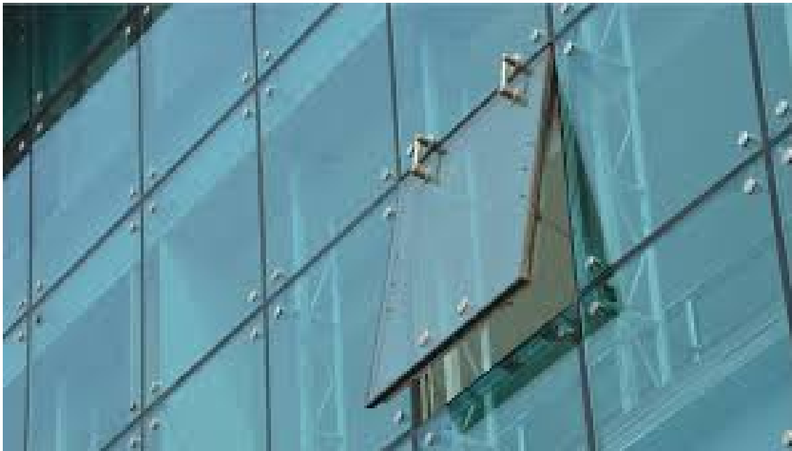
Vidrio practicable en muro cortina con sistema de araña. Fuente: < www.constructorabg.wixsite.com > [Consulta: 21 de septiembre de 2020].
