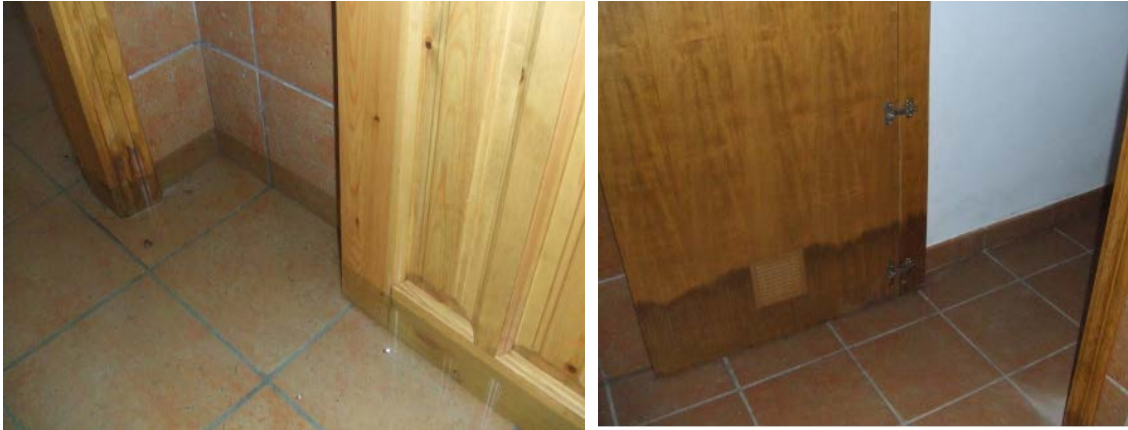
Humedad por capilaridad debida a inundaciones.
