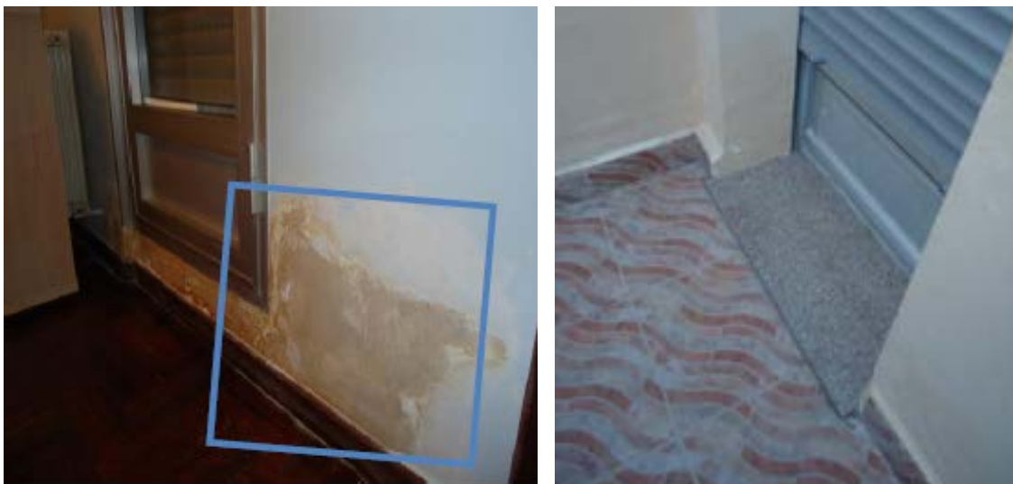
Humedad por capilaridad en cerramiento de fachada debida al estancamiento de agua en plataformas horizontales.
