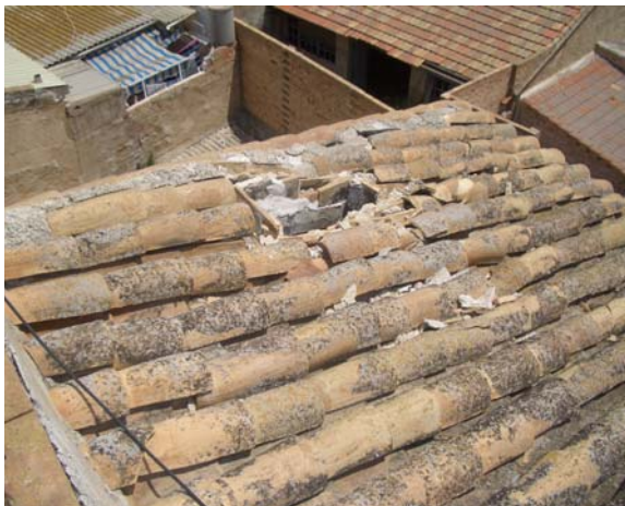
Figura 7. Daños que originan filtraciones de agua.
