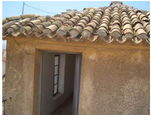
Figura 8. Deterioro de la cubierta del torreón.
