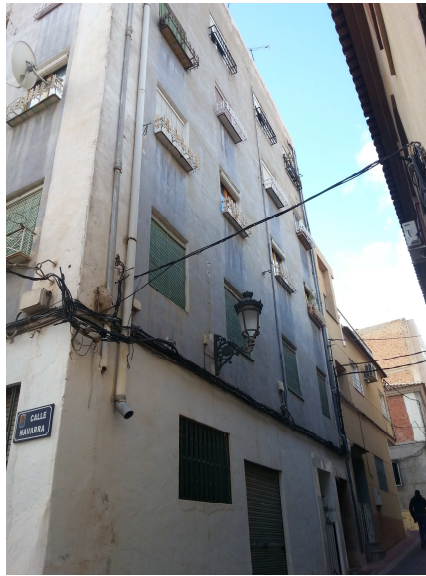
Fotografía 2: Deterioro extremo de fachada Noreste
