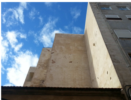
Fotografía 5: Deterioro de las medianeras
