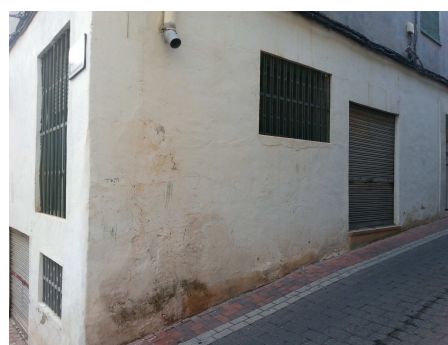
Fotografía 6: Humedades en el arranque de fachada
