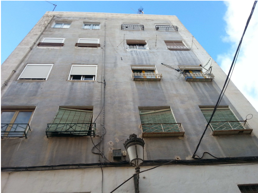
Fotografía 1: Deterioro extremo de fachada Sureste
