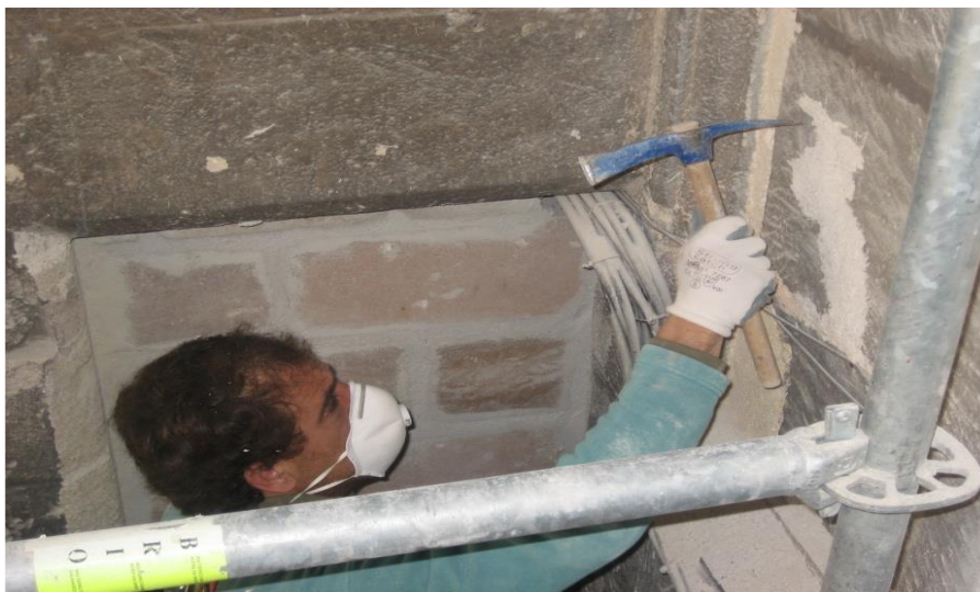
Figura 9.4. Catedral de Sevilla. Picado de fachada. Sevilla. Fuente: el autor
