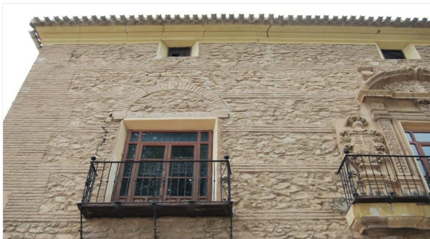
Figura 8.1. Grietas y fisuras Terremoto Lorca 2011. Fuente: el autor
