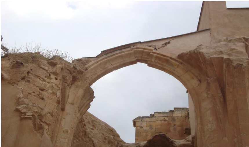
Figura 10.5. Daños del terremoto 2011 en clave del arco. Fuente: el autor
