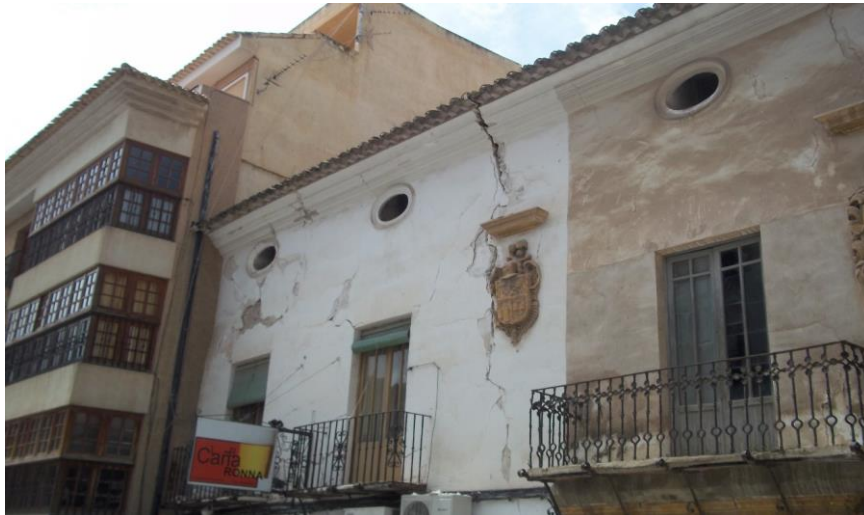
Figura 7.4. Estado de las medianeras. Terremoto Lorca. Fuente: el autor
