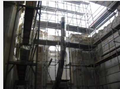
Iglesia Santiago. Andamio interior y trompa de vertido a contenedor de materiales. Lorca. Fuente: Autor
