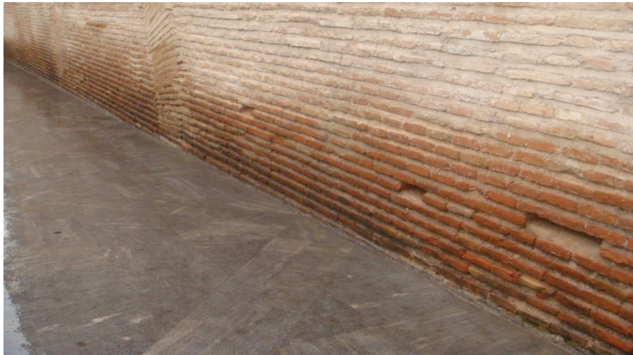
Figura 8.5. Humedad por capilaridad. San Esteban. Murcia. Fuente: el autor
