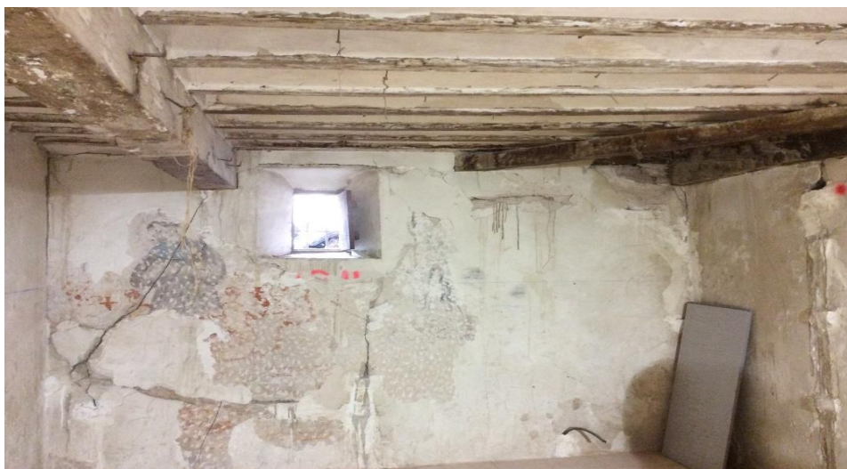
Figura 9.1. Patología en forjados. Iglesia San Francisco. Lorca. Fuente: el autor
