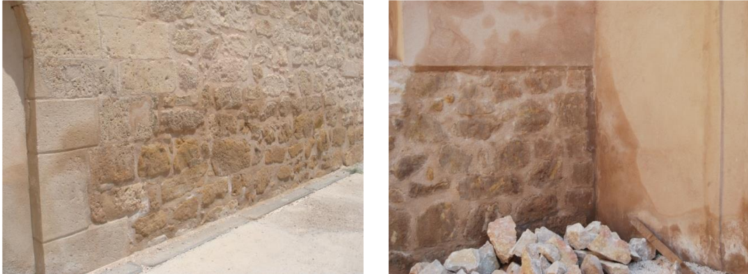
Figura 10.10. Humedades muro exterior y muro interior. Fuente: el autor
