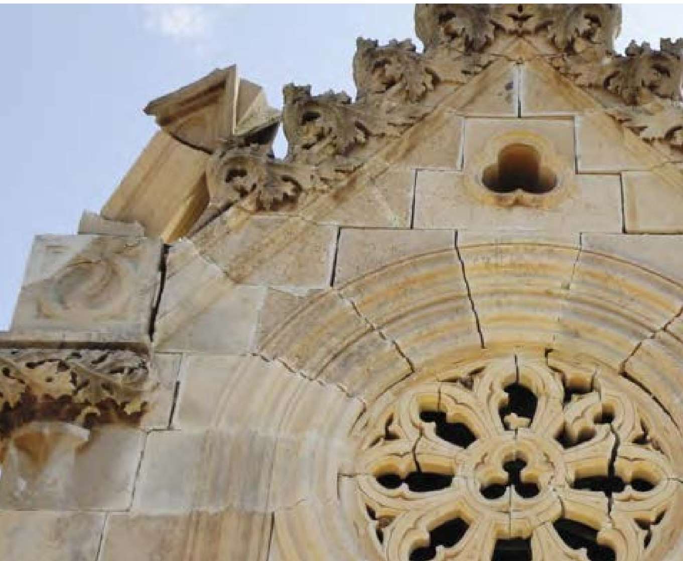
Figura 208. Detalle de daños y situación de sillares en peligro de derrumbe en panteón de Adela Cachá Arcoya, 1919. Cementerio de San Clemente, Lorca (Murcia). Fuente: Jerónimo Granados González.
