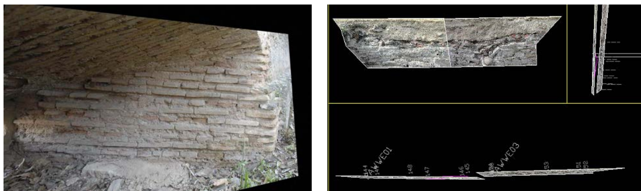
Figura 064 (izquierda) y figura 065 (derecha). Rectificación fotográfica por ASRix. Imágenes en alzado y perspectiva dentro de CAD de izquierda a derecha respectivamente. Restauración del Baluarte hacia la Torre de la Vela en la Alhambra, Granada. Fuente: Autor.
