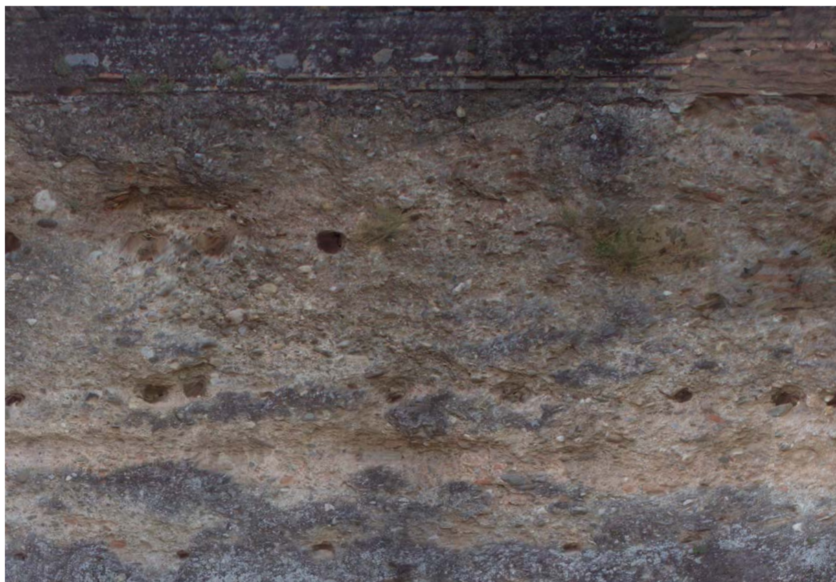
Figura 172 (inferior). Ortofotografía fotorealística en detalle con valor métrico de la zona afectada por pérdida de material/sección. Planimetría general del Baluarte de la Alcazaba.
