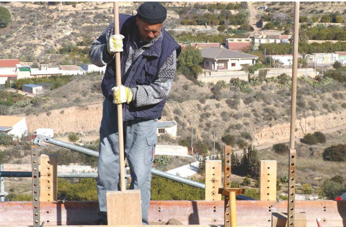
Figura 191. Empleo de técnicas tradicionales. Ejecución de un muro de tapial. Castillo de Alhama, Murcia. Fuente: Francisco Javier López Martínez.
