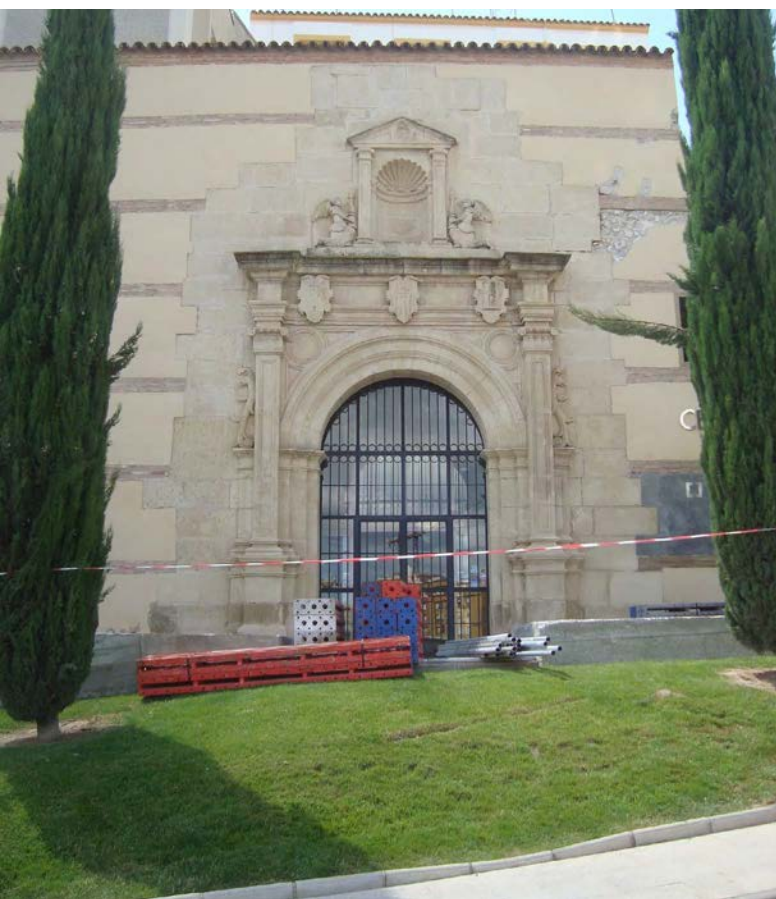
Figura 083 (superior izquierda), figura 084 (inferior izquierda), figura 085 (superior derecha) y figura 086 (inferior derecha). Respectivamente: Apuntalado de seguridad por desprendimiento y derribo. Vistas frontal y lateral. Portada principal antiguo Convento de la Merced, actual Centro de Visitantes de Lorca (Murcia). Fuente: Autor.
