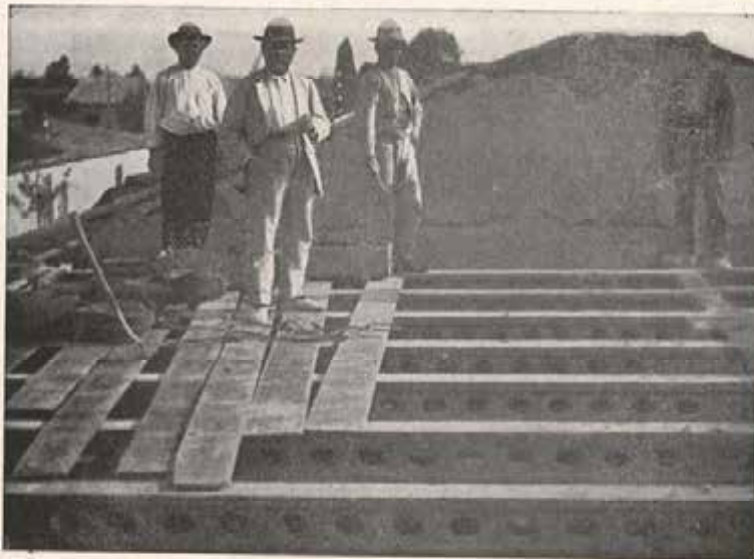
Vista de las vigas empleadas en el edificio que figura en la lámina anterior preparadas para la ejecución de bovedillas de ladrillo.
