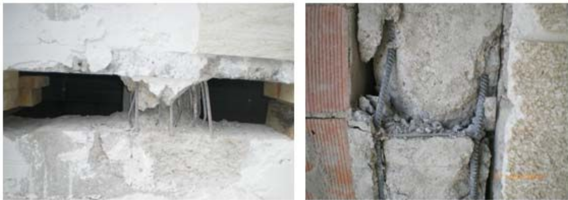
Figura 1. Daños localizados en pilares. (Fuente: Los autores).
