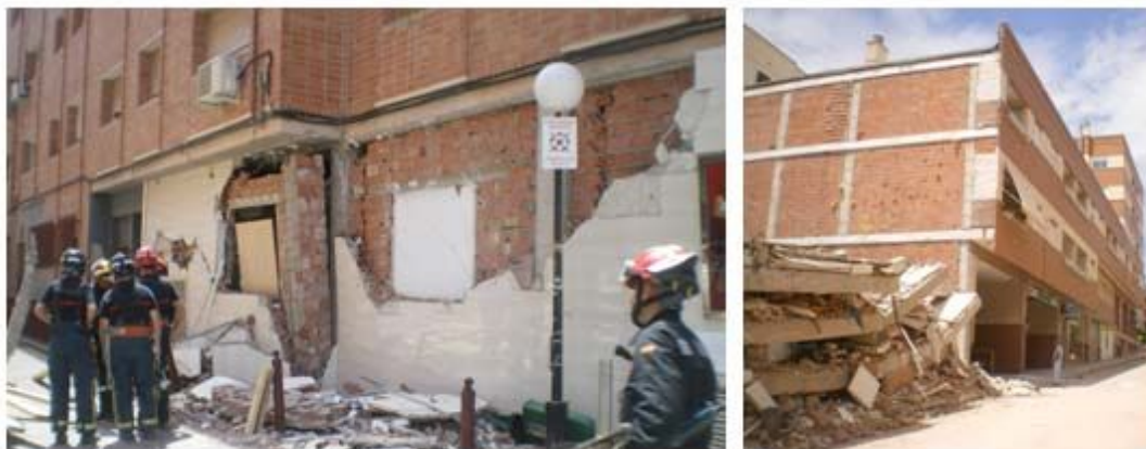
Figura 2. Daños provocados en fachada (Izquierda). Colapso de una estructura (Derecha). (Fuente: Los autores).
