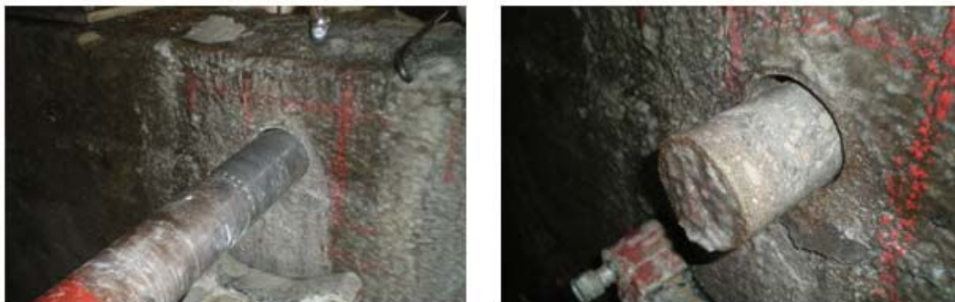
Figura 4. Proceso de extracción de una probeta testigo de hormigón, tras la realización del ensayo mediante ultrasonidos. (Fuente: Los autores).
