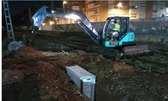
Figura 0.4 Empleo de una miniexcavadora para la ejecución de la zanja y manipulación de los bloques. Fuente: Elaboración propia.
