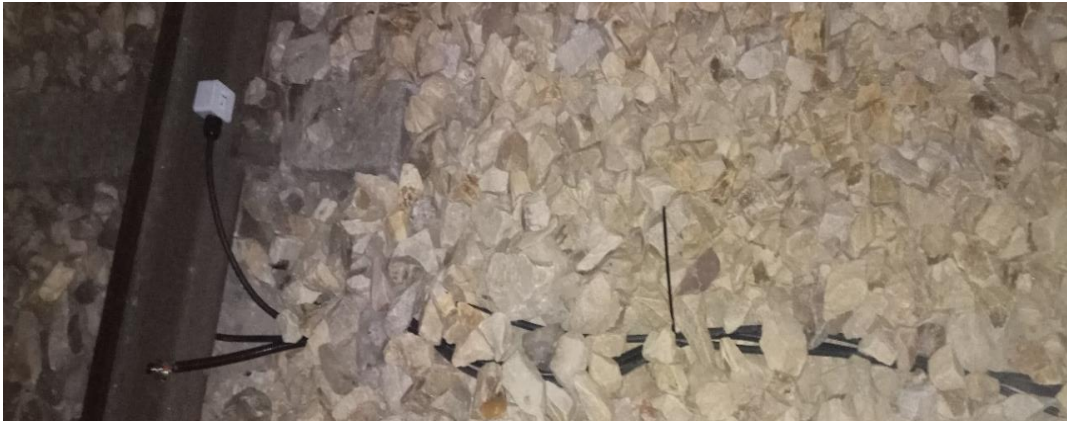
Figura 0.13 Disposición de tubos de plástico corrugado como envoltente de los cables de los sensores para protección de cortes, impactos y humedad. Fuente: Elaboración propia.
