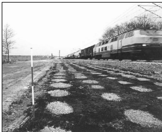
Figura 0.28. Mejora de las propiedades del terreno sobre el que se emplaza la vía mediante columnas de grava. Fuente: (107)
